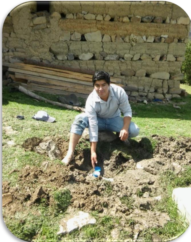
Fotografía 5: Medidor de agua doméstico N° 03 instalado por el tesista
