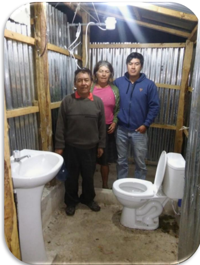
Fotografía 13: Vista interior de SS-HH con arrastre hidráulico en vivienda N° 01
