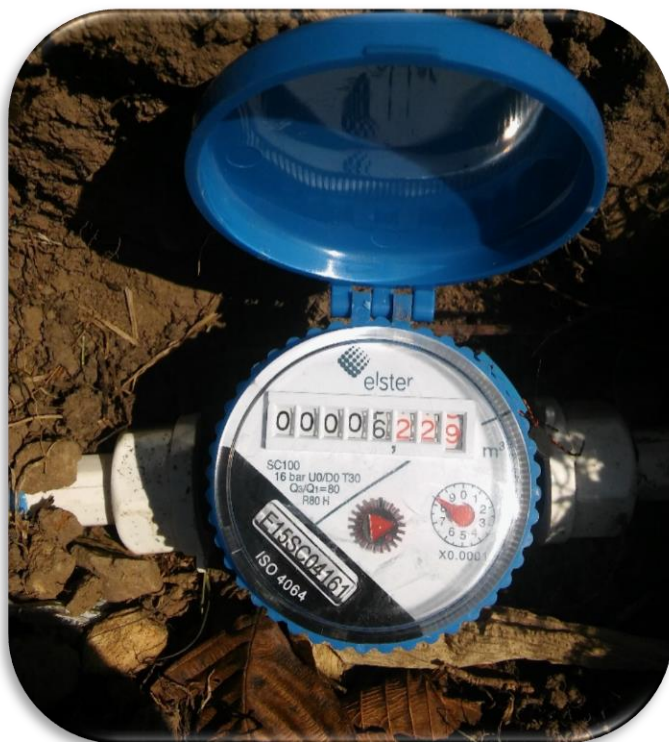
Fotografía 11: Lectura de consumo en el medidor N° 04 y en una hora diurna
