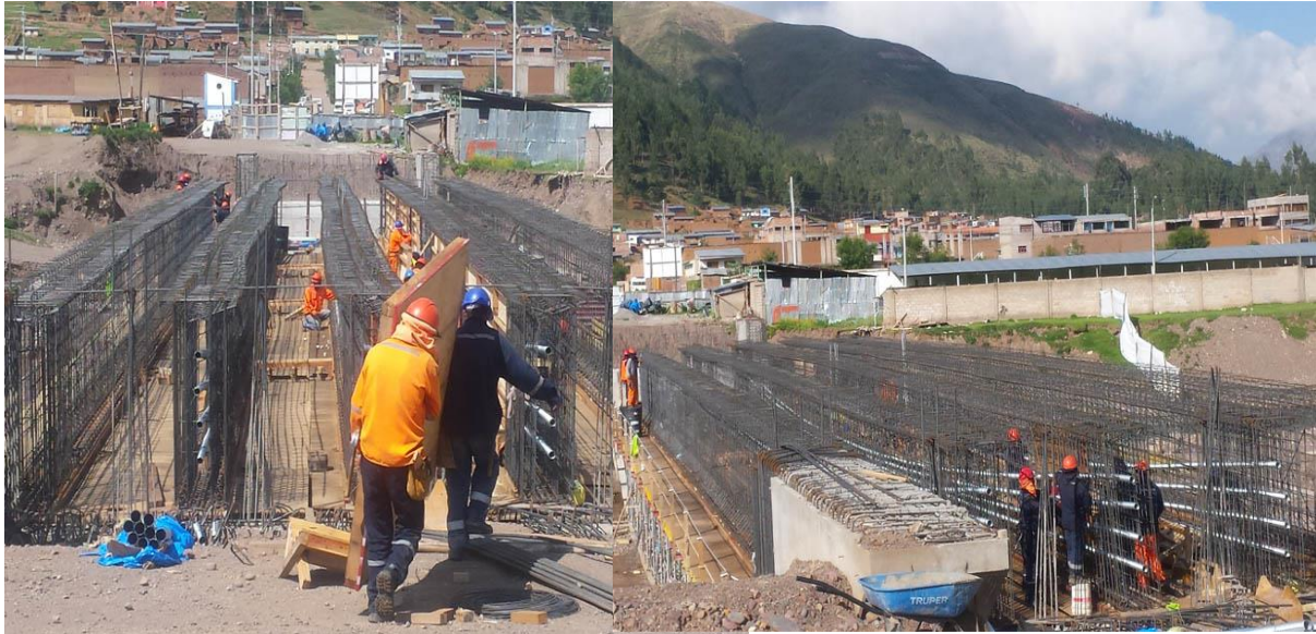
Figura 2.12 Postensado de vigas tipo cajón, Puente Independencia, Piura (Tomado de Samayca Ingenieros SAC).
