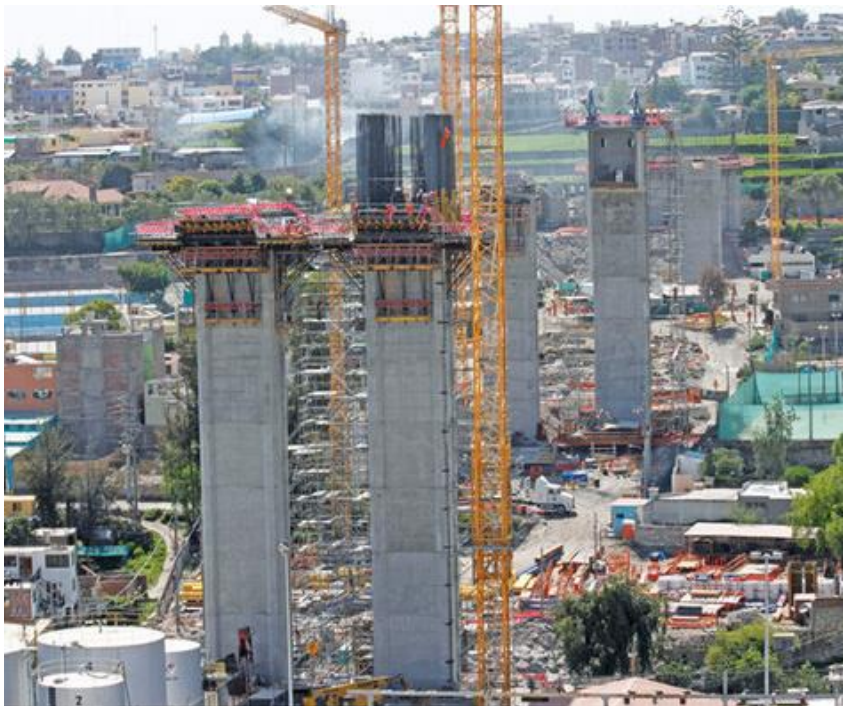
Figura 2.17 Construcción de Puenete Chilina, Arequipa por dovelas sucesivas. Longitud 562m (Tomado de Catálogo ULMA).
