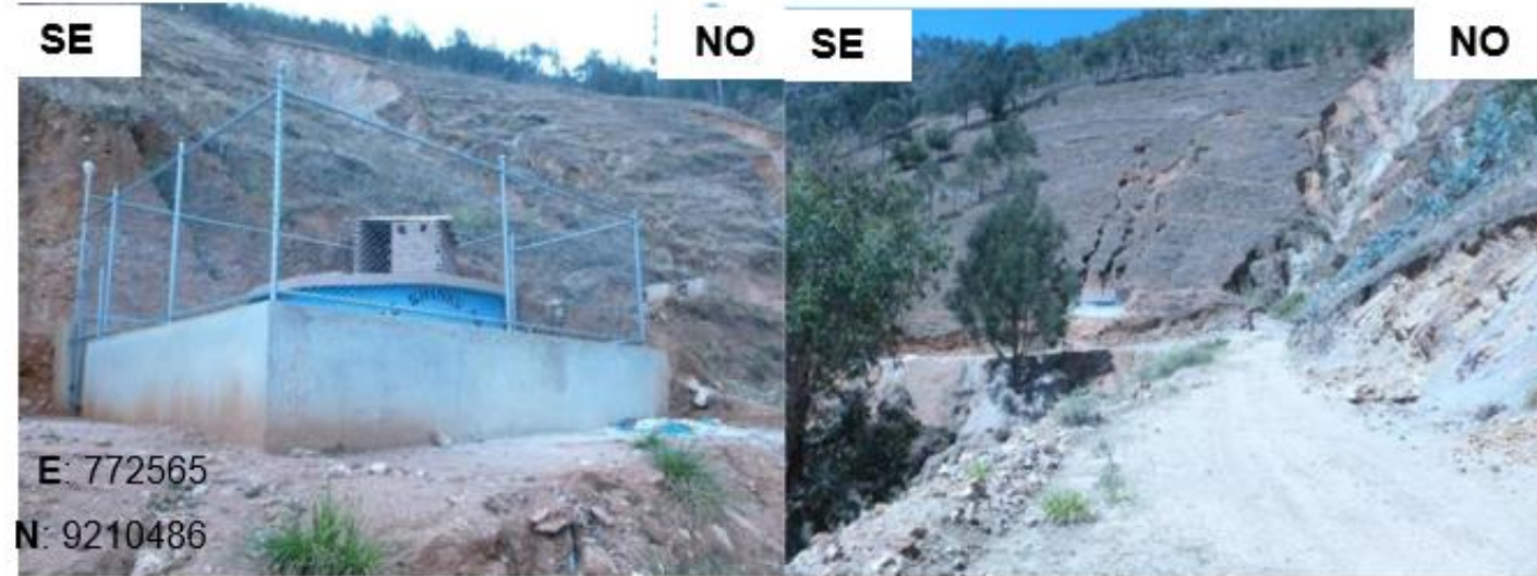
Figura 22. Reservorio Mayopata ubicado en la margen derecha de la quebrada Mayopata, cauce alto.
