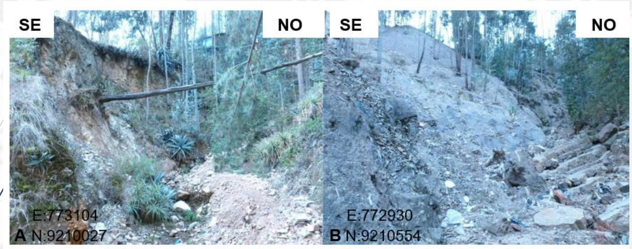
Figura 18. Degradación del terreno debido a la erosión hídrica en el cauce medio de la quebrada Parapuquio (A) y en el cauce medio de la quebrada Hualanga (B).
