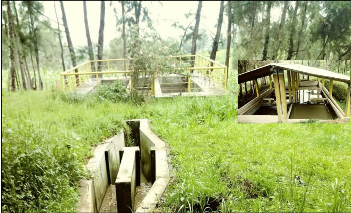
Figura 16. Planta de tratamiento de aguas servidas del centro urbano Venecia.
