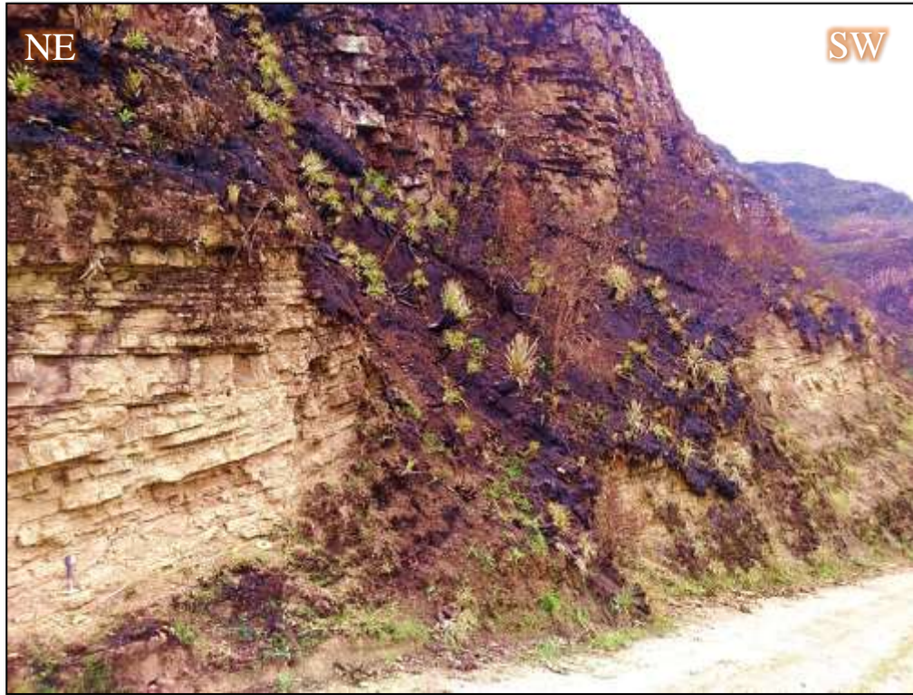
Foto N° 15. Talud de la Estación N° 5, formada por areniscas de la Formación Farrat.
