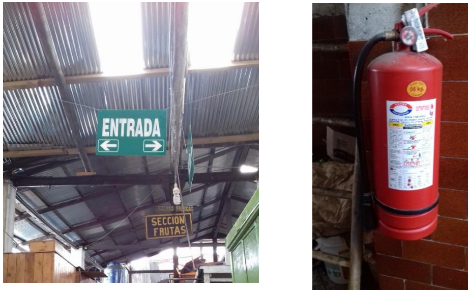
Figura 25: Señalética y extintores en el Mercado Central de Cajamarca.
