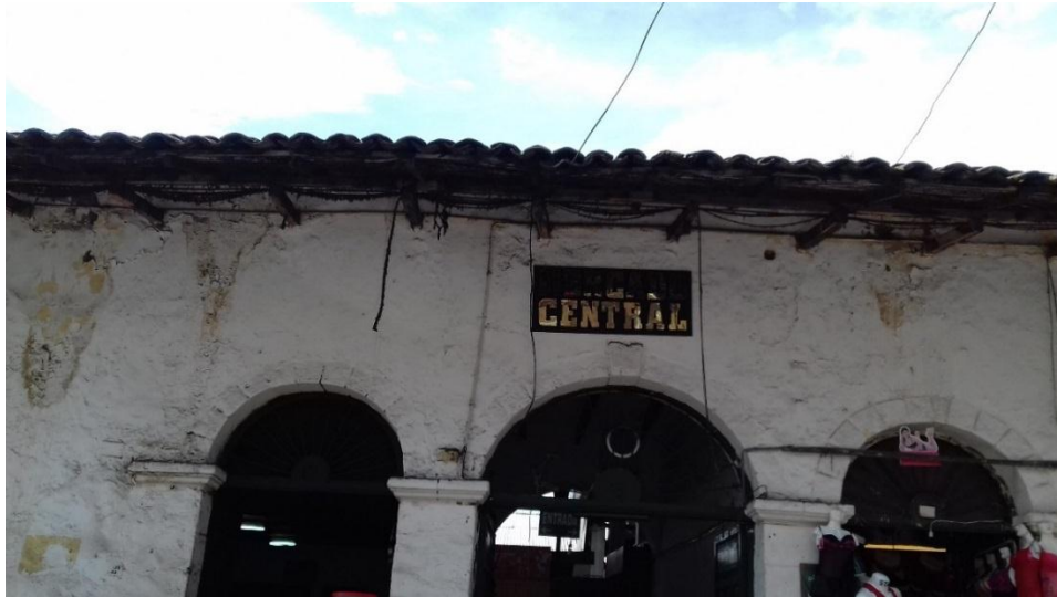
Figura 17: Mal estado del cableado de energía eléctrica.
