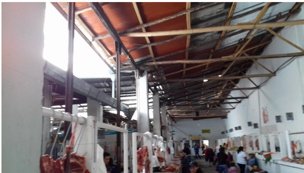
Figura 22: Inadecuado techo del Mercado Central de Cajamarca.
