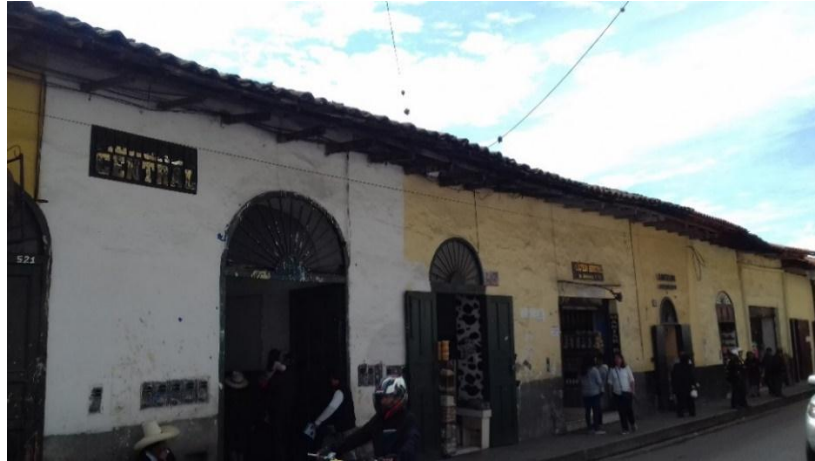
Figura 23: Paredes de adobe en estado de deterioro.
