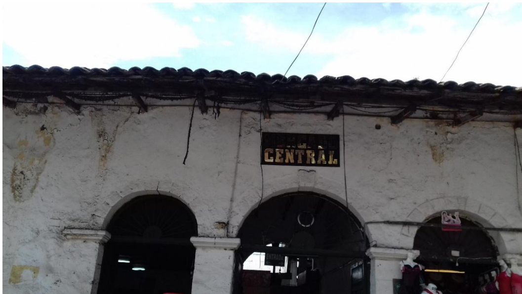
Figura 20: Conductores eléctricos externos en mal estado.
