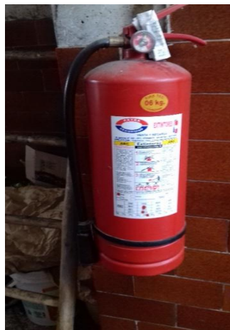
Figura 18: Extintores ubicados en las puertas de acceso del Mercado Central de Cajamarca.
