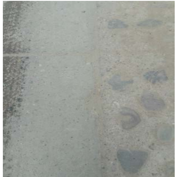
Fotografía 66: Descascaramiento de junta de severidad baja.
