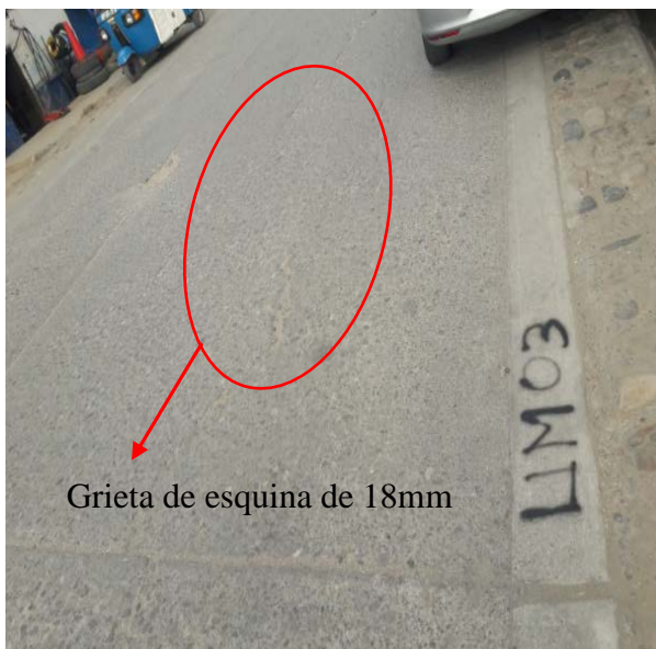
Fotografía 7: Grieta de severidad media.
