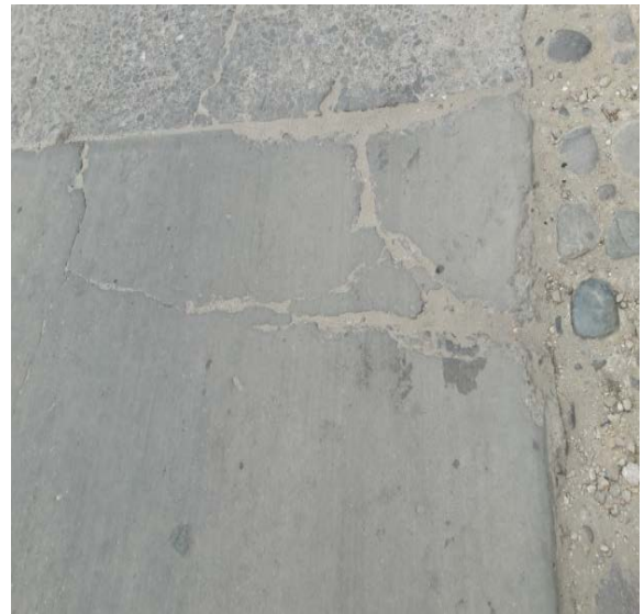
Fotografía 18: Descascaramiento de esquina.
