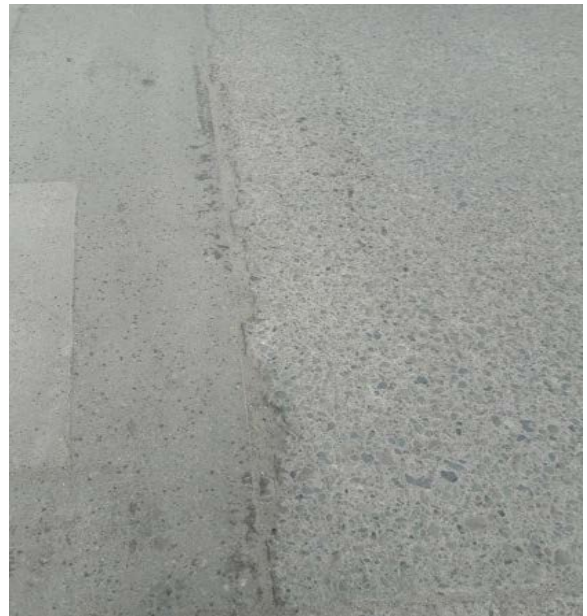
Fotografía 64: Descascaramiento de junta de severidad baja.
