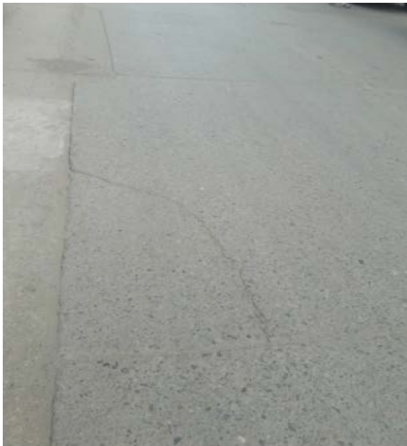
Fotografía 71: Grieta de esquina de severidad baja.
