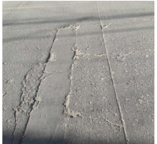
Fotografía 12: Parche grande deteriorado de severidad media.
