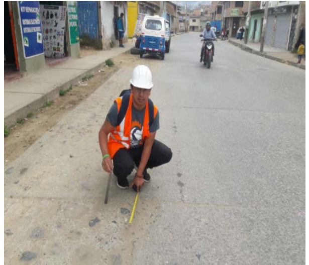
Fotografía 26: Descascaramiento de esquina.
