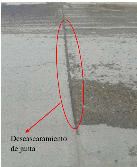
Fotografía 39: Descascaramiento de junta de severidad baja.
