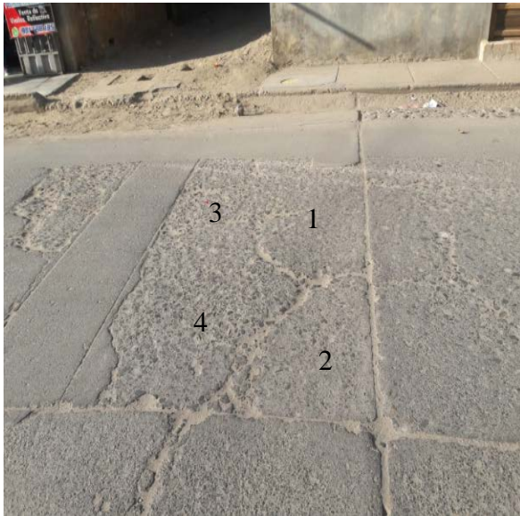
Fotografía 13: Grietas en bloque de severidad baja.
