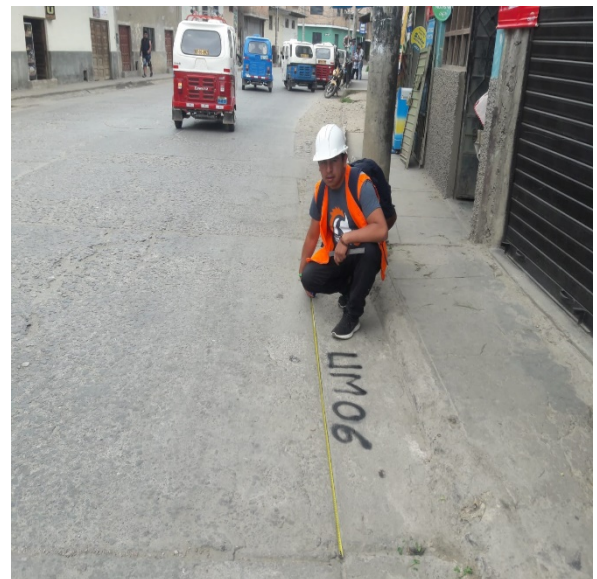
Fotografía 14: Junta deteriorada de severidad baja.
