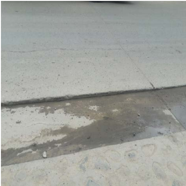
Fotografía 53: Desnivel carril berma de severidad baja.
