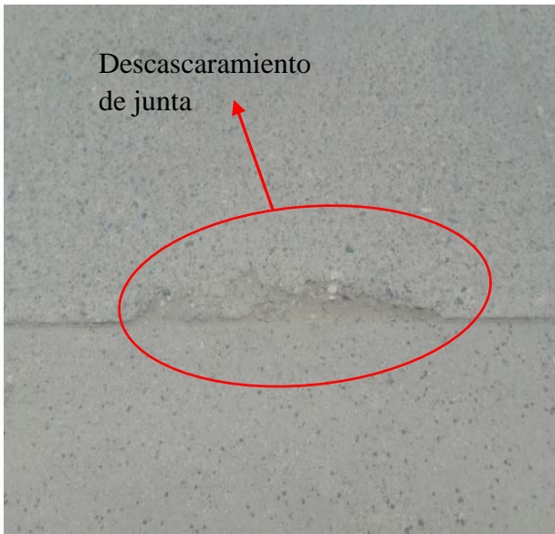
Fotografía 49: Descascaramiento de junta de severidad media.
