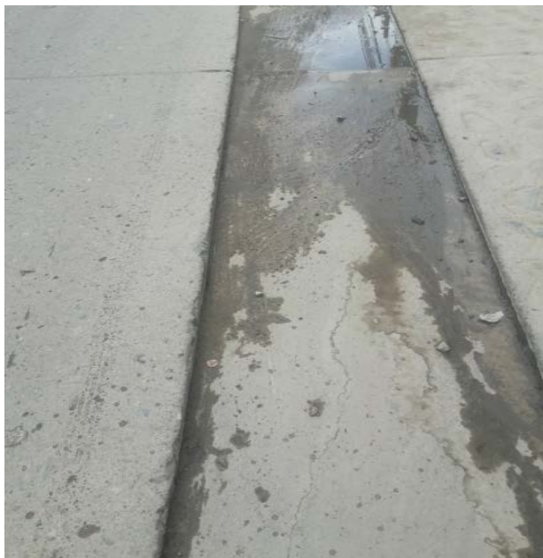
Fotografía 47: Desnivel carril berma severidad media.
