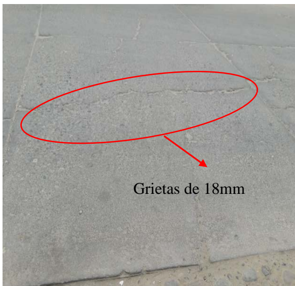
Fotografía 15: Grietas longitudinal de severidad media
