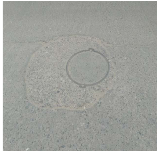
Fotografía 50: Parche grande deteriorado de severidad media.
