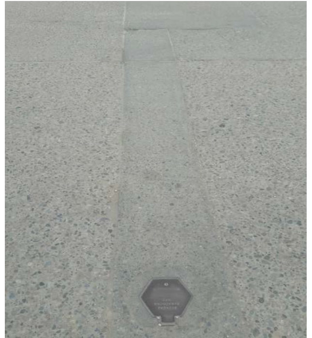
Fotografía 46: Parche grande deteriorado de severidad baja.
