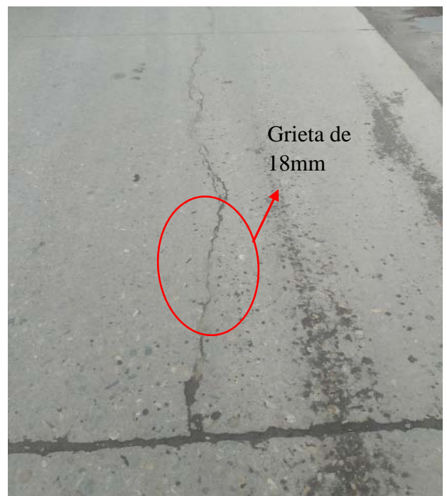
Fotografía 40: Grietas de severidad media.
