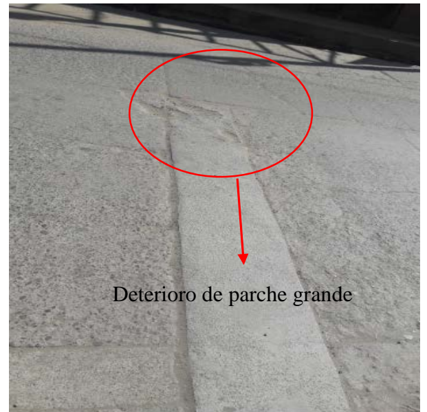
Fotografía 4: Parche grande deteriorado de severidad baja.
