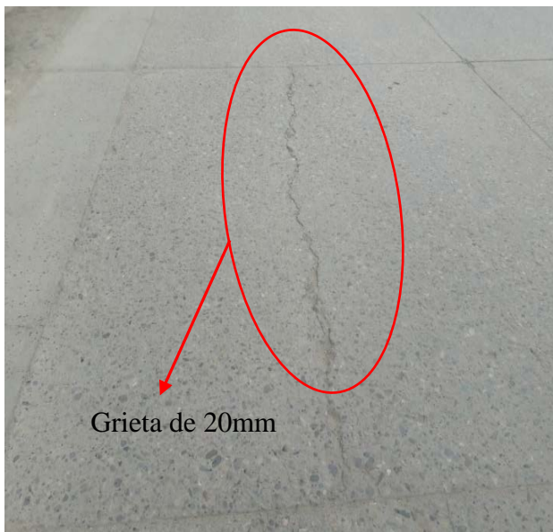
Fotografía 51: Grieta de severidad media.
