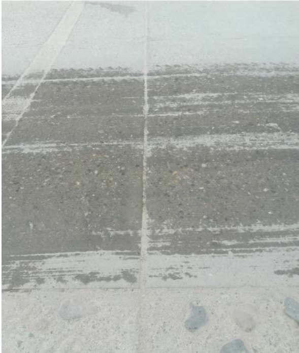
Fotografía 45: Parche pequeño deteriorado de severidad baja.
