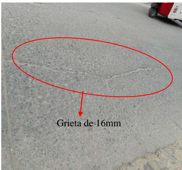
Fotografía 19: Grieta longitudinal de severidad media.
