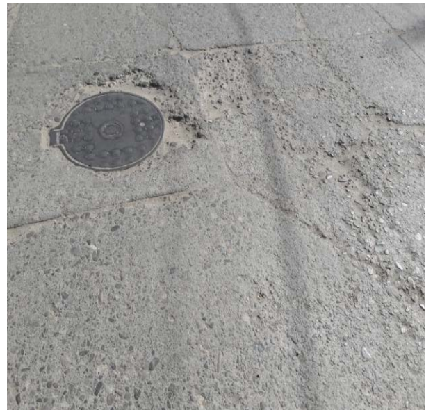
Fotografía 6: Hundimiento de severidad baja.
