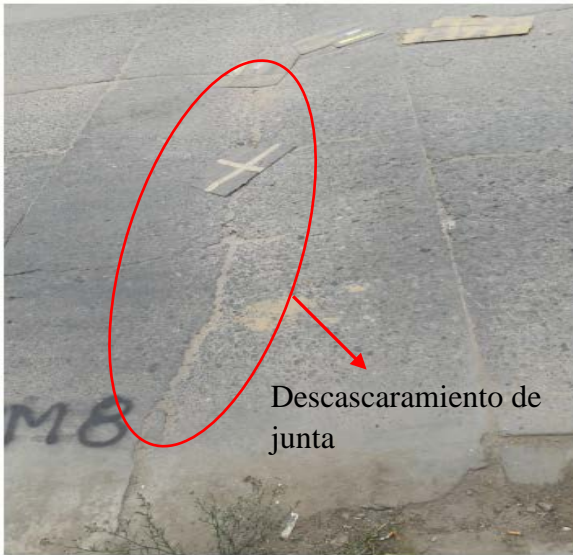
Fotografía 17: Descascaramiento de junta.
