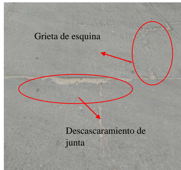
Fotografía 16: Descascaramiento de junta de severidad baja y grieta de esquina de severidad baja.
