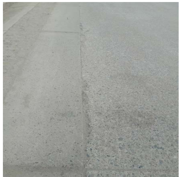
Fotografía 52: Junta deteriorada de severidad media.
