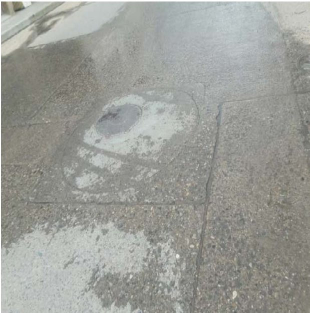
Fotografía 59: Deterioro de parche grande.
