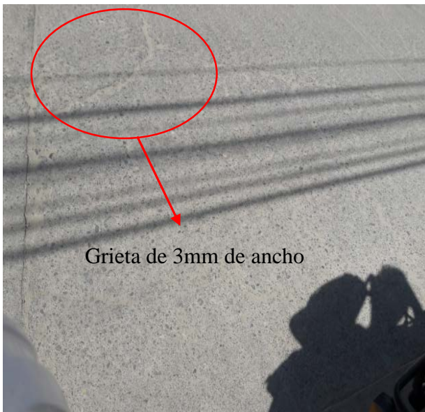
Fotografía 3: Grietas longitudinal de severidad media.
