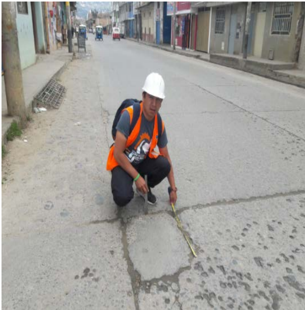
Fotografía 27: Grietas de esquina de severidad baja.
