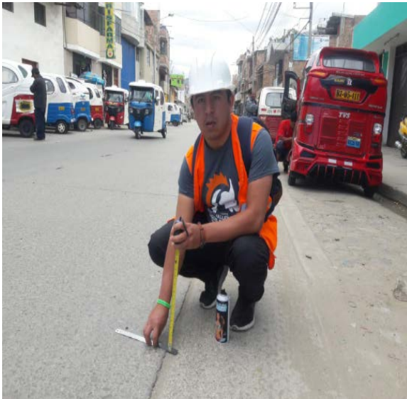
Fotografía 35: Desnivel carril / berma de severidad baja.
