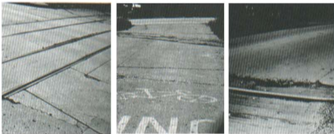
Figura 39: Falla por cruce de vía férrea.
