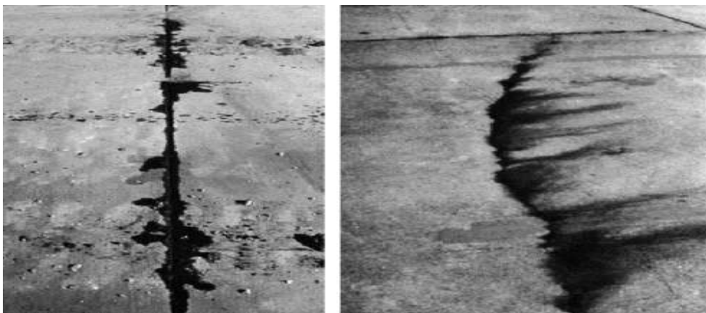
Figura 36: Manifestaciones de falla por bombeo.
