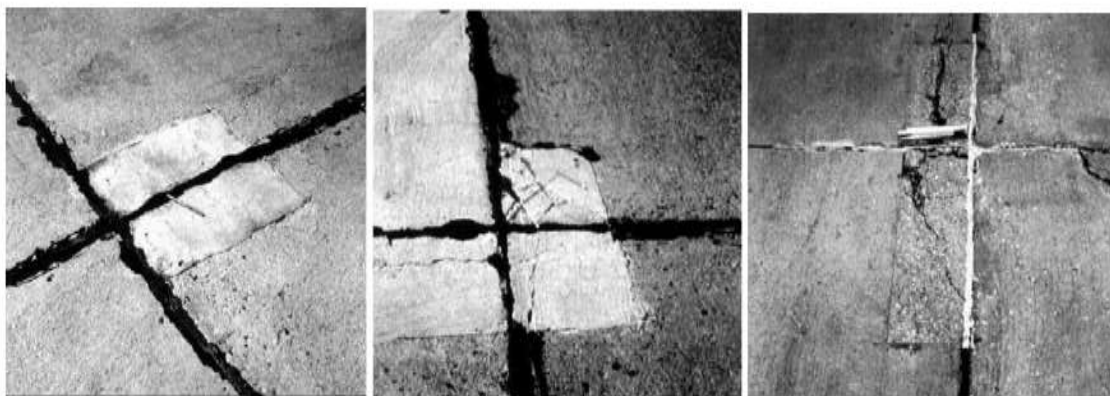
Figura 37: Falla de Parche pequeño.
