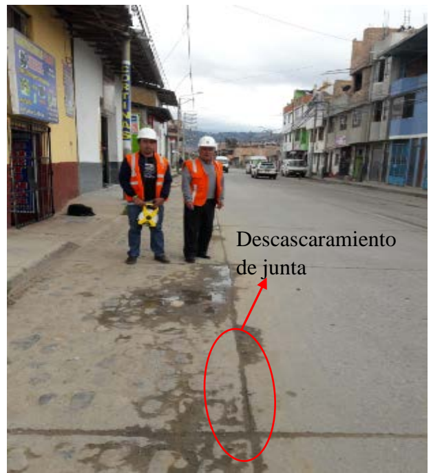
Fotografía 38: Descascaramiento de junta.
