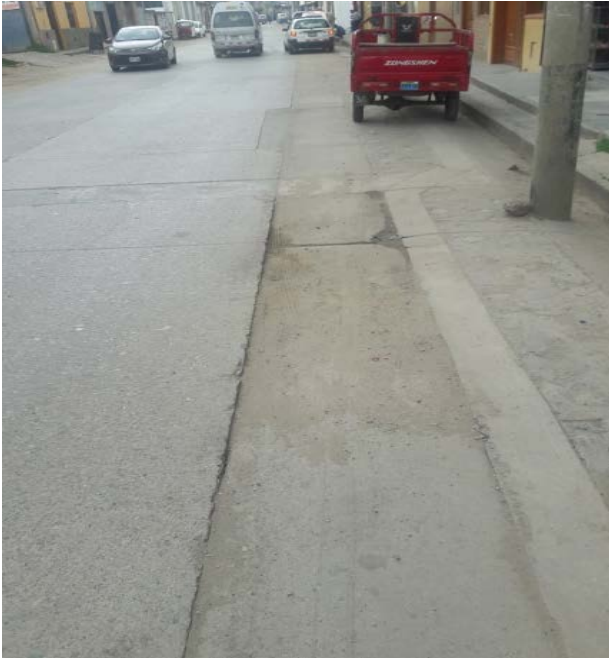
Fotografía 57: Desnivel carril berma de severidad baja.
