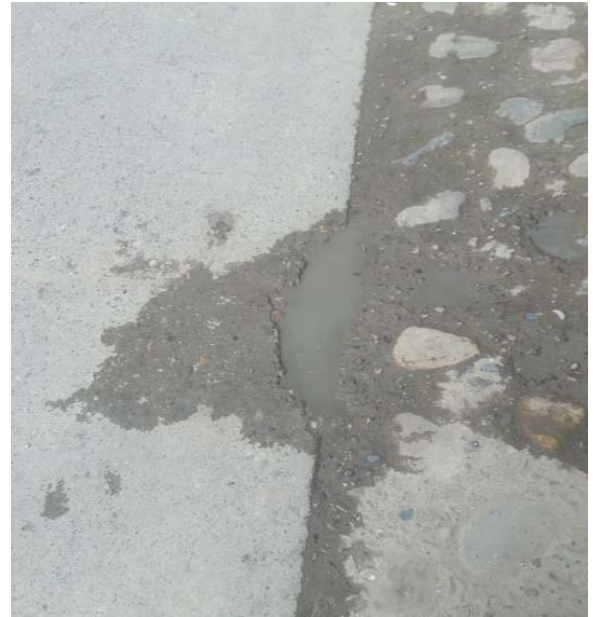
Fotografía 54: Descascaramiento de junta de severidad baja.
