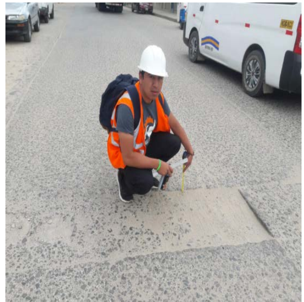
Fotografía 28: Parche grande deteriorado de severidad baja.
