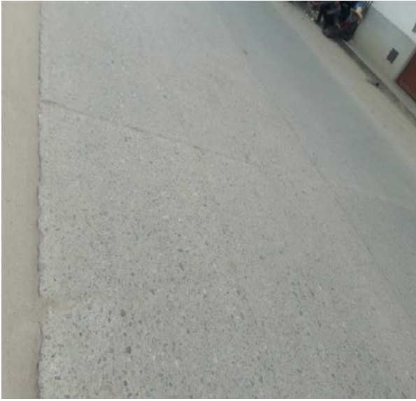
Fotografía 61: Deterioro de junta de severidad baja.
