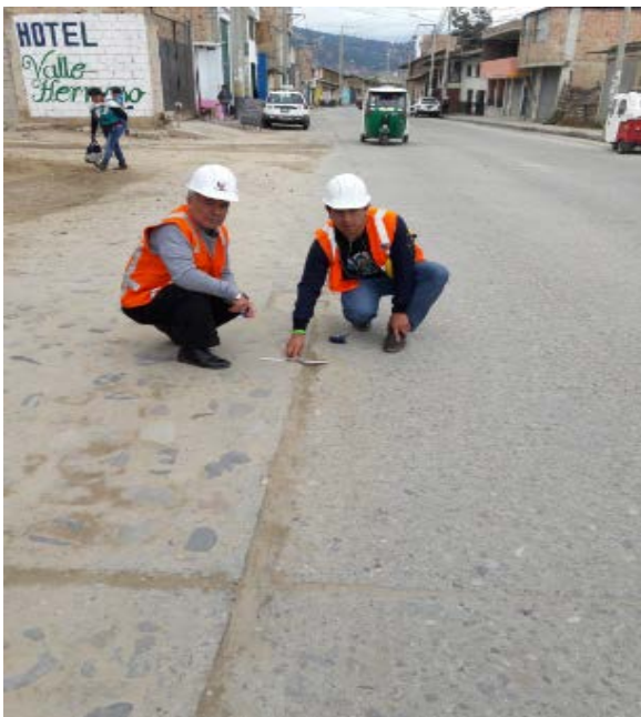
Fotografía 31: Descascaramiento de junta.
