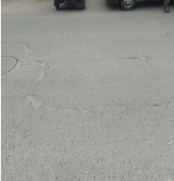
Fotografía 63: Grietas de severidad media
