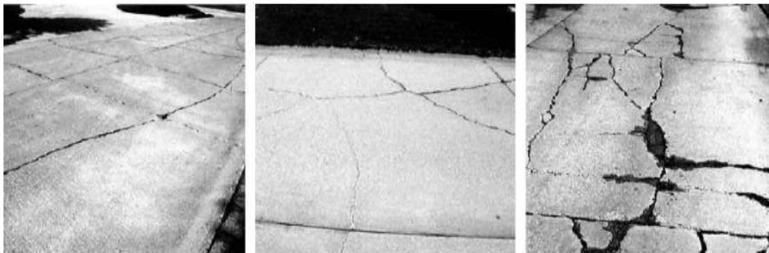
Figura 19: Imagen referencial grieta de esquina.
