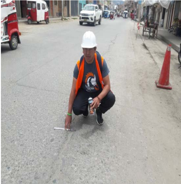
Fotografía 69: Descascaramiento de junta.
