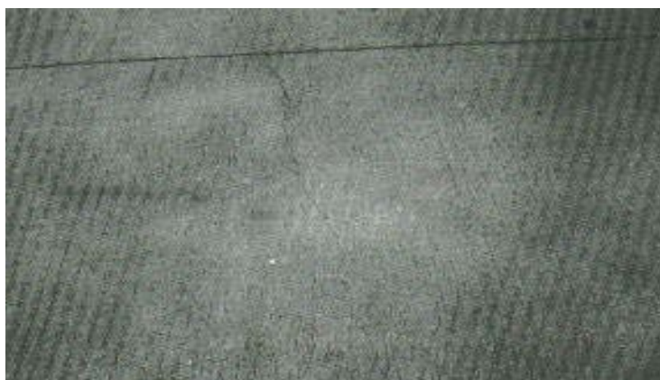
Figura 24: Grieta por retracción.
