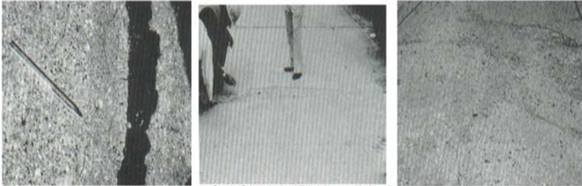
Figura 17: Imagen referencial grieta de durabilidad “D”.
