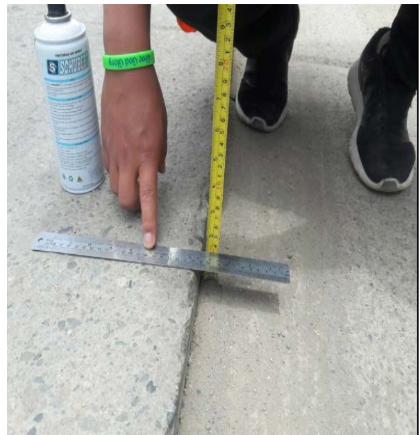
Fotografía 72: Desnivel carril berma de severidad media.
