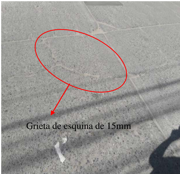
Fotografía 5: Grietas de esquina de severidad media.
