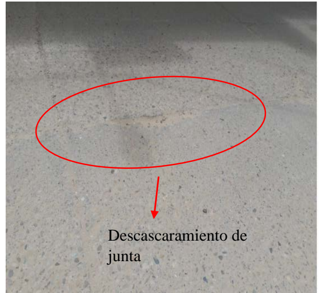
Fotografía 22: Descascaramiento de junta.
