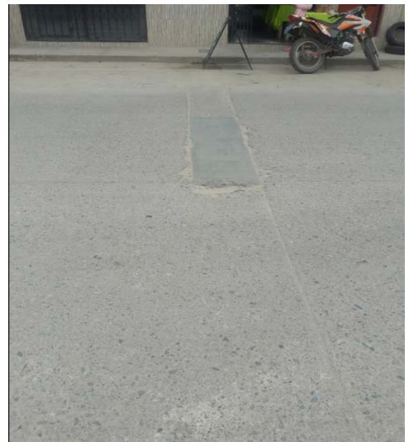
Fotografía 68: Parche pequeño deteriorado de severidad media.
