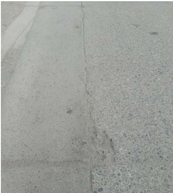
Fotografía 55: Descascaramiento de junta de severidad media.
