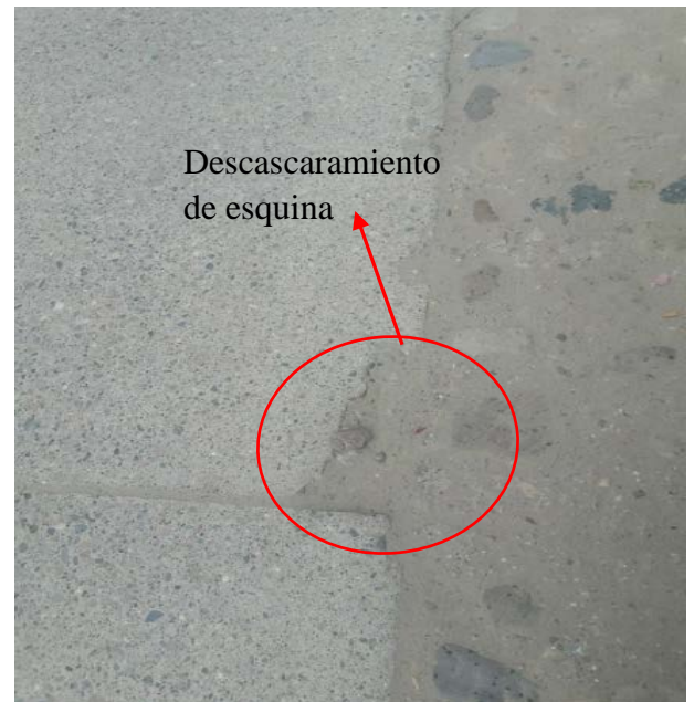
Fotografía 48: descascaramiento de esquina.
