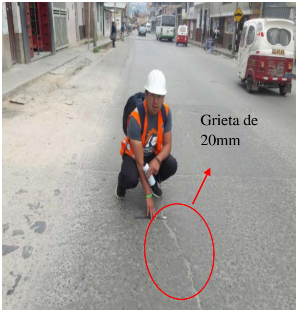
Fotografía 29: Grietas de esquina de severidad media.
