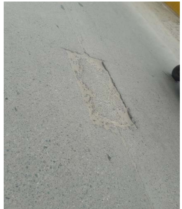
Fotografía 56: Parche pequeño deteriorado de severidad baja.
