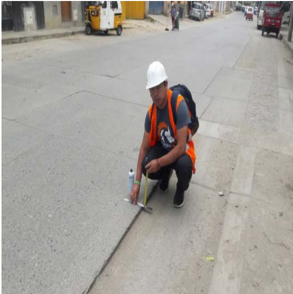
Fotografía 65: Desnivel carril berma de severidad media.
