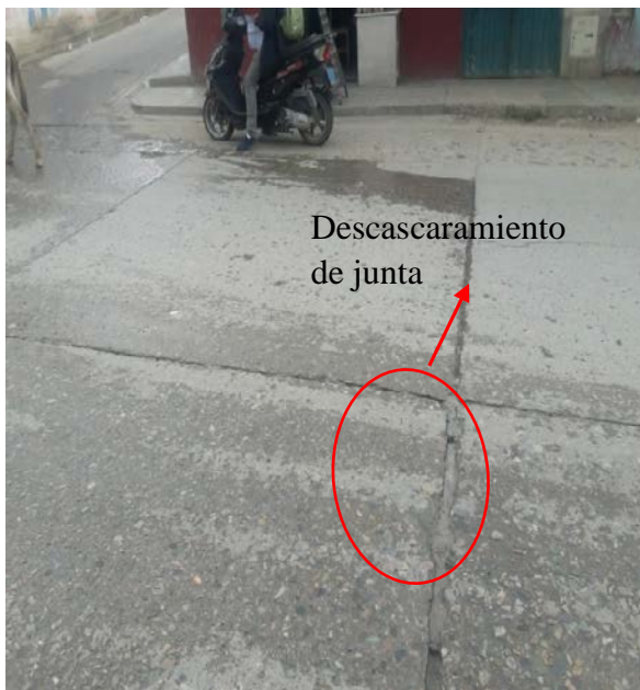
Fotografía 41: Descascaramiento de junta de severidad baja.
