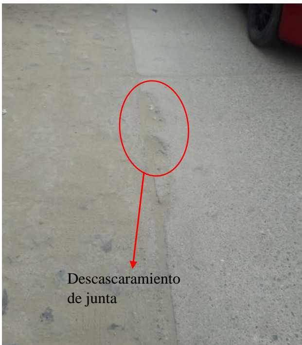
Fotografía 43: Descascaramiento de junta de severidad media.
