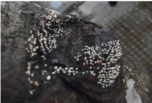
Foto N° 60. Aparición hongos xilófagos de pudrición.
