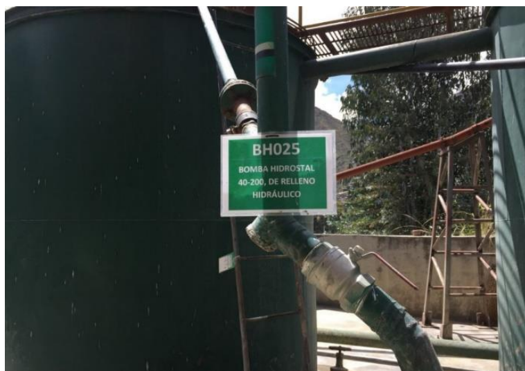
Figura 32. Panel informativo de la bomba y válvula de control.
