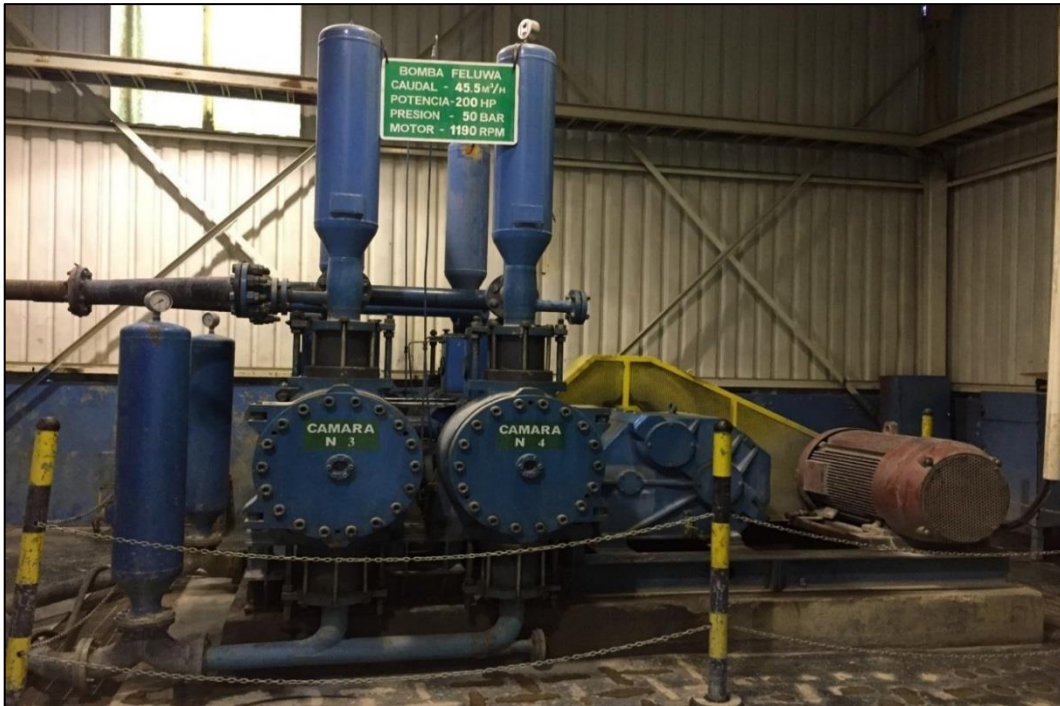
Figura 33. Bomba Feluwa en la planta de relleno hidráulico CMH.
