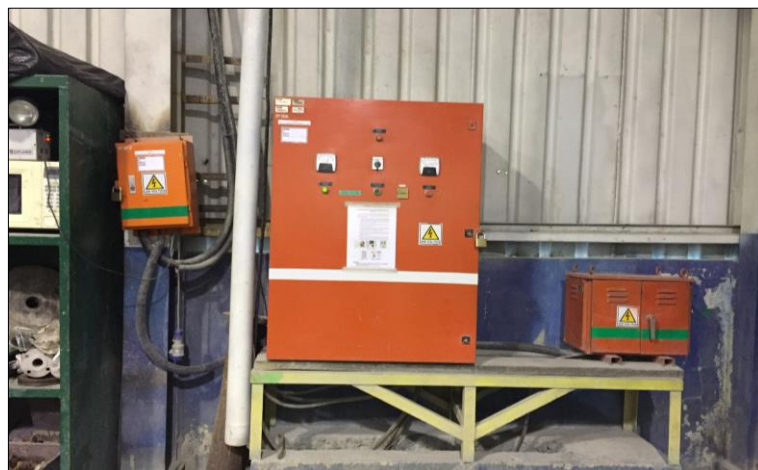
Figura 34. TDF y tablero de control de la bomba Feluwa (440 V).
