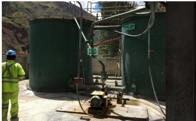
Figura 31. Bomba Hidrostal en planta de relleno hidráulico.
