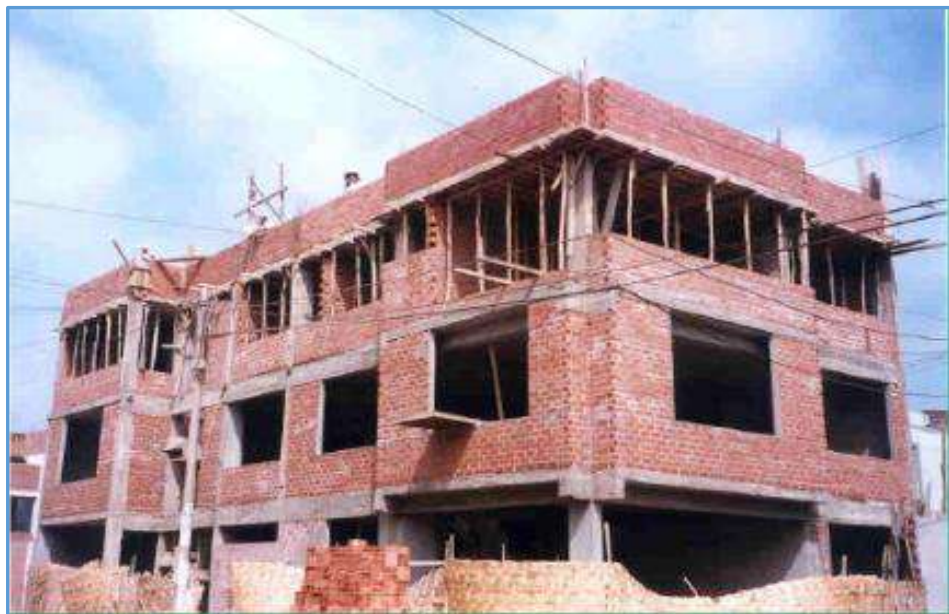
Figura N° 2. 13. Edificio construido con sistema estructural de pórticos con muros de relleno. (Adaptado de Ottazzi, 2004)
