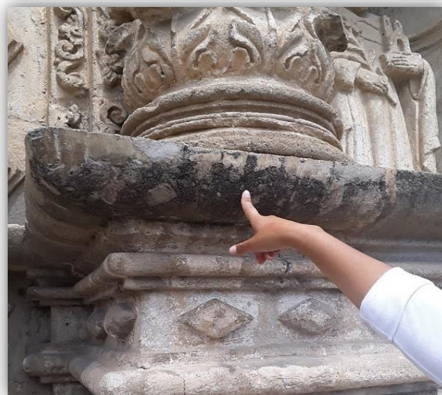
Figura N° 54: Ataques de hongos producto de la humedad.
