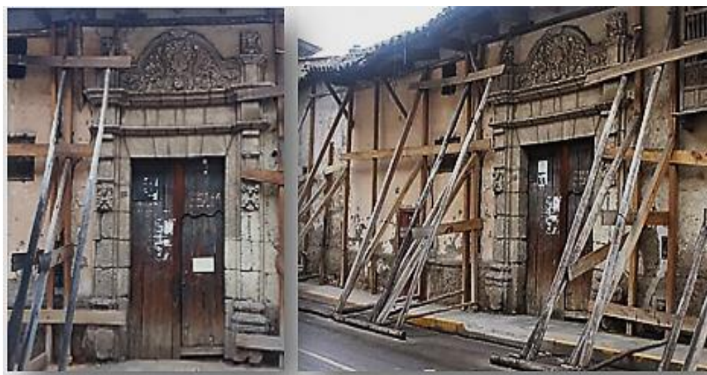
Figura N° 3: Casona Toribio Casanova de Cajamarca, afectada por la falta de mantenimiento y factores ambientales.
