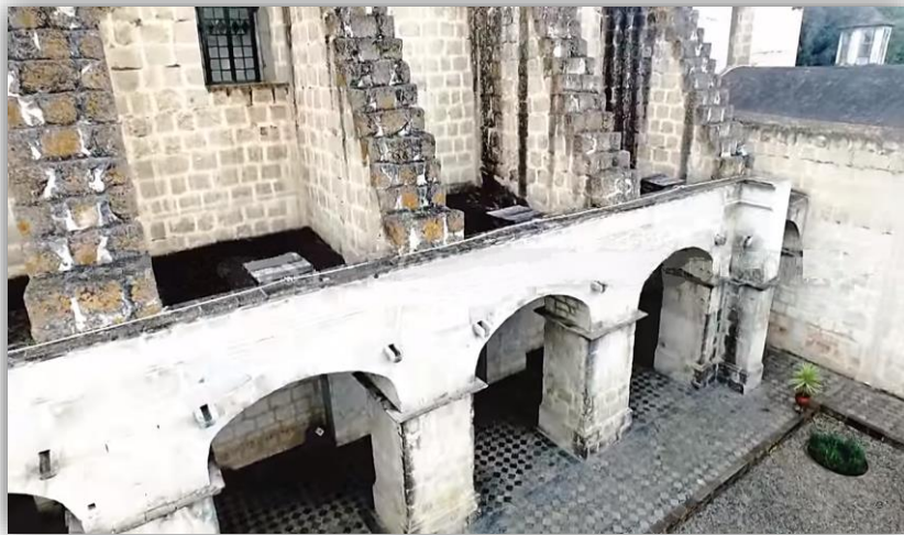
Figura N° 56: Presencia de hongos producto de la humedad en cubiertas y contrafuertes. Fuente: Altavista, 2015
