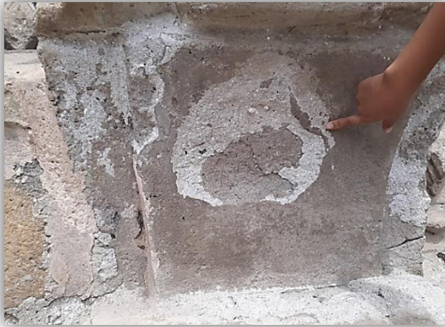
Figura N° 52: Fisuras en los bloques de piedra de la iglesia Belén.
