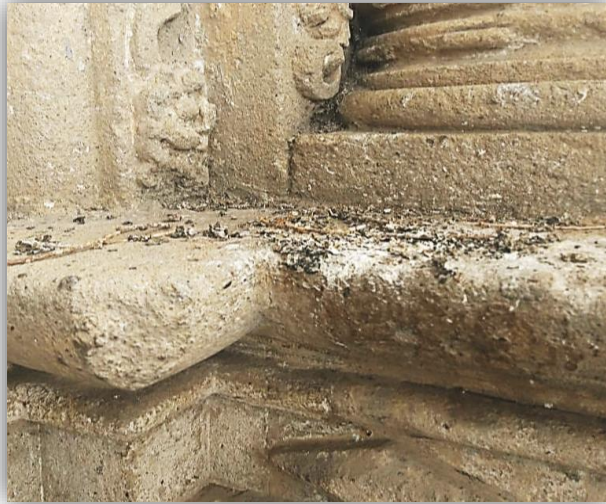
Figura N° 55: Ataques químicos producto del excremento de aves en fachadas.
