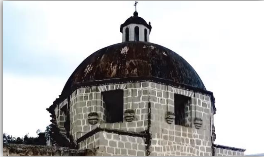
Figura Nº 58: Cúpula de la iglesia Belén afectado por las hongos producto de la humedad. Fuente: Altavista, 2015
