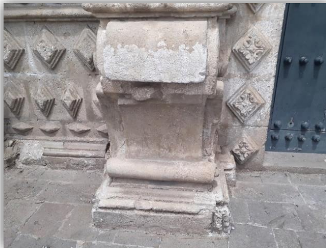
Figura N° 53: Deteriores en la fachada principal por golpes a la estructura.
