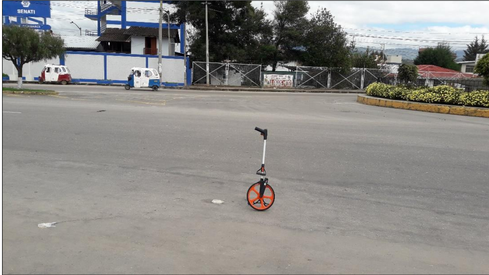
Fotografía N° 05: Ondulación a un costado de la berma
