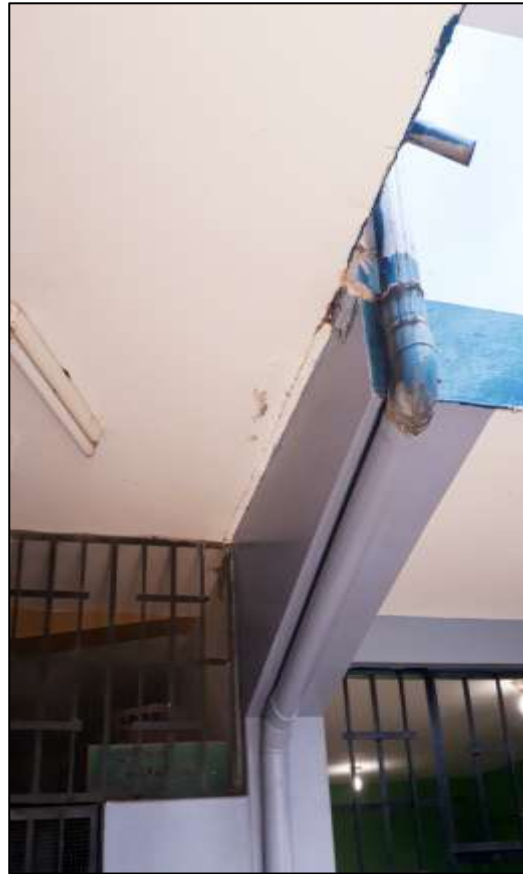
Figura N°31. Fisuras y grietas en esquinas, Módulo C nivel 1
