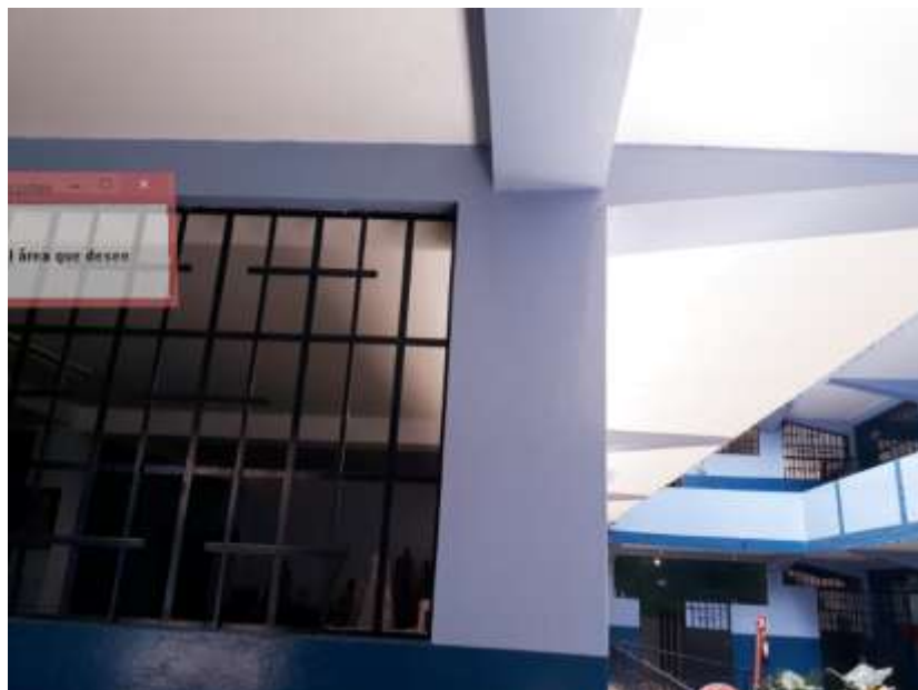
Figura N°32. Estado de algunos elementos estructurales, no presentan grietas ni deterioro, Módulo B nivel 1
