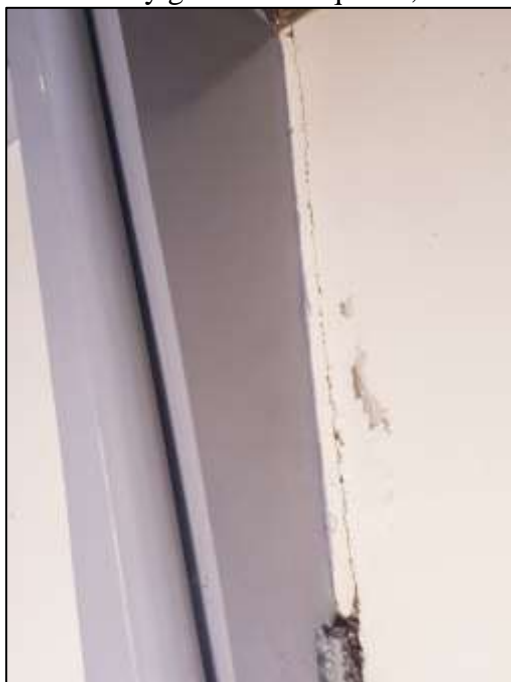
Figura N°30. Fisuras y grietas en esquinas, Módulo D nivel 1
