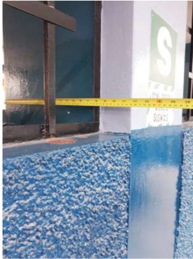
Figura N°35. Estado de algunos elementos estructurales, no presentan grietas ni deterioro, Módulo A nivel 1
