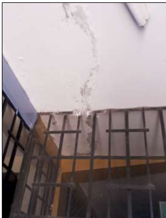
Figura N°29. Deterioro del tarrajeo y pintura por infiltración y humedad, Módulo C nivel 2
