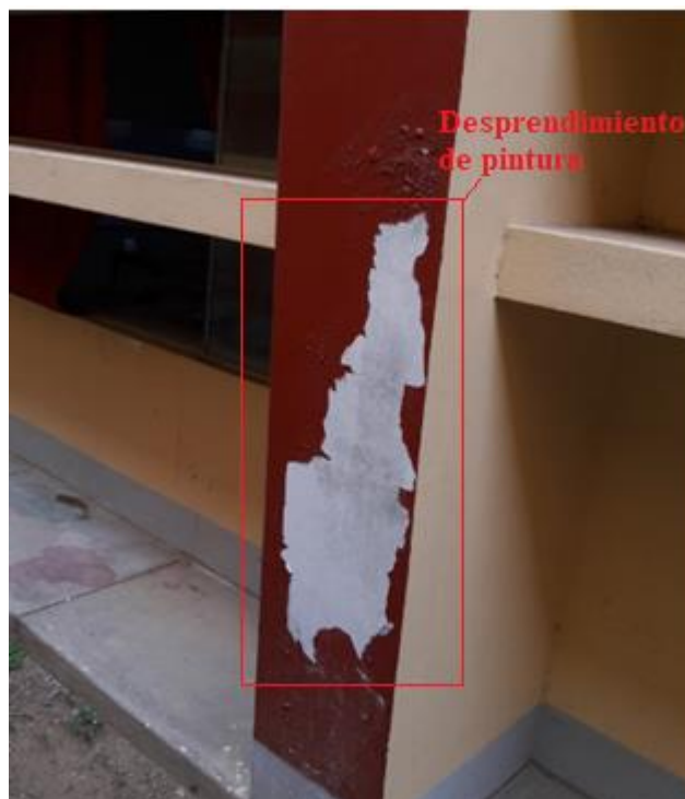
Fotografía 2: Desprendimiento de pintura en columnas.
