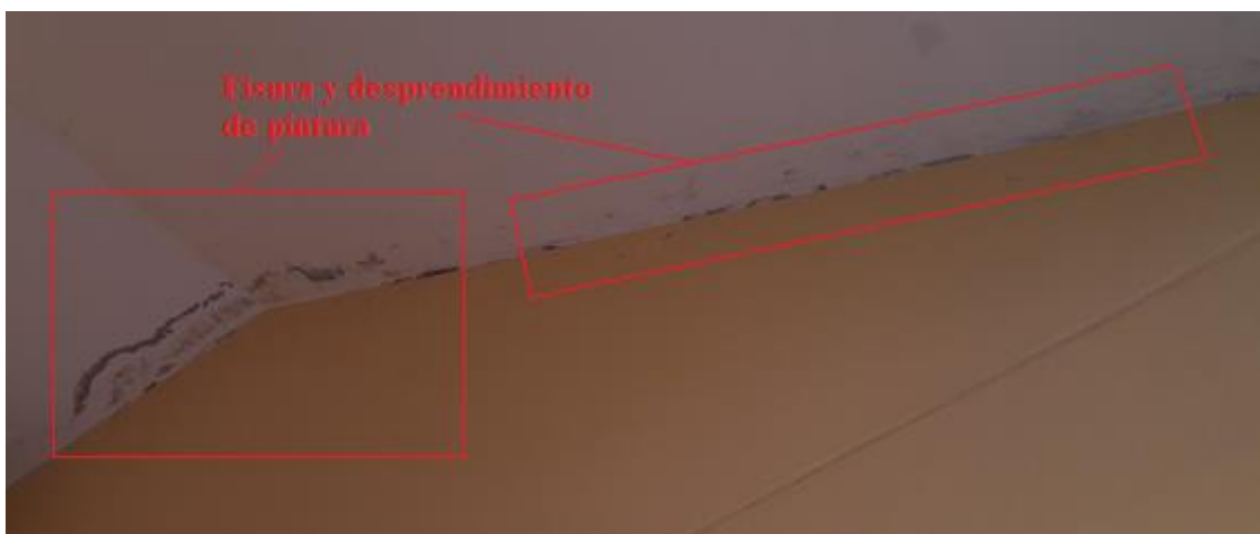
Fotografía 4: Fisura y desprendimiento de pintura en encuentro escalera-muro.
