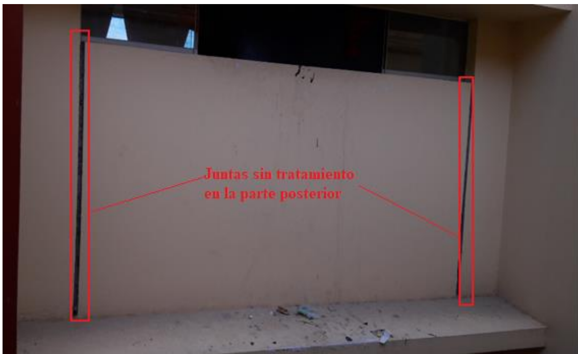
Figura 46: Vista posterior de muros aislados sin material sellante del eje Z'.
