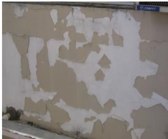
Figura 28: Descascaramiento de pintura.
