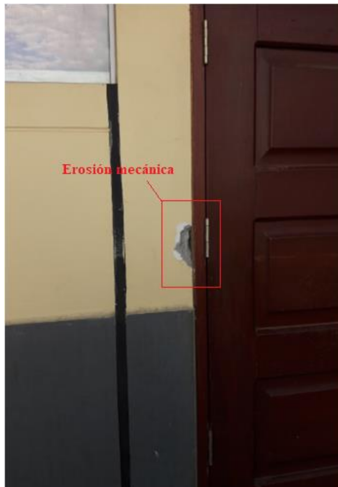
Fotografía 6: Erosión mecánica en muro - 2do nivel.
