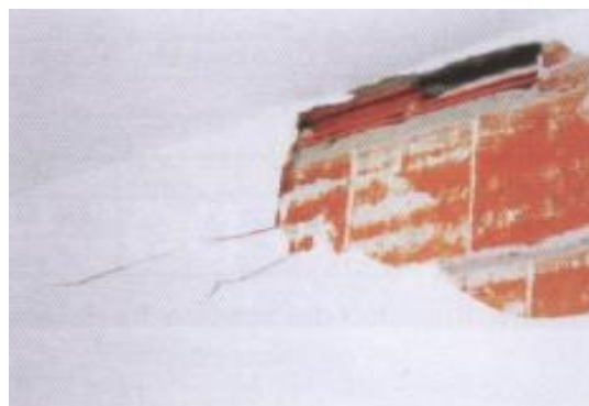
Figura 27: Desprendimiento del acabado.
