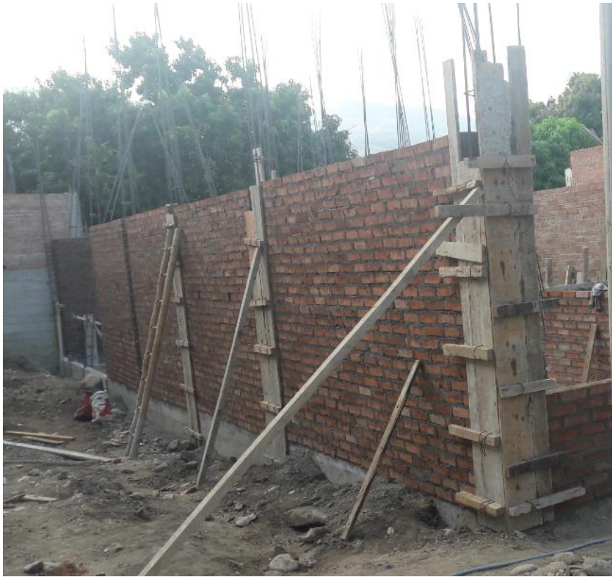
Figura 10: Falta de puntales en encofrado.
