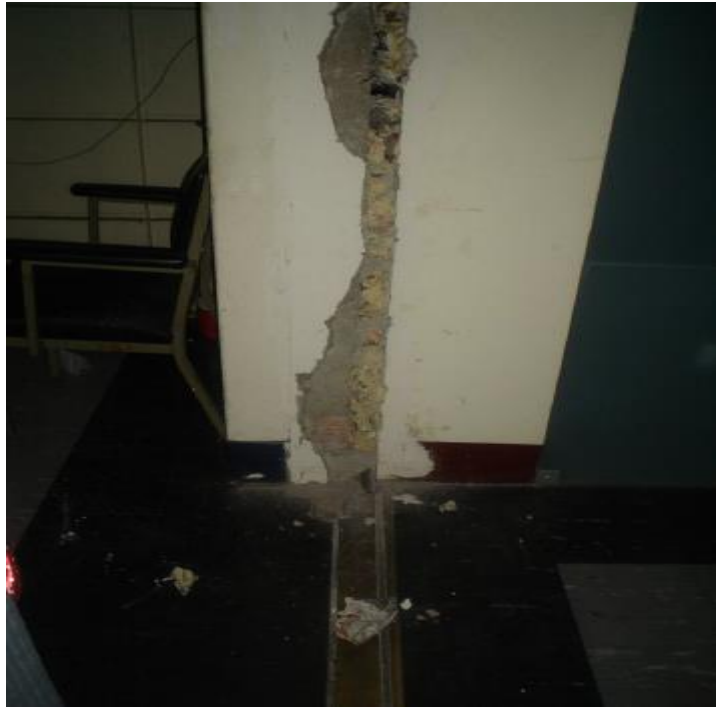
Figura 22: Inadecuado relleno y sellado de junta sísmica.
