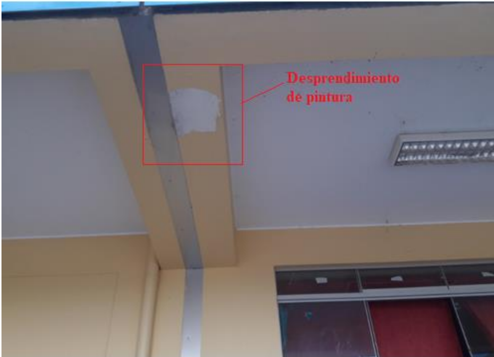
Fotografía 1: Desprendimiento de pintura en vigas.
