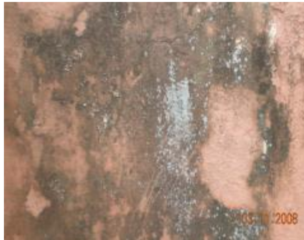
Figura 3: Manchas por humedad.
