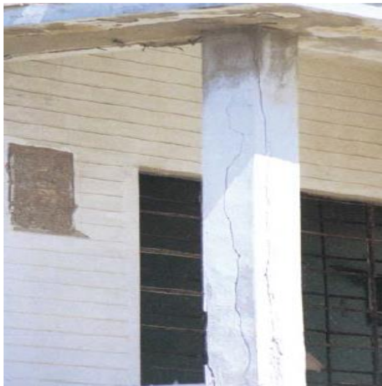
Figura 17: Columna fisurada por exceso de compresión.
