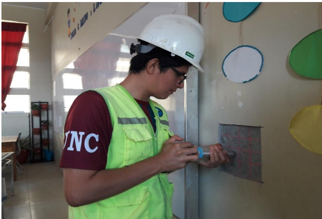
Fotografía 4: Ensayo de Esclerometría en placa M-1 2do nivel – Eje 24 entre X' y Z'.
