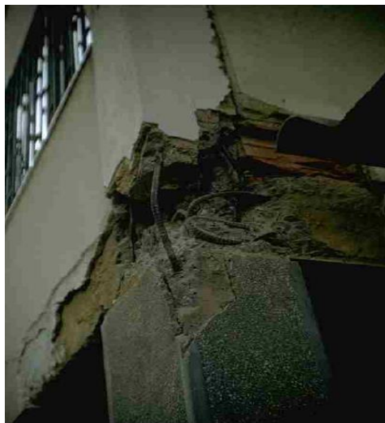
Figura 23: Fallo en conexión viga columna.
