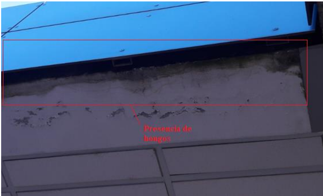
Fotografía 9: Presencia de hongos en viga – 3er nivel.
