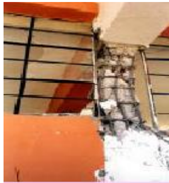
Figura 19: Fallo por columna corta.
