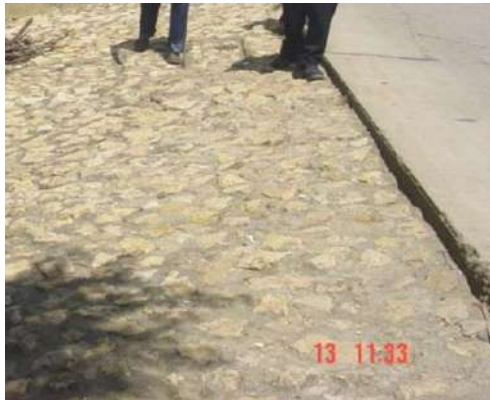
Figura N° 25 Desnivel de Carril/Berma - Mediana severidad.
