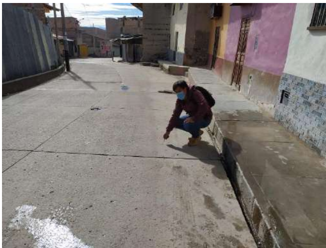
Foto. 21 Identificación de falla (32) popouts.
