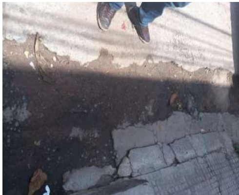
Figura N° 26 Desnivel de Carril/Berma - Alta severidad.
