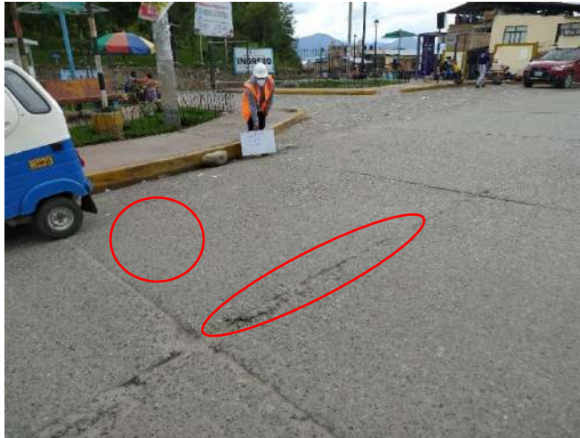
Foto. 7 UM-25 Losa 432. Descascamiento de Junta - Pulimiento de Agregados.
