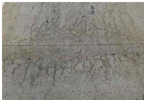
Figura N° 15 Grieta Durabilidad - Baja severidad.
