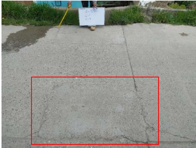
Foto. 1 UM-01 Losa 01. Pulimiento de Agregados, Parche Pequeño.
