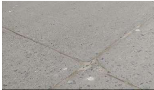
Figura N° 53 Descascaramiento de Esquina - Baja Severidad.
