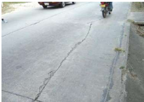
Figura N° 27 Grietas Lineales - Baja severidad.
