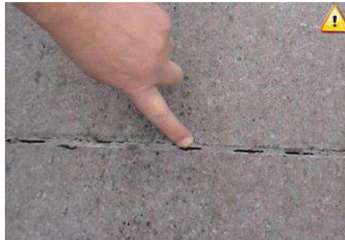
Figura N° 22 Daño de sellado de juntas - Mediana severidad.
