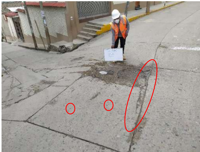
Foto. 8 UM-17 Losa 286. Descascamiento de Junta - Popouts.
