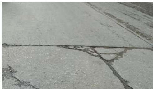
Figura N° 55 Descascaramiento de Esquina - Alta Severidad.
