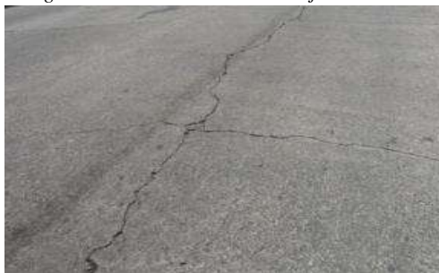
Figura N° 12 Losa dividida - Baja Severidad.
