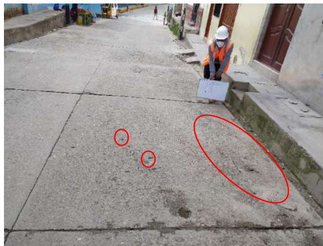
Foto. 6 UM-08 Losa 117. Pulimiento de Agregados - Popouts.
