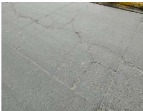
Figura N° 29 Grietas Lineales - Alta severidad.
