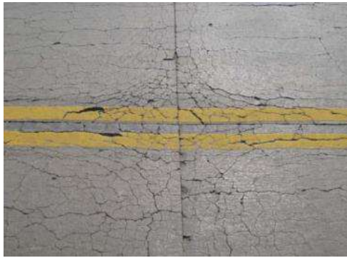
Figura N° 16 Grieta Durabilidad - Mediana severidad
