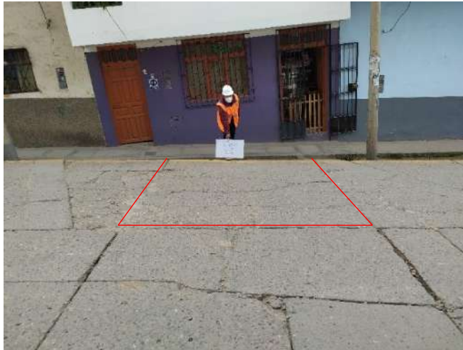
Foto. 16 UM-27 Losa 472. Grieta en Esquina - Popouts - Losa Dividida – Parcheo Grande.
