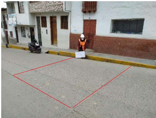
Foto. 15 UM-28 Losa 489. Pulimiento de Agregados - Parcheo Grande - Daño en Sello de Junta.
