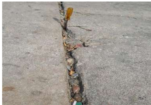
Figura N° 23 Daño de sellado de juntas - Alta severidad.
