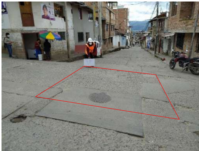
Foto. 14 UM-30 Losa 520. Pulimiento de Agregados - Parcheo Grande - Descascaramiento Junta y Esquina.
