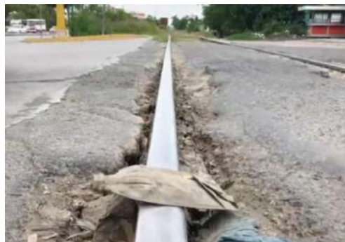
Figura N° 47 Cruce de Vía Férrea - Alta Severidad.
