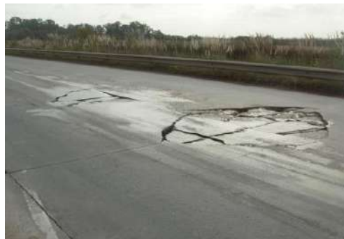
Figura N° 11 Grieta de esquina - Alta Severidad.
