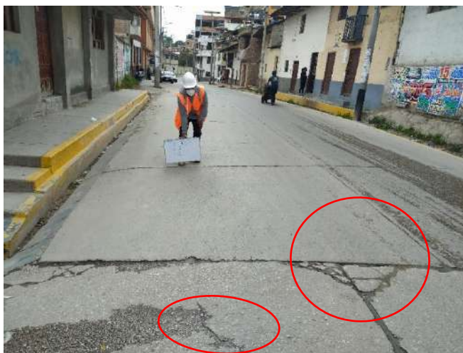
Foto. 9 UM-13 Losa 213. Grieta de Esquina - Grietas Lineales.
