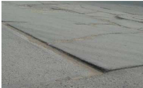
Figura N° 19 Escalonamiento - Mediana severidad.
