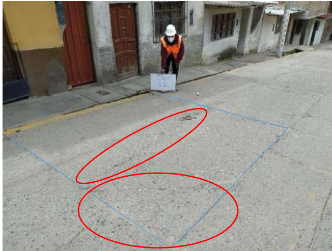
Foto. 13 UM-32 Losa 568. Losa Dividida - Parcheo Grande - Grieta de Esquina - Popouts.
