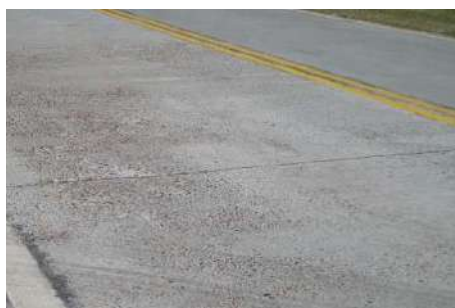
Figura N° 48 Descascamiento, Mapa de grietas, Craquelado - Baja Severidad.
