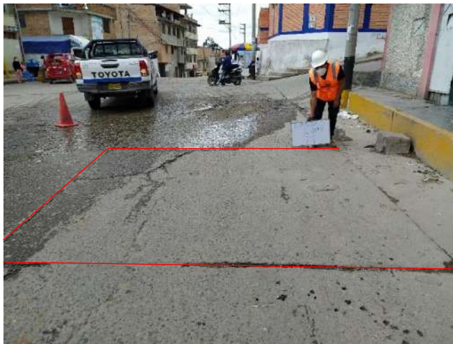
Foto. 17 UM-46 Losa 824. Grieta en Esquina - Popouts - Losa Dividida.
