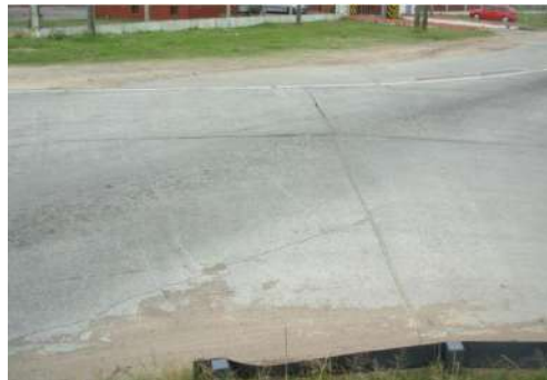
Figura N° 10 Grieta de esquina - Mediana Severidad.
