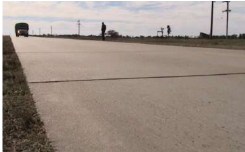
Figura N° 18 Escalonamiento - Baja severidad.
