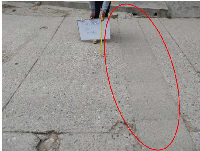
Foto. 10 UM-02 Losa 4. Parcheo Grande.
