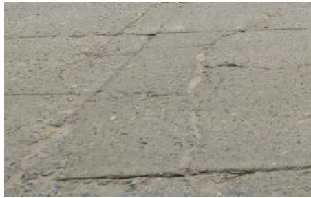
Figura N° 44 Punzonamiento - Alta Severidad.
