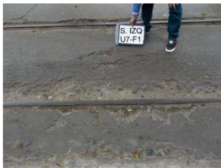
Figura N° 46 Cruce de Vía Férrea - Mediana Severidad.
