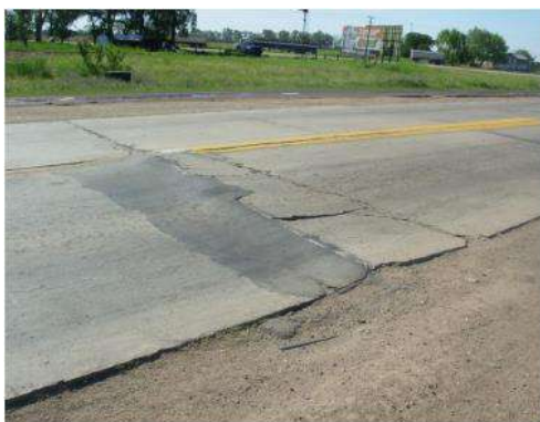
Figura N° 7 Levantamiento/Pandeo - Mediana Severidad.
