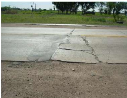
Figura N° 6 Levantamiento/Pandeo - Baja Severidad.
