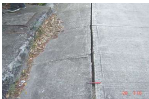
Figura N° 24 Desnivel de Carril/Berma - baja severidad.
