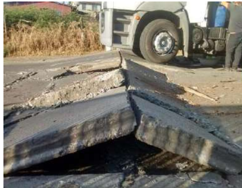
Figura N° 8 Levantamiento/Pandeo - Alta Severidad.
