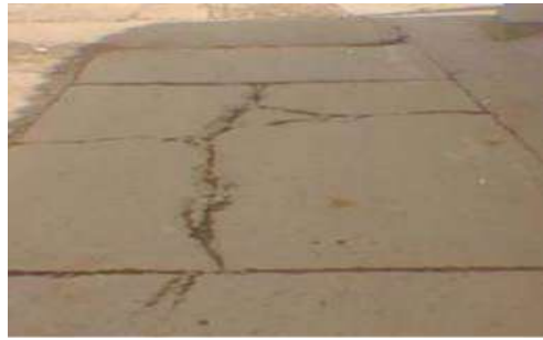
Figura N° 13 Losa dividida - Mediana Severidad.
