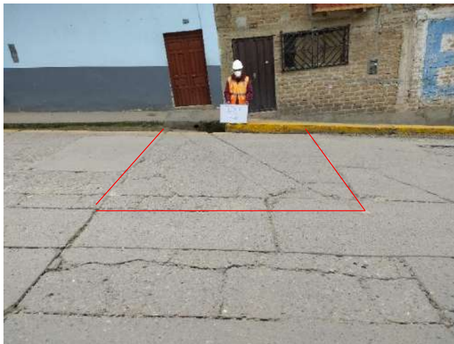
Foto. 18 UM-32 Losa 570. Grieta en Esquina - Popouts - Losa Dividida – Parcheo Grande.
