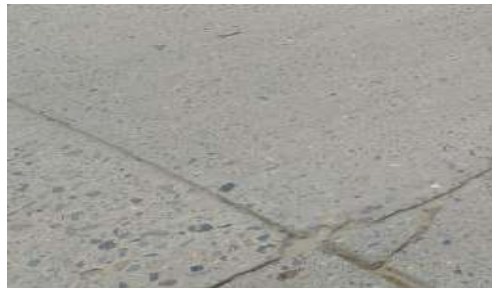
Figura N° 54 Descascaramiento de Esquina - Mediana Severidad.
