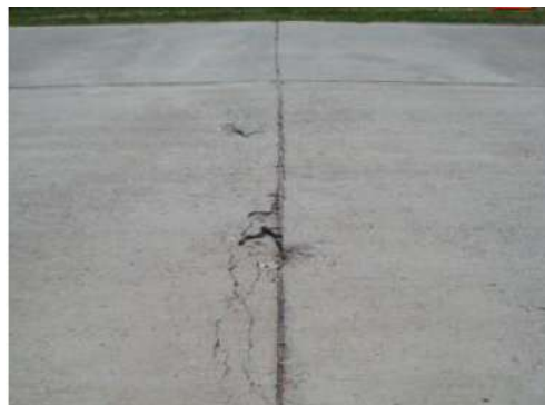
Figura N° 17 Grieta Durabilidad - Alta severidad
