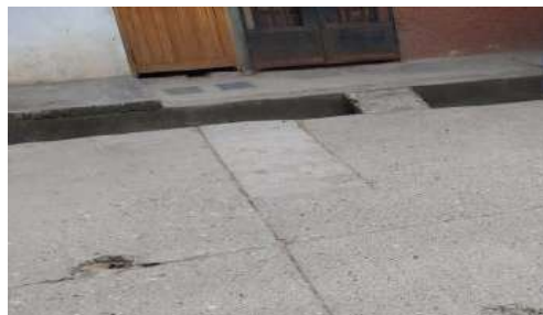
Figura N° 33 Parche Pequeño - Baja Severidad.
