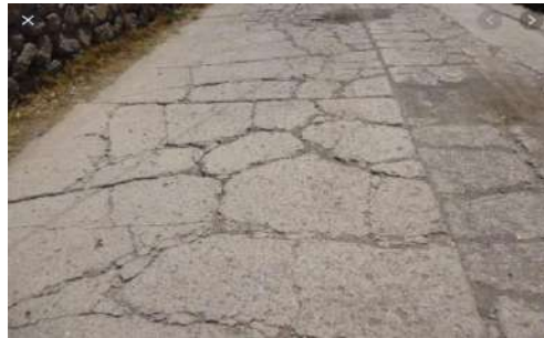
Figura N° 14 Losa dividida - Alta Severidad.
