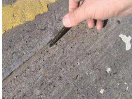
Figura N° 21 Daño de sellado de juntas - Baja severidad.
