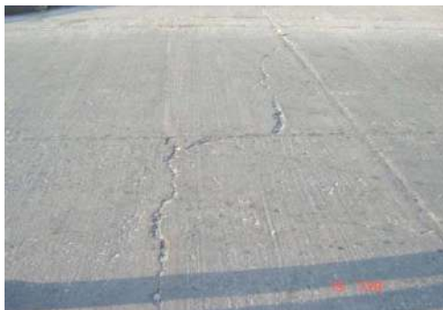
Figura N° 28 Grietas Lineales - Mediana severidad.
