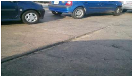
Figura N° 20 Escalonamiento - Alta severidad.
