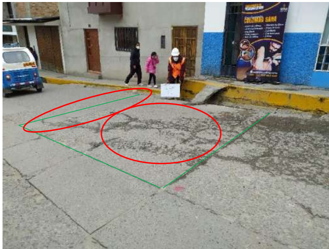
Foto. 11 UM-26 Losa 451. Losa Dividida - Parcheo Grande.
