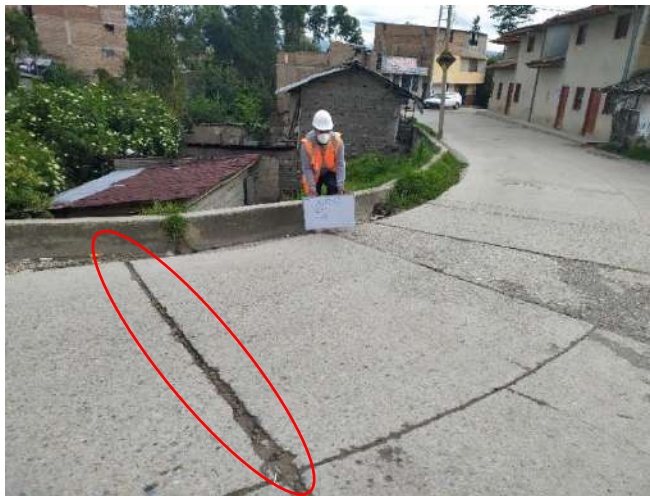
Foto. 3 UM-01 Losa 04. Daño en Sello de Junta.
