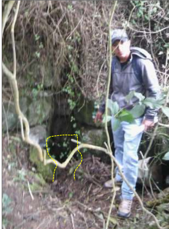
Foto 17. Sumidero con dimensiones de 25 cm x 30 cm. absorbe el total de escorrentías que se da en tiempo de lluvias. Ubicado entre Machaypungo Bajo y Machaypungo Alto. Longitud: 768711 / Latitud: 9263498.
