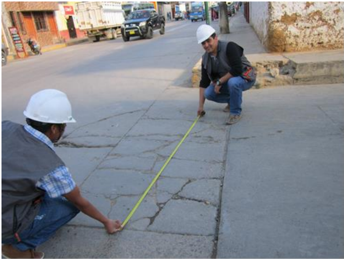
Fotografía 06. Losa dividida de alta severidad.
