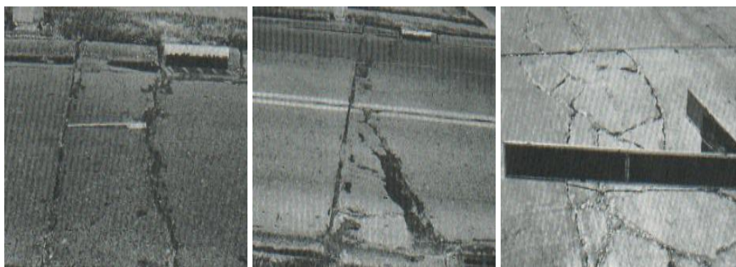
Figura 20 Punzonamiento (Izquierda severidad baja, centro severidad media e izquierda alta severidad)
