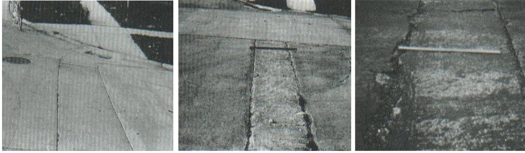
Figura 15 Parche grande y acometidas de servicios públicos (Izquierda severidad baja, centro severidad media e izquierda alta severidad)
