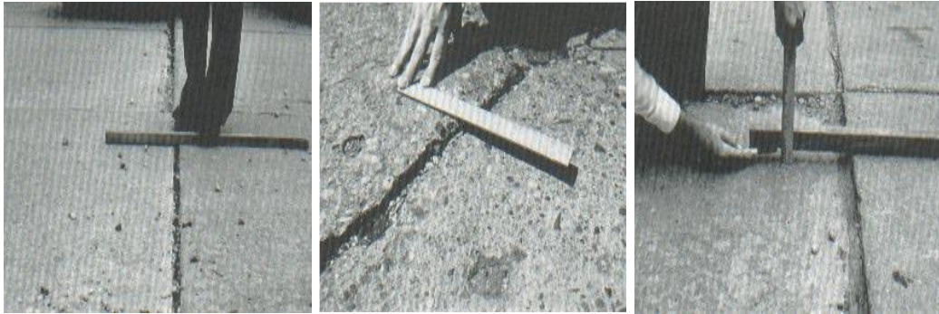
Figura 11 Escala (Izquierda severidad baja, centro severidad media e izquierda alta severidad)
