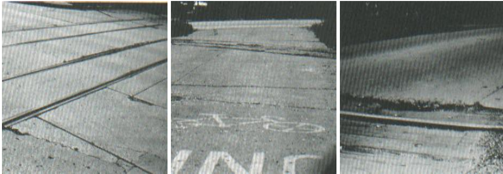
Figura 21 Cruce de vía férrea (Izquierda severidad baja, centro severidad media e izquierda alta severidad)
