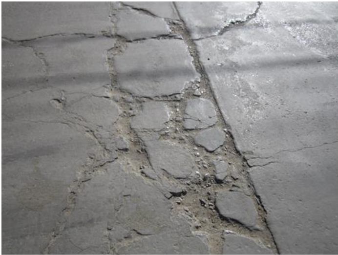
Fotografía 04. Punzonamiento de alta severidad.
