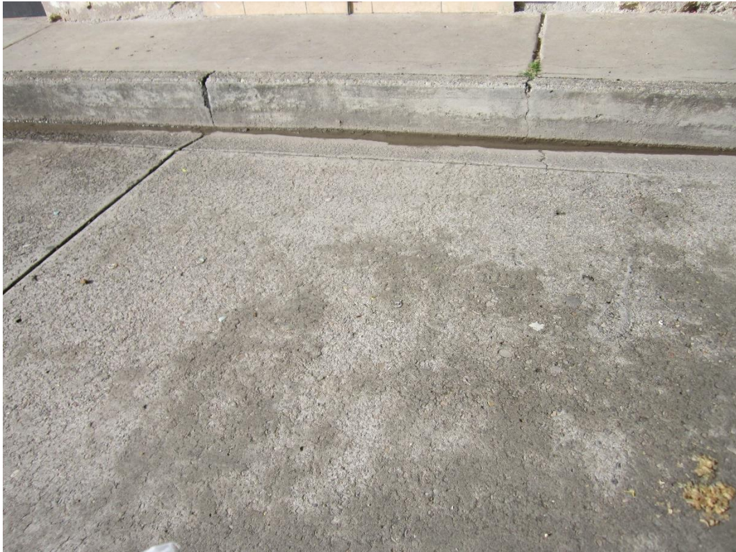
Imagen 6. Daño en la superficie de la losa.
