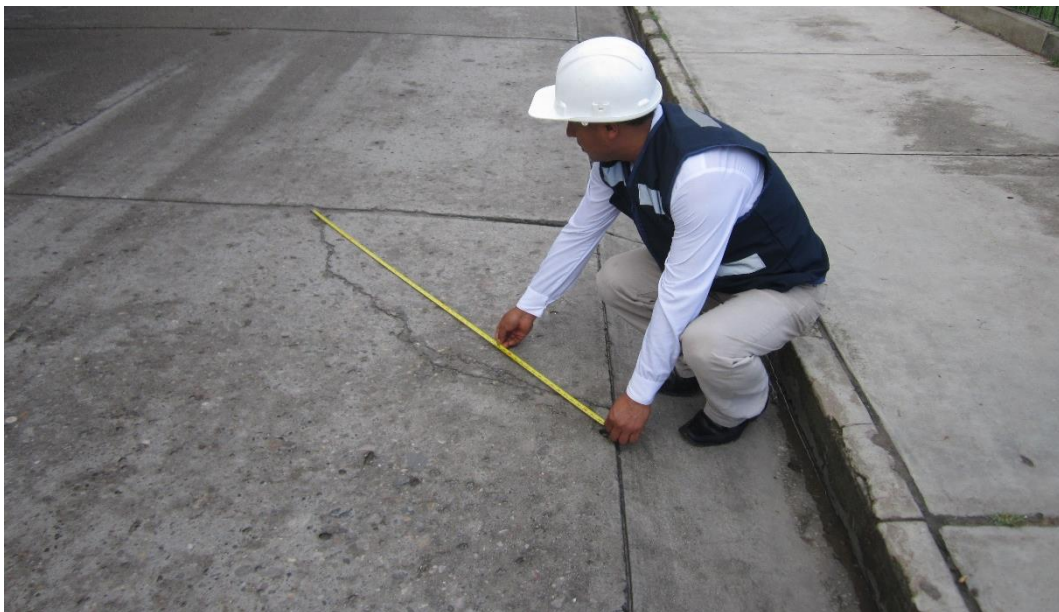
Imagen 1. Grietas de esquina.
