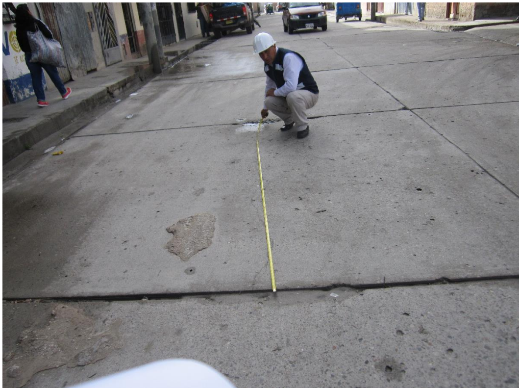
Imagen 3 Daños en junta y losa dividida.
