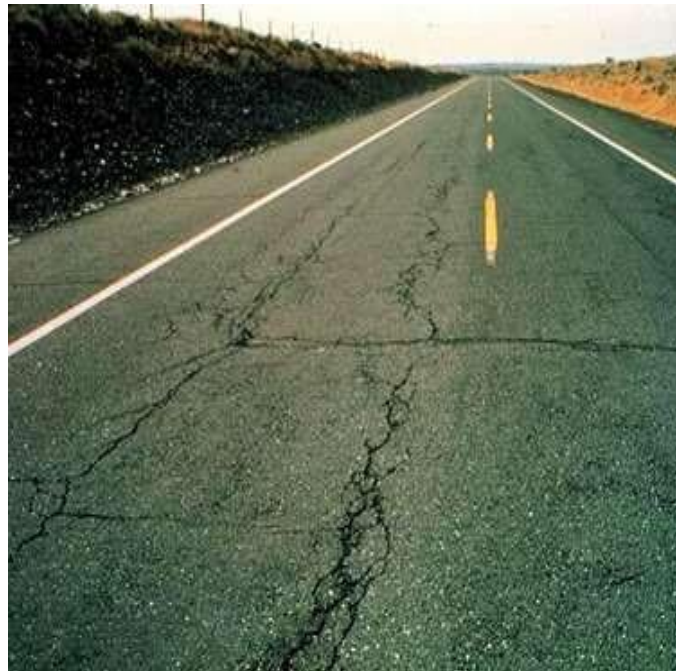
Fisura en bloque
