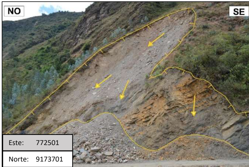
Foto 24: Derrumbes sobre afloramientos de la Formación Chimú, flanco izquierdo de la carretera hacia Rambrán (progresiva Km 07+050).
