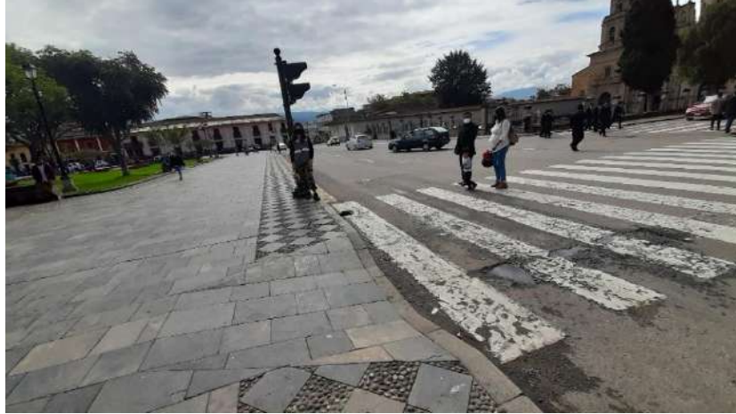
Figura 4.21. Estado de cruce peatonal en el Jr. Dos de mayo. cdra. 04
