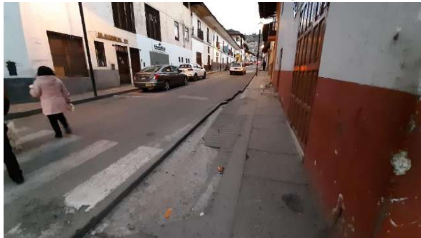
Figura 4.22. Estado de rampa en el Jr. Cinco esquinas. cdra. 05
