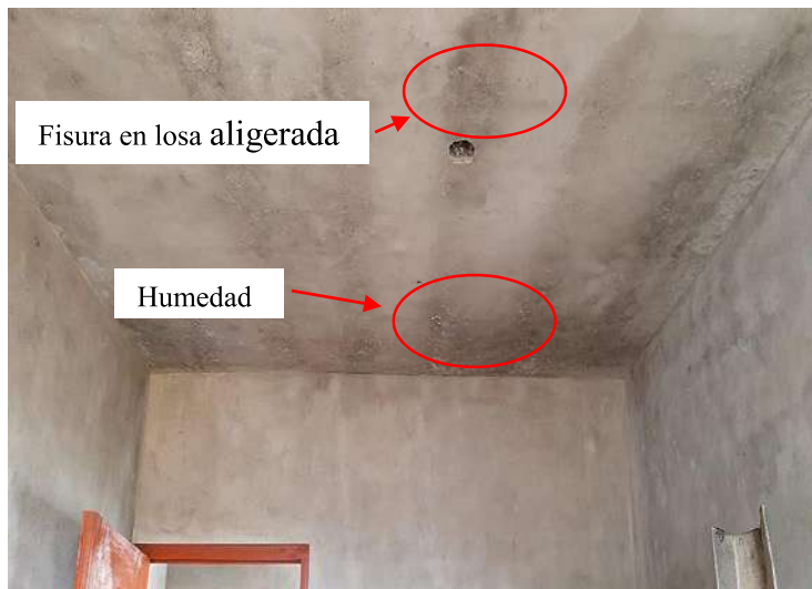
Humedad en la losa aligerada y fisuras en losa aligerada
