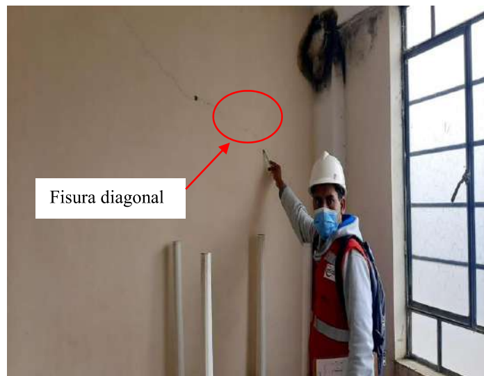
Fisura diagonal en muro portante de la vivienda
