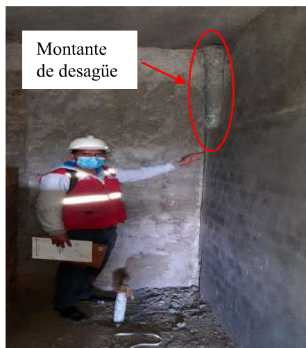
Montante de desagüe expuesta en muro portante
