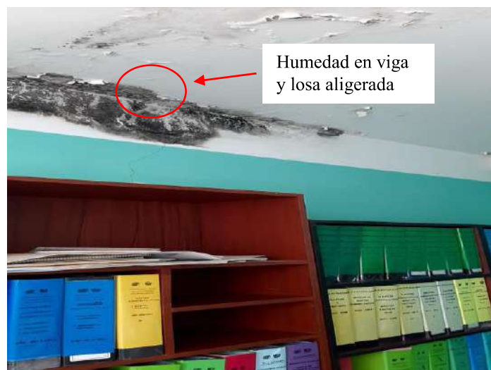
Eflorescencias en viga y humedad en losa aligerada
