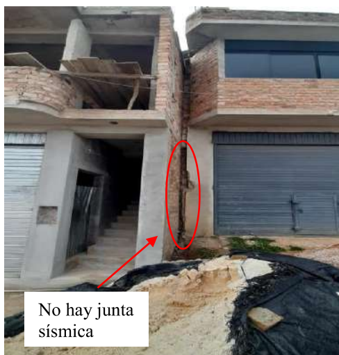
Falta de junta sísmica entre viviendas
