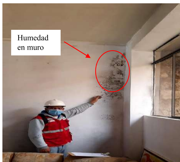
Humedad en muro portante
