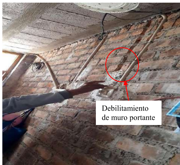
Cortes hechos en el muro portante para las instalaciones electricas.
