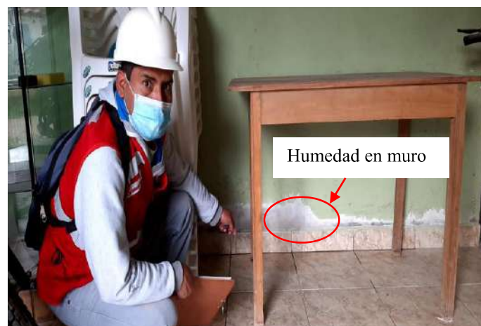
Humedad en muros de la vivienda.
