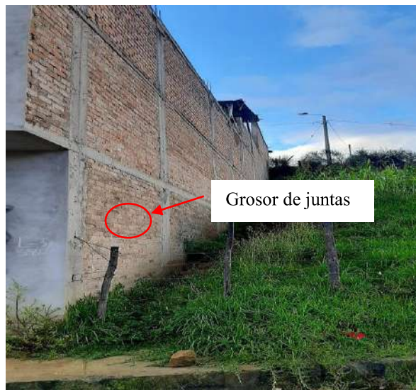
Vista de muro portante y grosor de junta mayor de 15 mm
