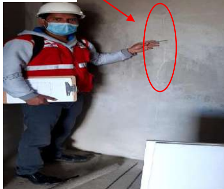
Fisura vertical en muro portante
