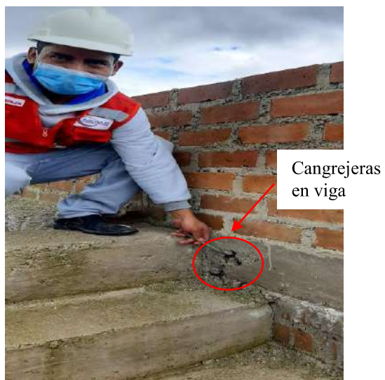
Cangrejas en viga chata de la vivienda
