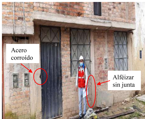
Acero expuesto en ingreso a la vivienda.
