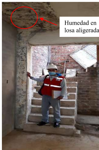
Humedad en losa aligerada y columna
