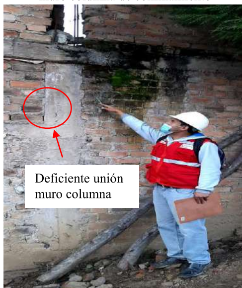
Deficiente unión muro columna y grosor de junta mayor de 15 mm
