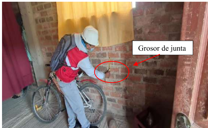
Medida del grosor de las juntas, estas juntas están por encima del límite máximo de 15 mm
