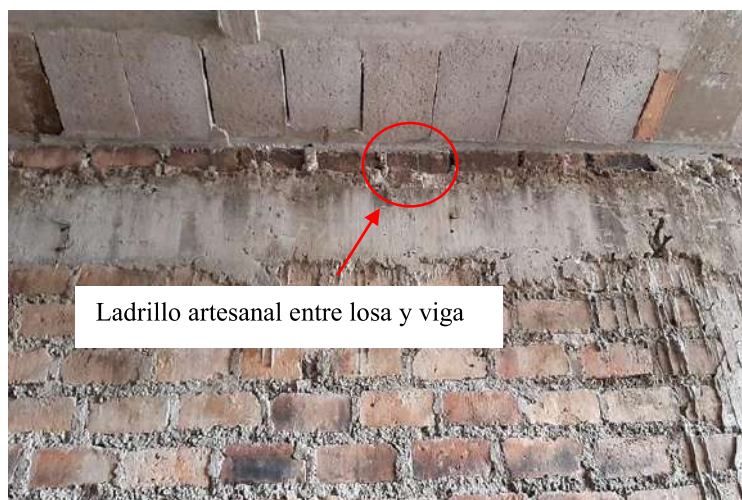
Junta fría, para llegar a la altura se colocó ladrillos sobre la viga que debió ser vaciado con la losa aligerada.
