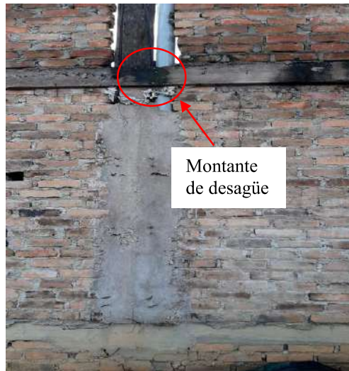
Montante de desagüe pegado a la columna, problema de unión muro columna de confinamiento
