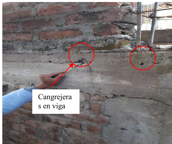
Acero expuesto en viga chata y cangrejeras
