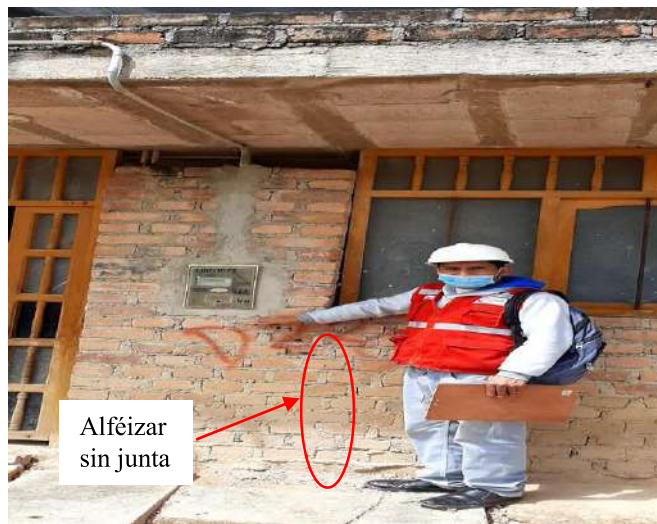
Tabiquería sin columnetas, alféizar sin junta
