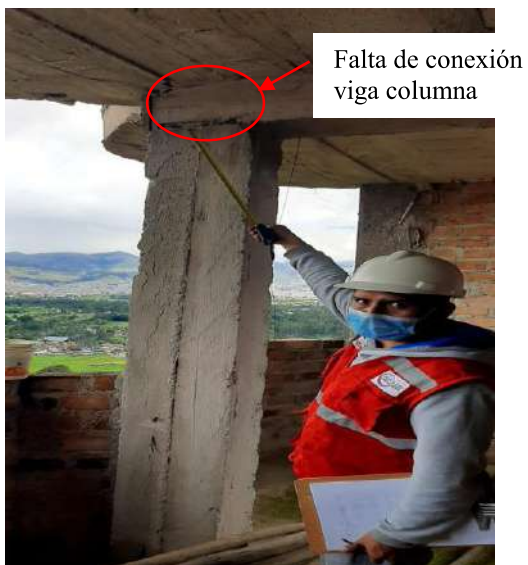
Deficiencias en la conexión viga columna
