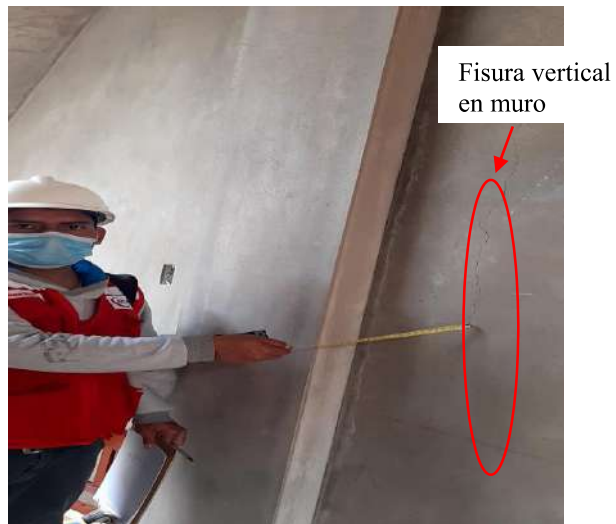
Fisura vertical en muro portante
