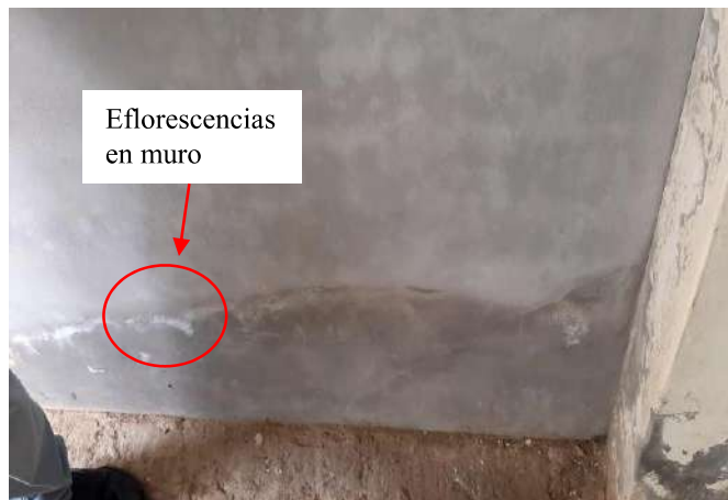
Eflorescencias en muros portantes de la vivienda
