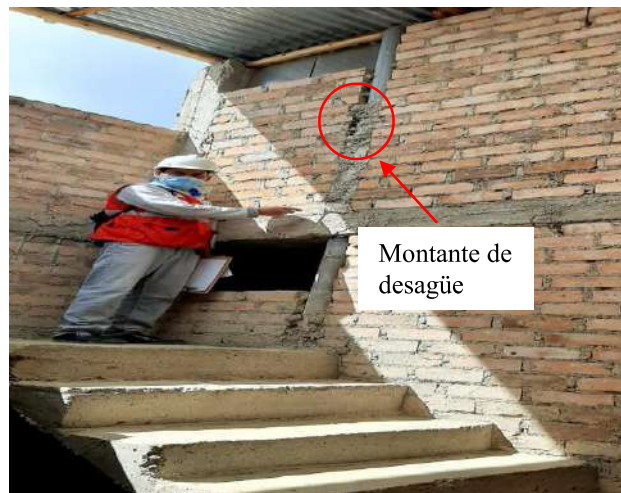
Montante de desagüe que corta a la viga, restando resistencia a la misma.
