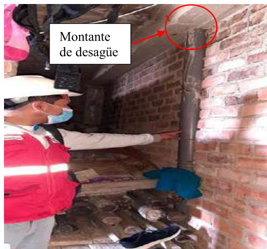
Montante de desagüe que corta a viga y muro portante
