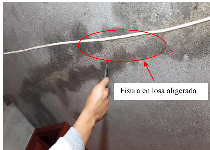
Fisura longitudinal en losa aligera, así también se puede apreciar la humedad en esta.
