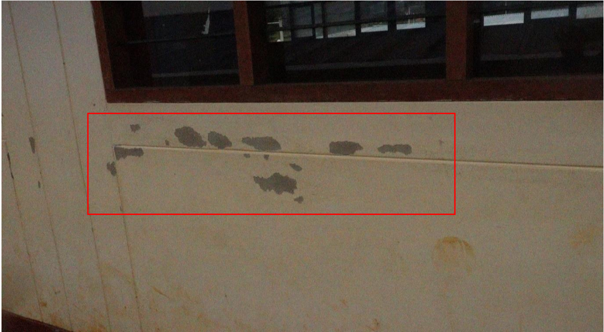
Fotografía 3. Desprendimiento de pintura en muros primer nivel
