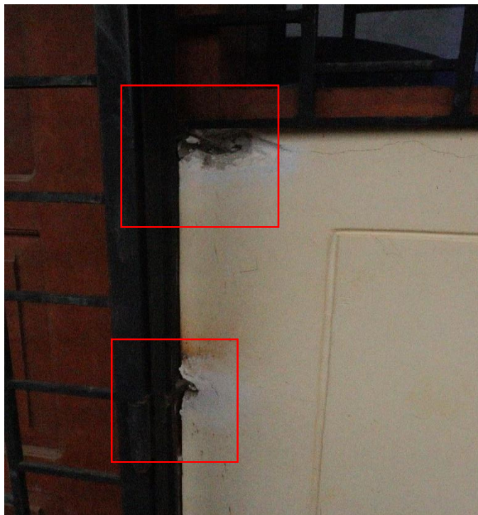
Fotografía 6. Erosión mecánica Primer nivel
