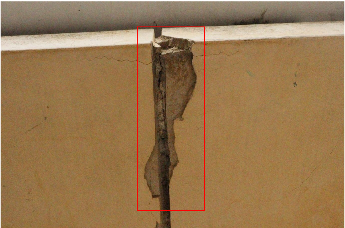
Fotografía 4. Erosión mecánica de parapeto y junta de dilatación eje y-6, 2do nivel
