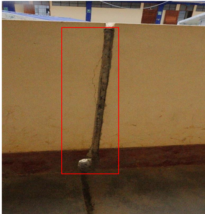
Fotografía 5. Erosión mecánica y deterioro de junta Y-5 segundo nivel
