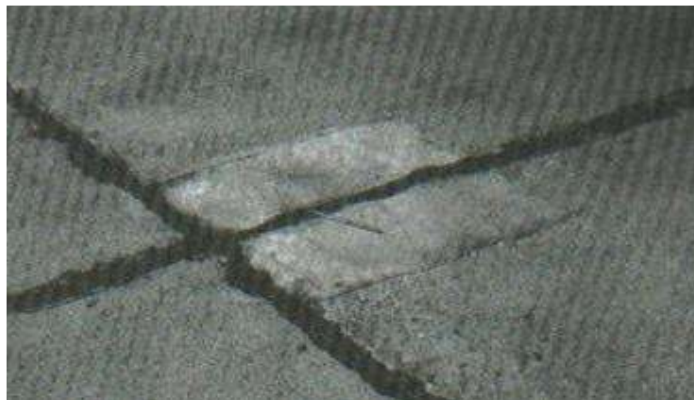
Fotografía N°10: Vista típica de parcheo pequeño de baja severidad
