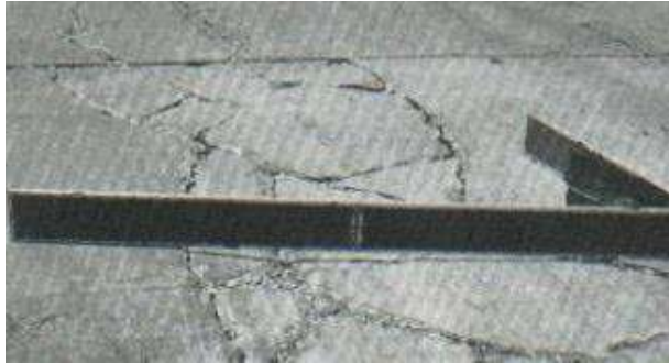
Fotografía N°14: : Vista típica de punzonamiento de alta severidad.
