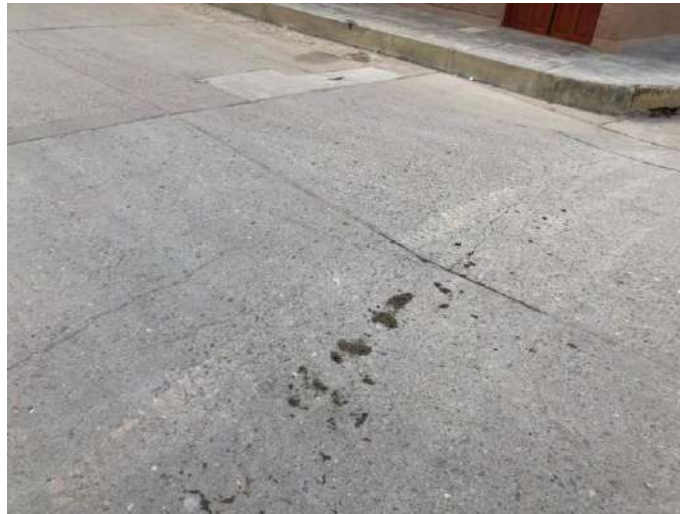
Fotografía N°22:Tramo 02 UM – 04 pulimiento de agregados y Parcheos grandes a lo largo de toda la vía
