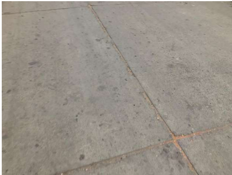
Fotografía N°43:Tramo 11 UM – 35 Popouts con grietas de retracción
