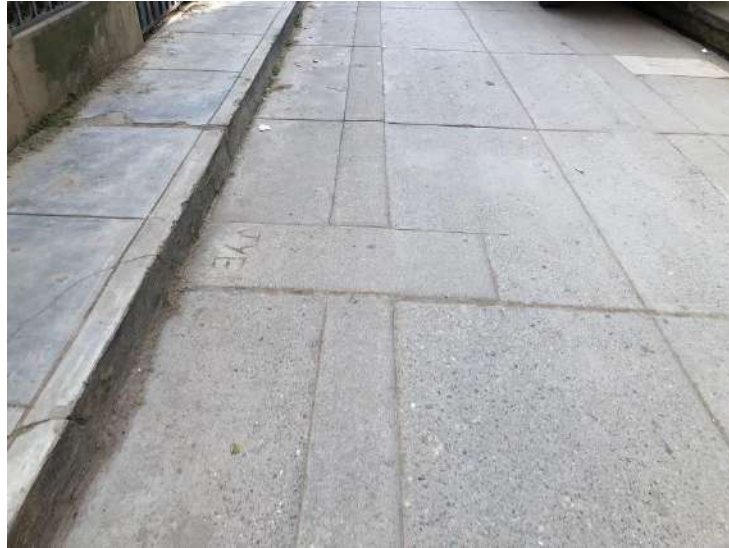
Fotografía N°27:Tramo 05 UM – 11 Parcheos pequeños y grandes a lo largo de toda la vía
