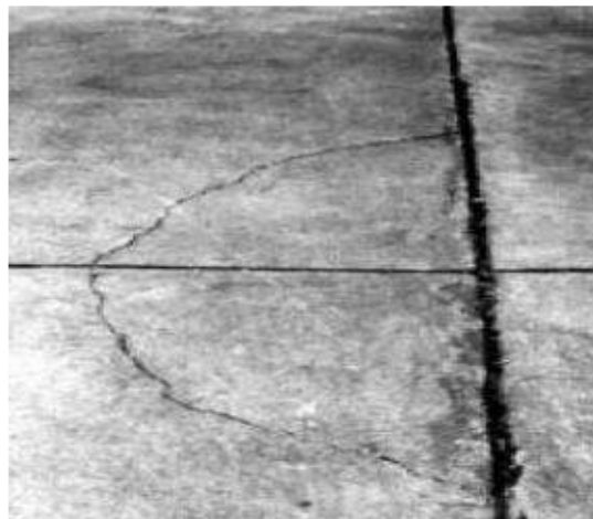
Fotografía N°02: Vista típica de una grieta en esquina de baja severidad
