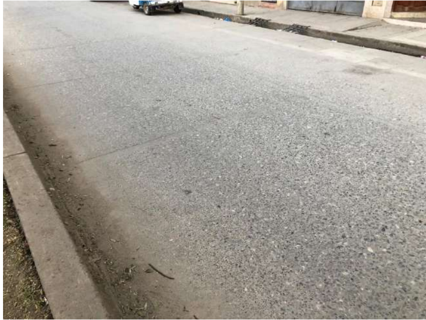
Fotografía N°36:Tramo 09 UM – 23 Pulimento de agregados con Parcheos grandes
