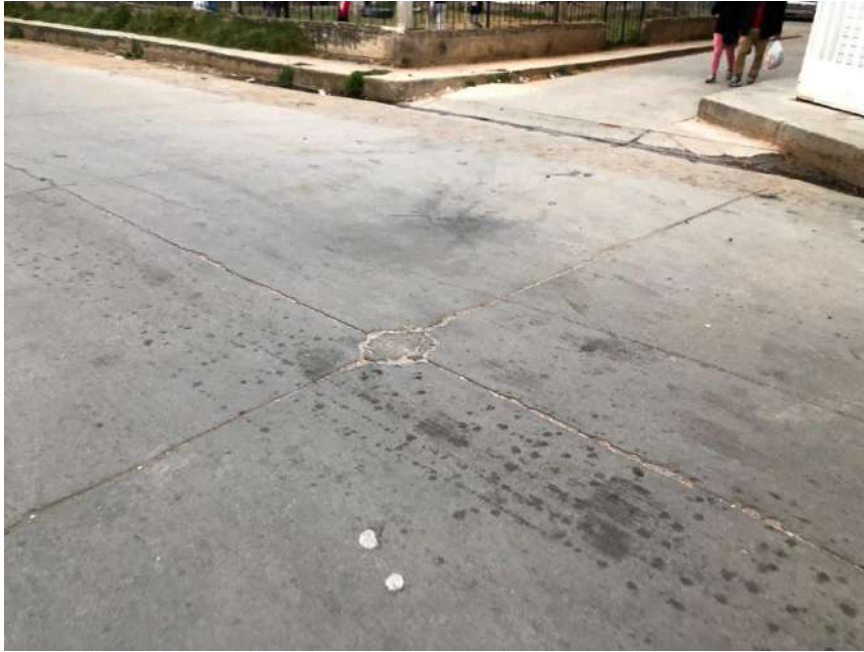
Fotografía N°44:Tramo 12 UM - 36 Grieta de esquina
