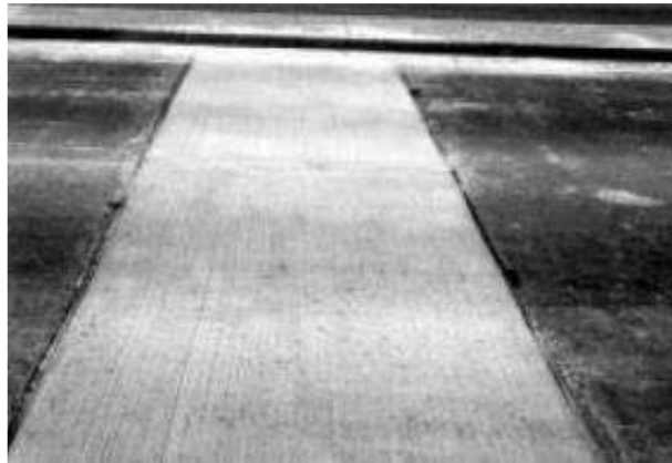
Fotografía N°09: Vista típica de parcheo mediano a mediana severidad
