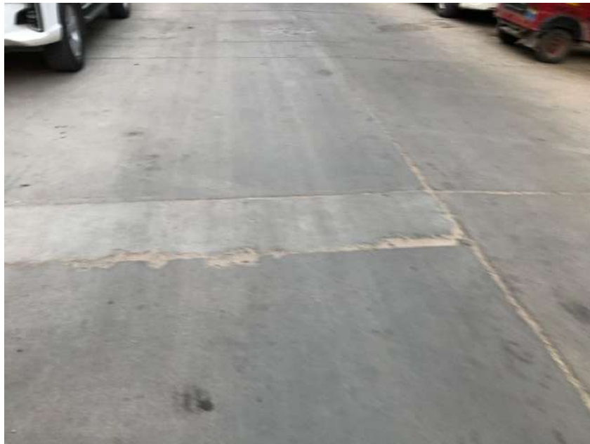
Fotografía N°45:Tramo 12 UM – 37 Parcheo grande con popouts
