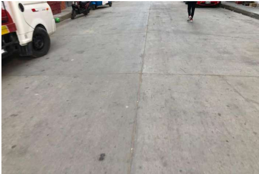
Fotografía N°47:Tramo 13 UM – 40 Vista de popouts
