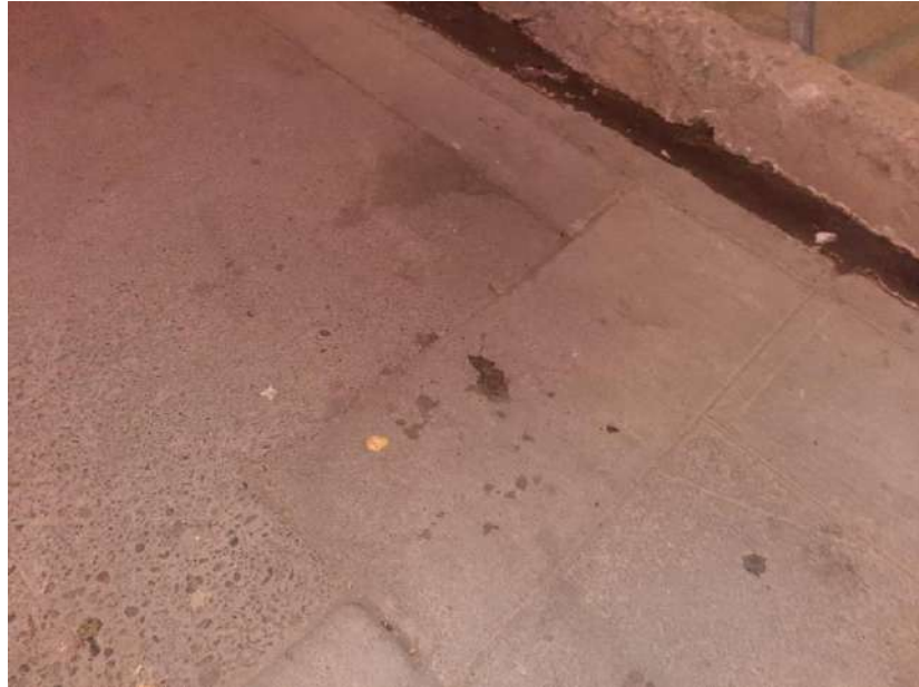
Fotografía N°54:Tramo 17 UM – 50 Pulimento de agregados con Parcheos grandes y pequeños
