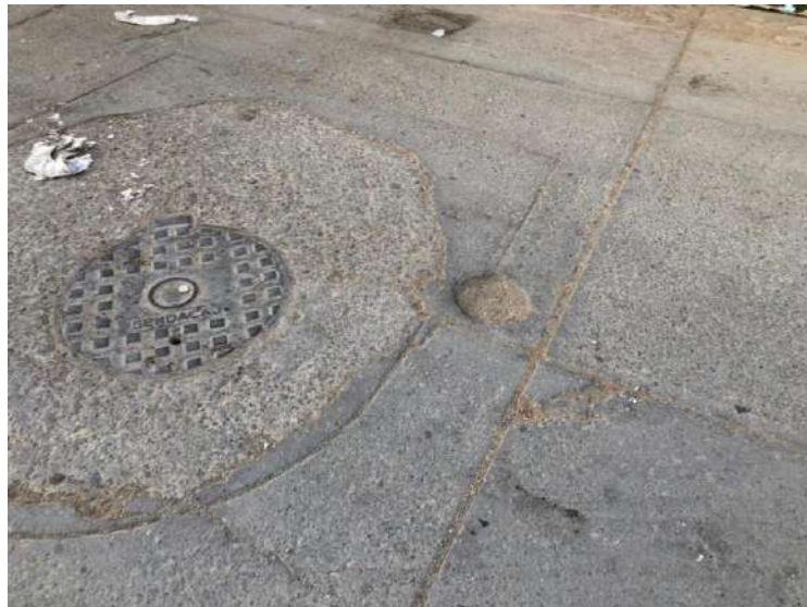
Fotografía N°24:Tramo 03 UM – 06 Descascaramiento de esquina
