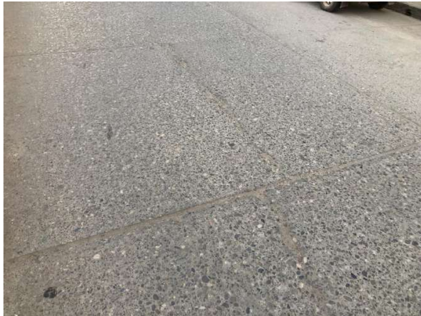
Fotografía N°37:Tramo 09 UM – 24 Pulimento de agregados con Parcheos grandes
