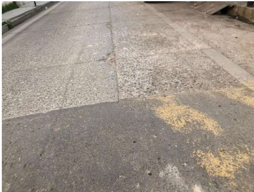
Fotografía N°30:Tramo 06 UM – 15 Pulimento de agregados con descascaramiento de junta
