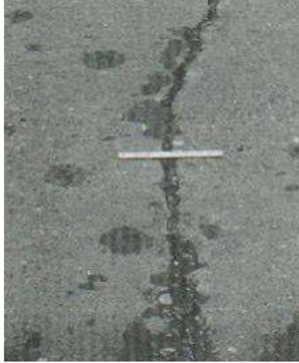
Fotografía N°08: Vista típica de grietas lineales de severidad media en losa de concreto reforzado
