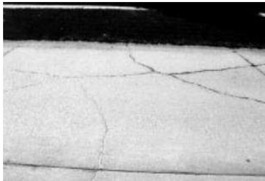
Fotografía N°03: Vista típica de una losa dividida de mediana severidad
