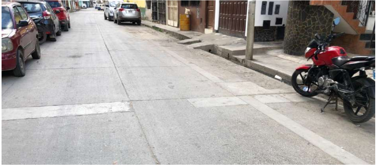
Fotografía N°20:Tramo 01 UM – 01 visibilidad de Parcheos grandes a lo largo de toda la vía
