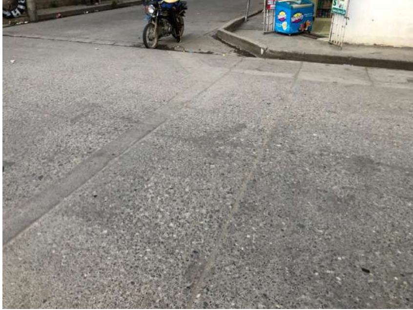
Fotografía N°38:Tramo 09 UM – 24 Pulimento de agregados con Parcheos grandes y pequeños
