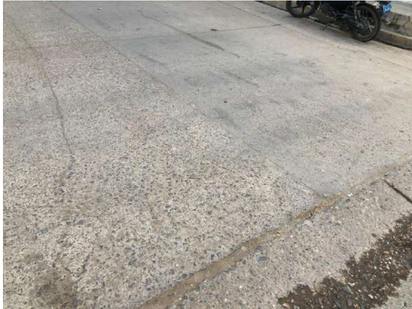
Fotografía N°42:Tramo 11 UM – 34 Pulimento de agregados con parcheos pequeños
