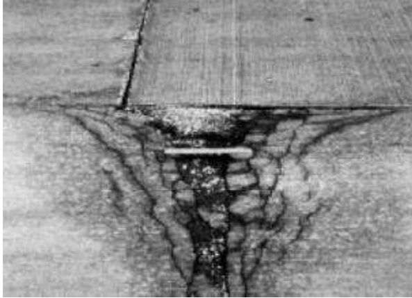
Fotografía N°04: Vista típica de una grieta de durabilidad de mediada severidad
