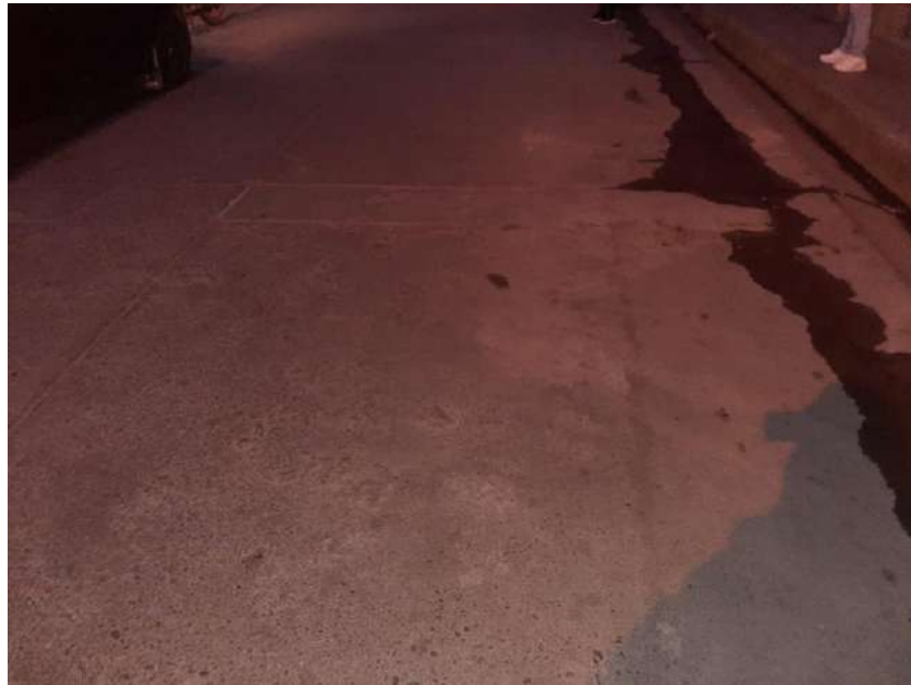
Fotografía N°55:Tramo 17 UM – 51 Desconchamiento con Parcheos grandes y pulimento de agregados
