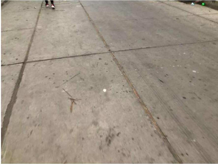
Fotografía N°48:Tramo 14 UM – 42 Vista de popouts
