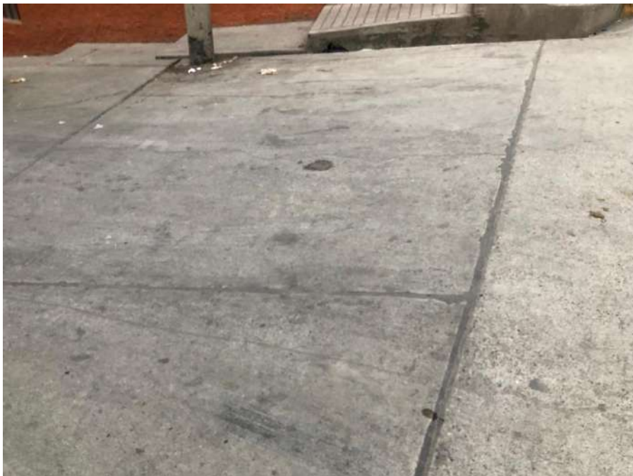
Fotografía N°49:Tramo 14 UM – 42 Popouts con grietas lineales
