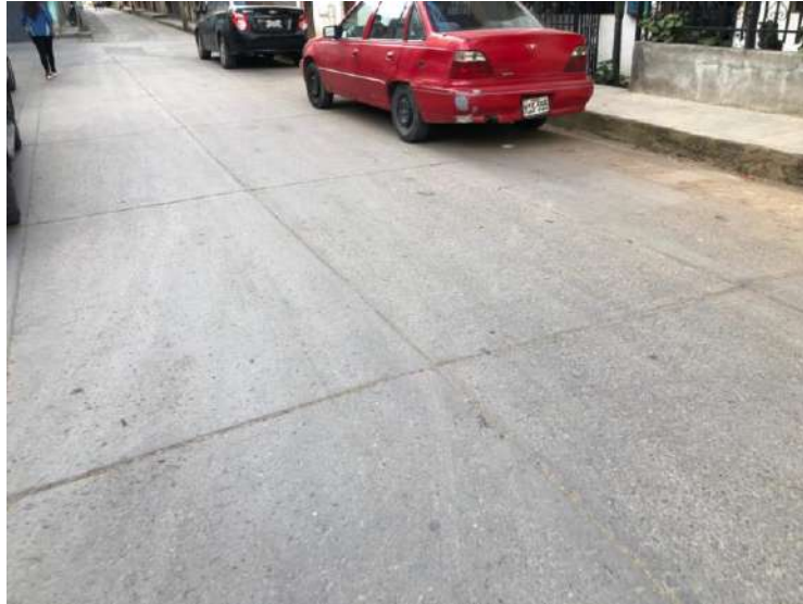
Fotografía N°23:Tramo 03 UM – 05 Parcheos grandes a lo largo de toda la vía
