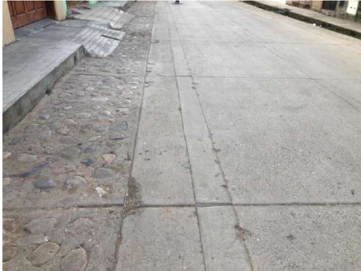
Fotografía N°21:Tramo 02 UM – 03 visibilidad de descascaramiento de esquina y Parcheos grandes a lo largo de toda la vía
