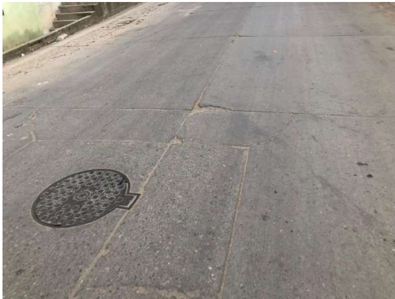
Fotografía N°32:Tramo 07 UM –17 Descascaramiento de equina con grietas lineales
