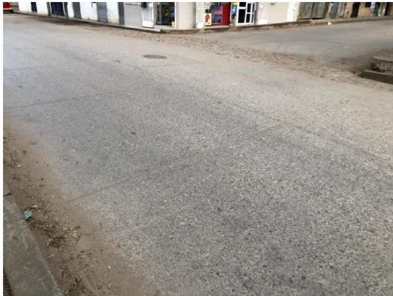
Fotografía N°34:Tramo 08 UM – 21 Pulimento de agregados con parcheo grande en buzón
