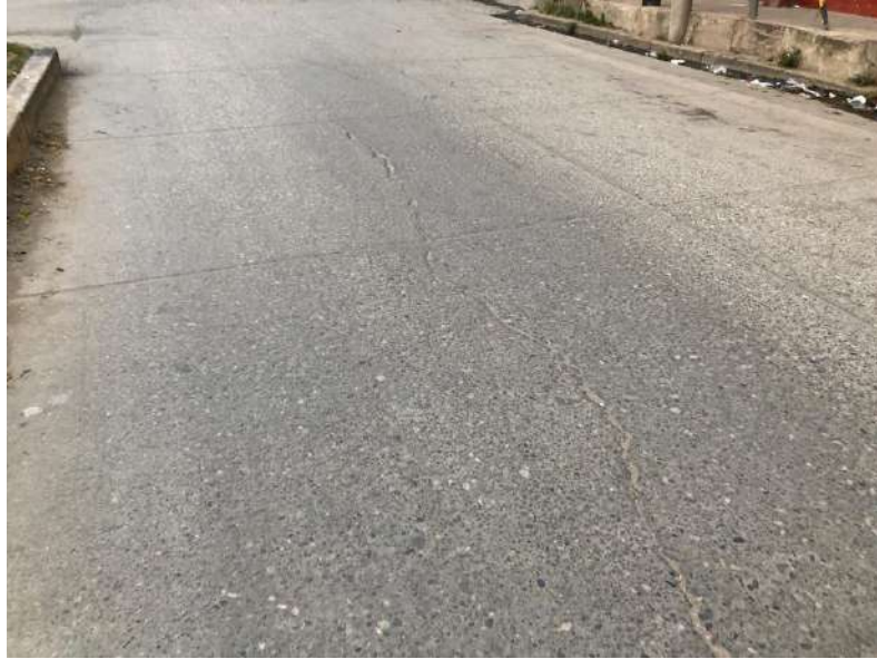
Fotografía N°41:Tramo 10 UM – 33 Pulimento de agregados con grietas lineales, además de parcheos pequeños
