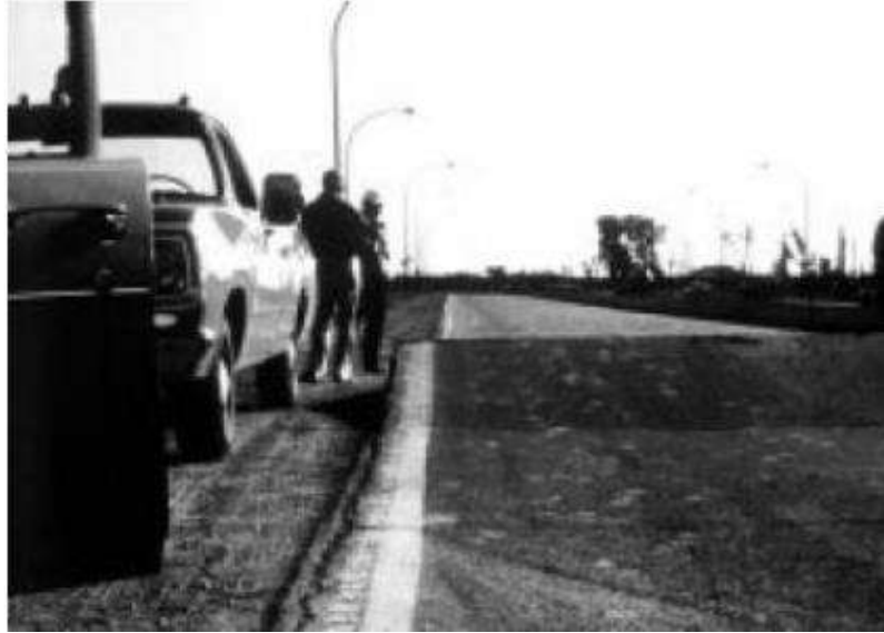
Fotografía N°01: Levantamiento de pavimento rígido de alta severidad
