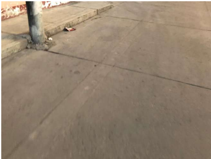
Fotografía N°57:Tramo 18 UM – 52 Parcheos pequeños
