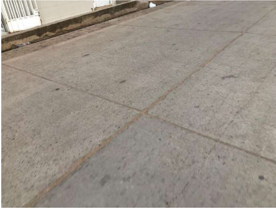
Fotografía N°46:Tramo 13 UM – 39 Pulimento de agregados con popouts
