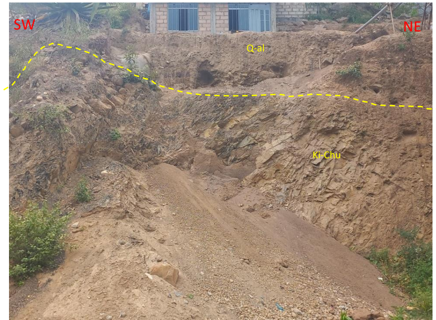
Figura 23. En la excavación para la construcción de vivienda se observan estratos de calizas de la Fm. Chuléec, oxidados por la alteración supérgena.
