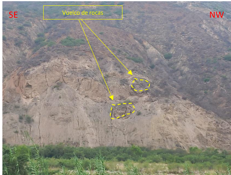
Figura 62. Vista de bloques desprendidos en el escarpe estructural kárstico de la Fm. Chuléec
