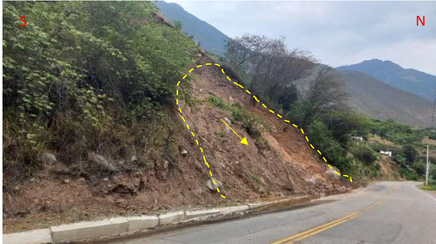
Figura 68. Deslizamiento rotacional al borde de la carretera que conduce del caserío La Viña al caserío Huaquillas
