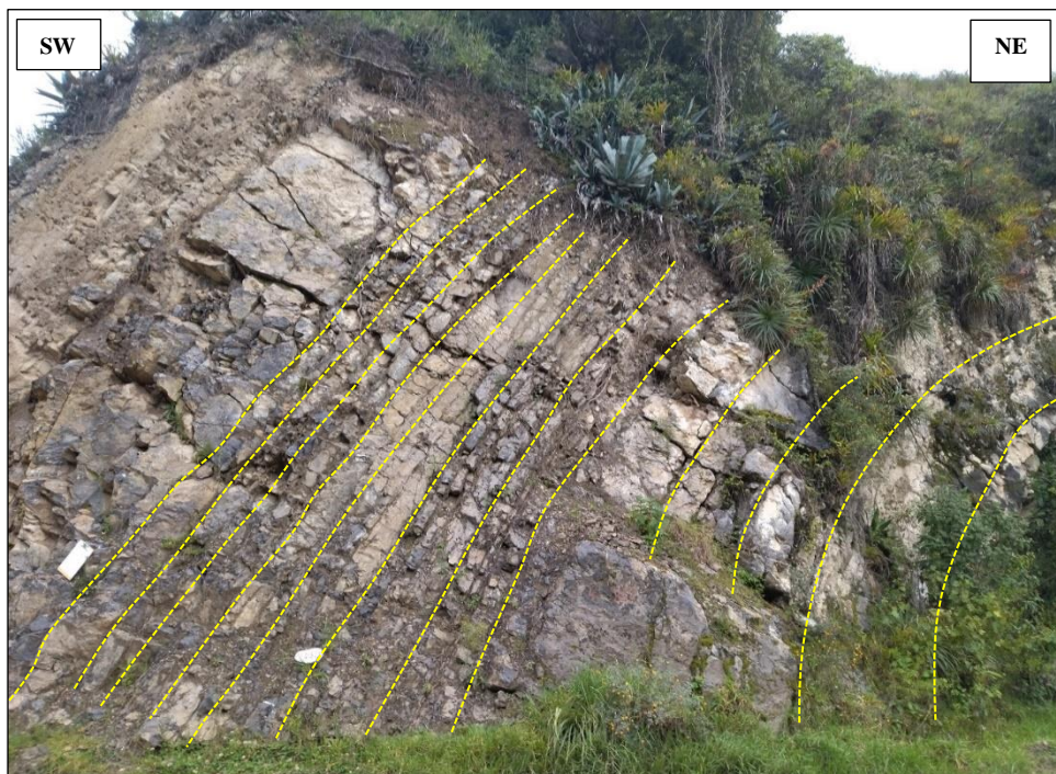
Foto 12: Plegamientos de anticlinal en estratos de la Formación Yumagual en la progresiva km 04 + 850. Coordenadas: E 785949, N9214714.
