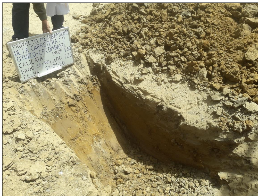
Foto 24: Exploración geotécnica del terreno de fundación de la plataforma de la carretera en el punto crítico N° 06.
