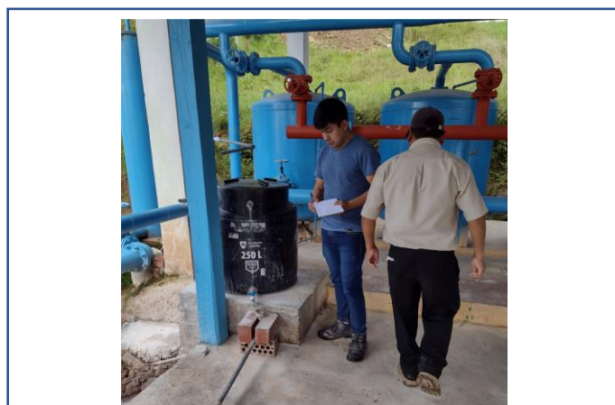
Fotografía 04: Vista tanque de dosificación de cloro.
