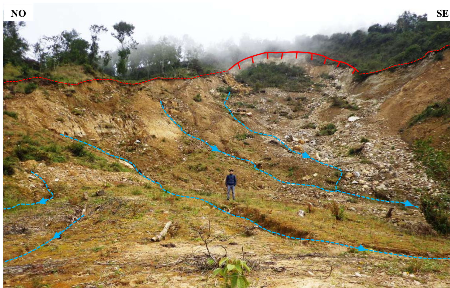
Foto 15. Deslizamiento activo (D-A) en la Estación N°5
