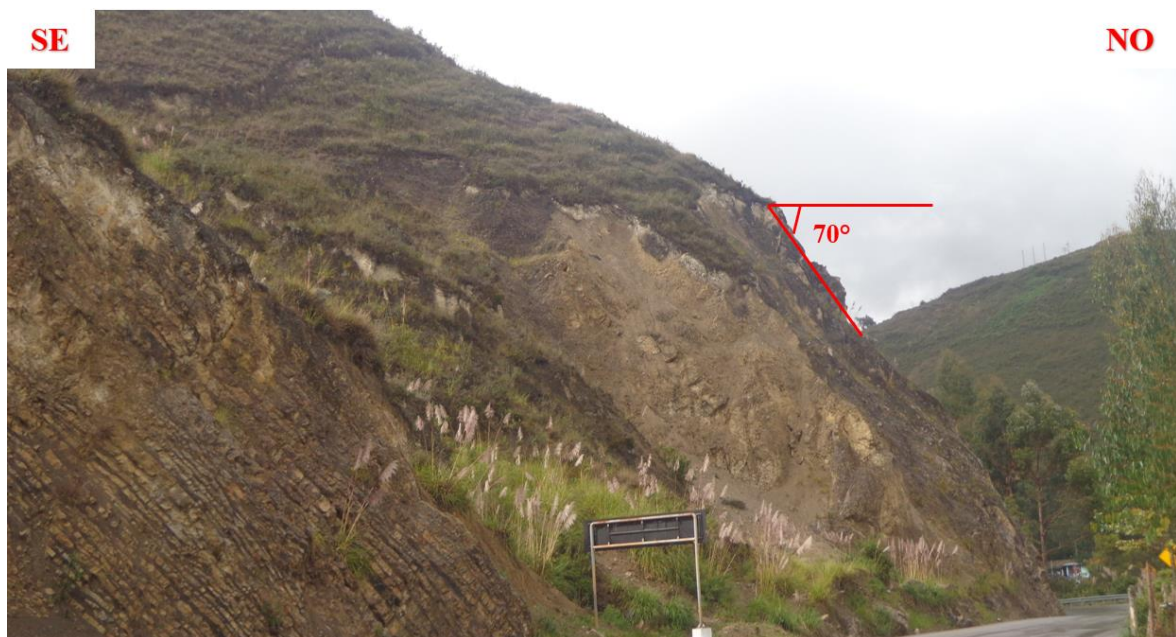
Foto 13. Escarpas en el margen izquierdo de la carretera La Encañada - Celendín con inclinación de 70°
