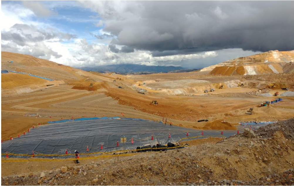
Figura 43. Vista panorámica del Pad de Lixiviación Carachugo Etapa 14
