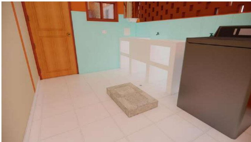
Figura N° 88: Error en la cota de tapa de la caja de registro de la Lavandería del Módulo de Vivienda
