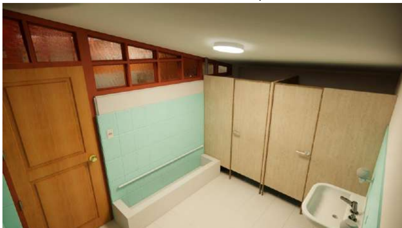
Figura N° 86: Gabinetes de inodoros sin iluminación en el SS.HH. de varones de la Sala de Usos Múltiples
