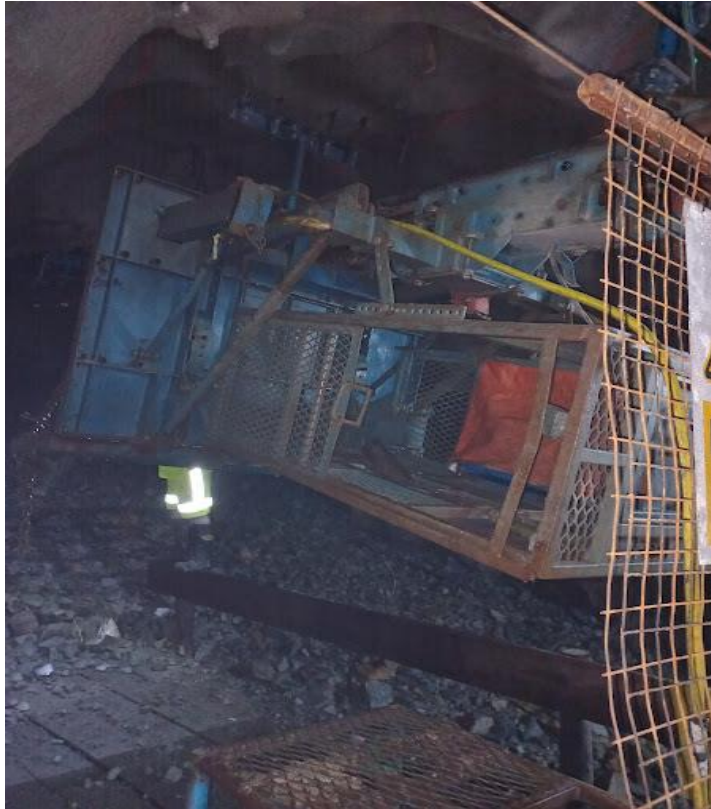
Foto 3. 7 Equipos de construcción de chimeneas Alimak (Jaula)
