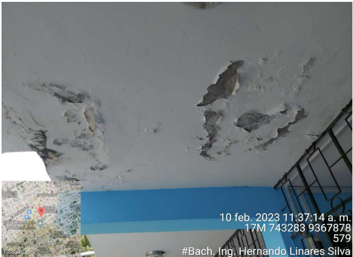
Foto 6: Presencia de humedad en losa aligerada del segundo nivel.
