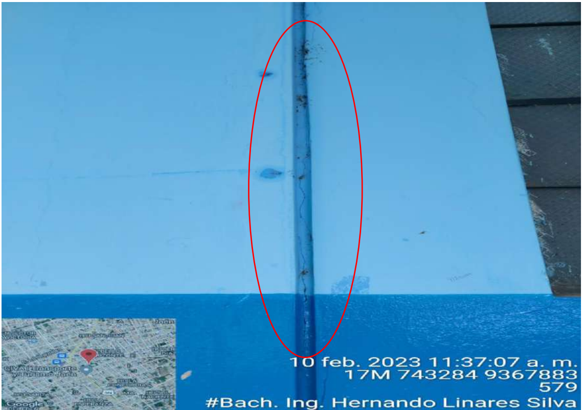
Foto 7: Presencia de fisura en junta de separación entre el Pabellón A y los SS. HH.
