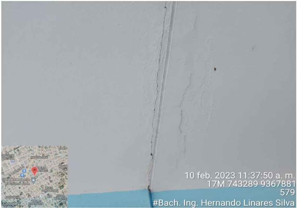
Foto 5: Presencia de fisura en losa aligerada.
