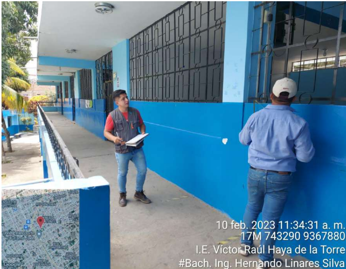
Foto 3: Verificación de situación actual, sin presencia de juntas.
