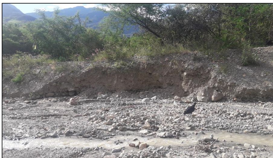
Figura 27. Punto de desborde N°1 de la quebrada Cujaca
