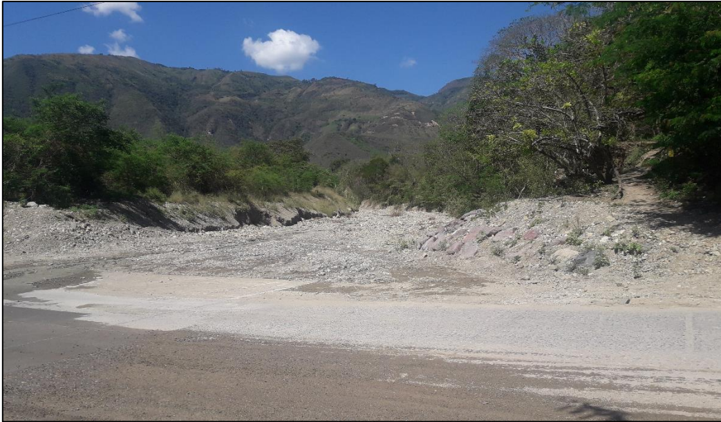
Fotografía 1. Muestra el badén existente en la vía FBT y el cauce de la quebrada Cujaca aguas arriba.
