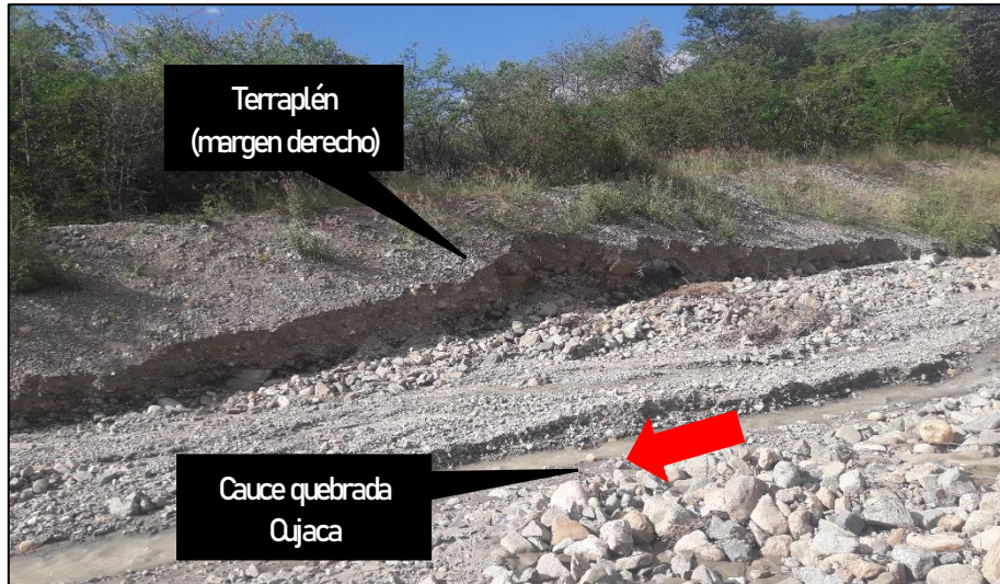
Figura 28. Talud inestable de terraplén en la quebrada Cujaca
