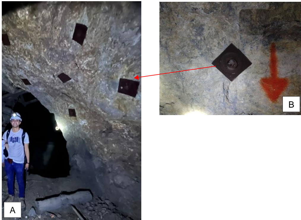
Figura 3.47. A. Anclajes sistemáticos - split set, distribuidos en el hastial derecho y clave, de la labor. B. Detalle del anclaje mecánico, constituido por: Arandela, placa de reparto cuadrada, turca y perno de anclaje, ubicado el PI. + 523 m.
