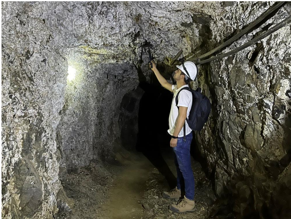
Figura 3.19. Zona de by-pass, afectada por la humedad constante en toda la sección subterránea, desde Punto Inicial de by-pass (Plp). + 69 m. hasta Plp. + 143.50 m.
