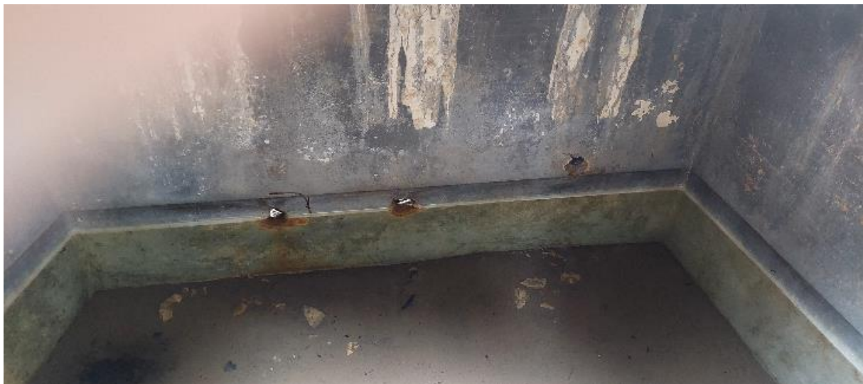
Foto 02: Vista interior de del afluente.
