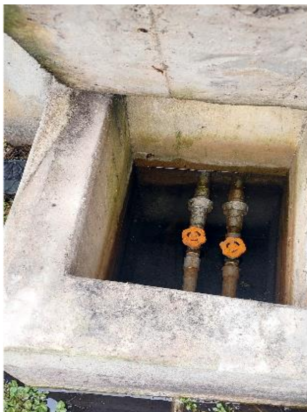
Foto 06: Vista de caja de llaves de La captacion.
