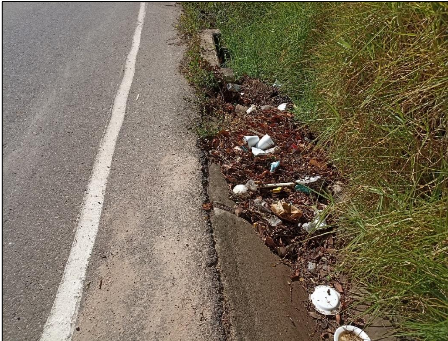
Figura 36: Alcantarillas totalmente obstruidas
