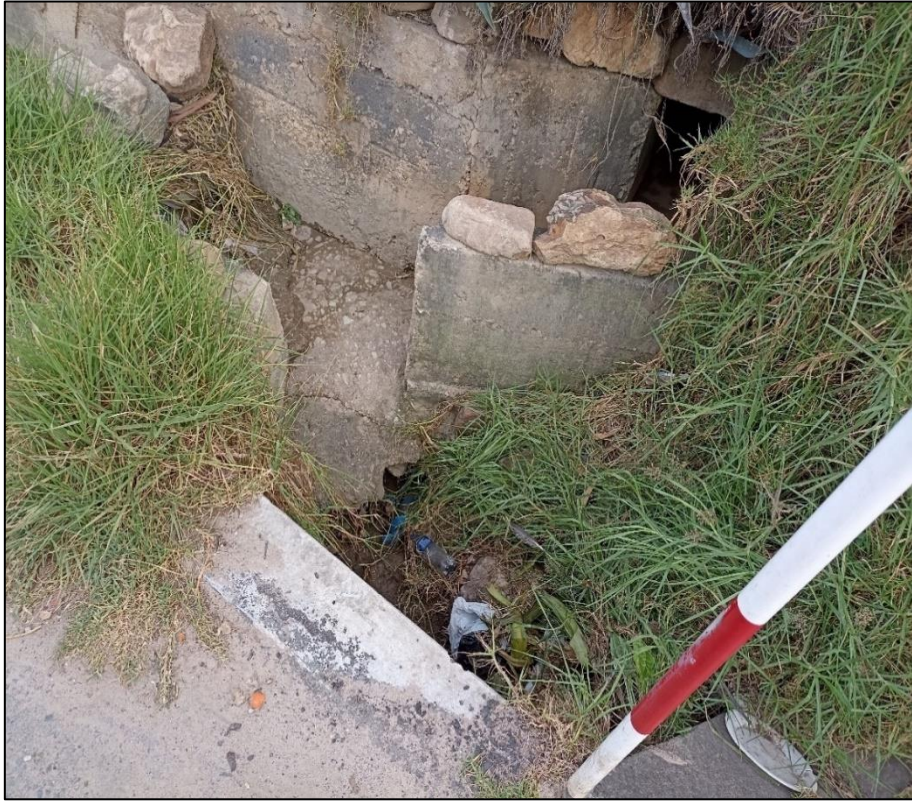
Figura 35: Alcantarillas sin mantenimiento
