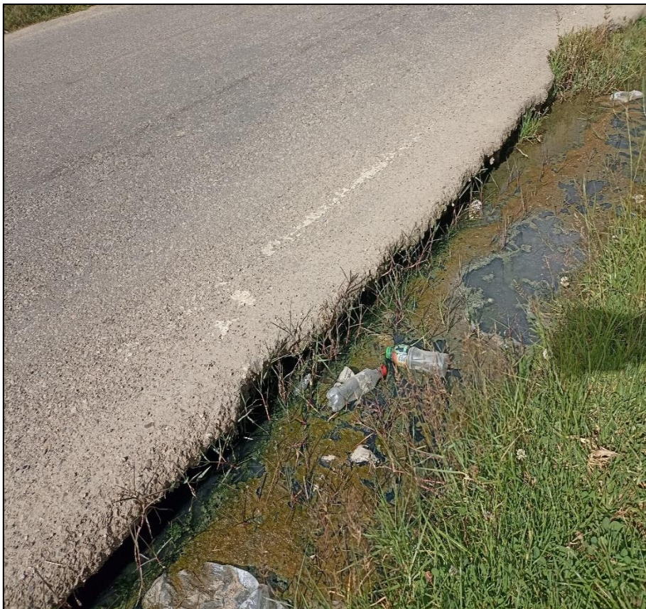
Figura 32: Cunetas rectangulares totalmente obstruidas
