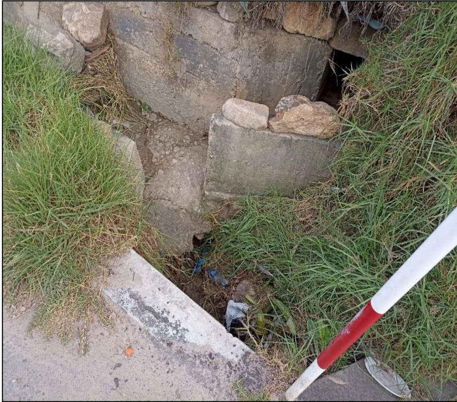
Figura 35: Alcantarillas sin mantenimiento
