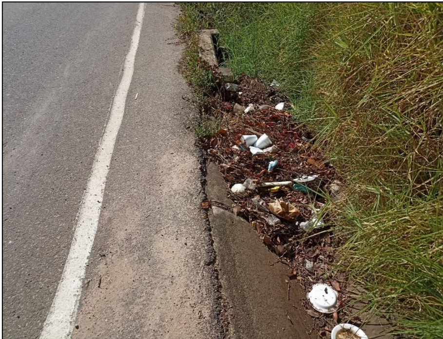
Figura 36: Alcantarillas totalmente obstruidas
