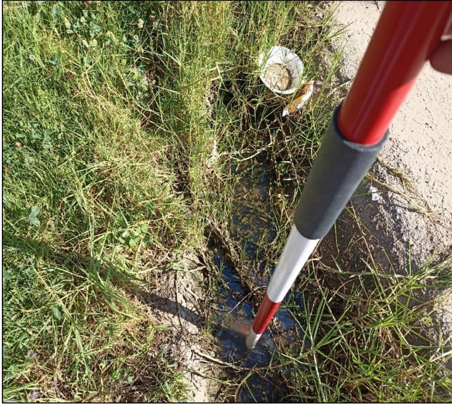
Figura 33: Cunetas triangulares totalmente obstruidas
