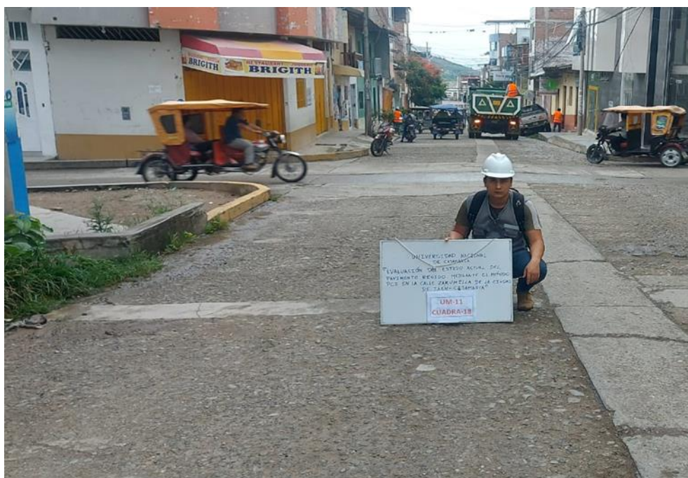
Figura 113 Inspección de las fallas en la unidad de muestreo 11 de la cuadra N° 18 entre la progresiva 0+014.50 – 0+019.70
