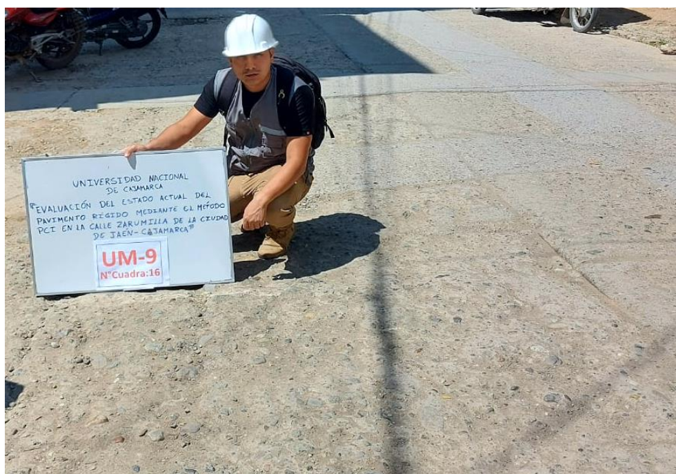
Figura 111 Inspección de las fallas en la unidad de muestreo 09 de la cuadra N° 17 entre la progresiva 0+033.95 – 0+039.05.
