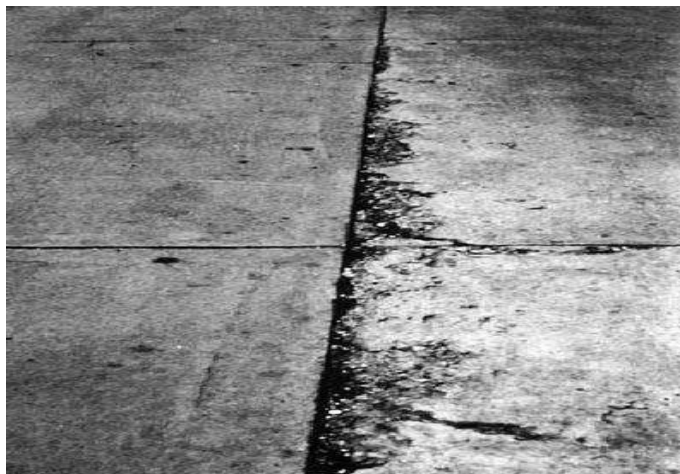
Figura 49 Descascaramiento de Junta – Baja Severidad
