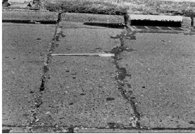
Figura 36 Punzonamiento – Baja Severidad
