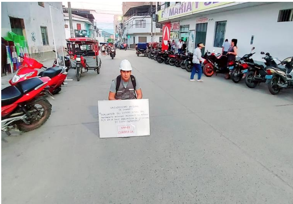
Figura 104 Inspección de la falla en la unidad de muestreo 03 de la cuadra N° 14 entre la progresiva 0+020.25 – 0+023.80.
