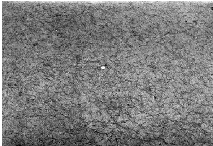
Figura 42 Descascamiento, Mapa de Fisuras, Craquelado – Baja Severidad
