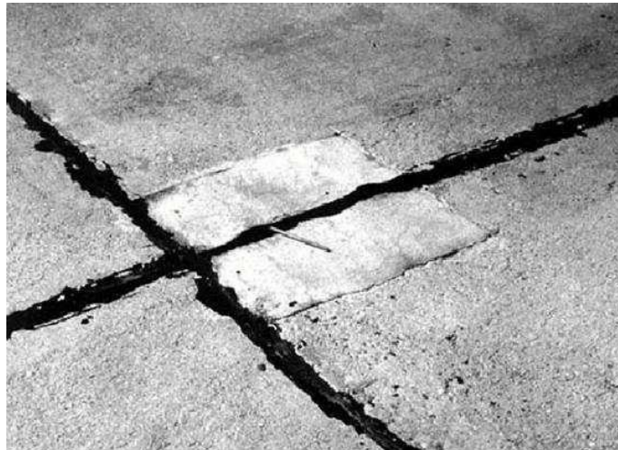
Figura 29 Parches Pequeños – Baja Severidad
