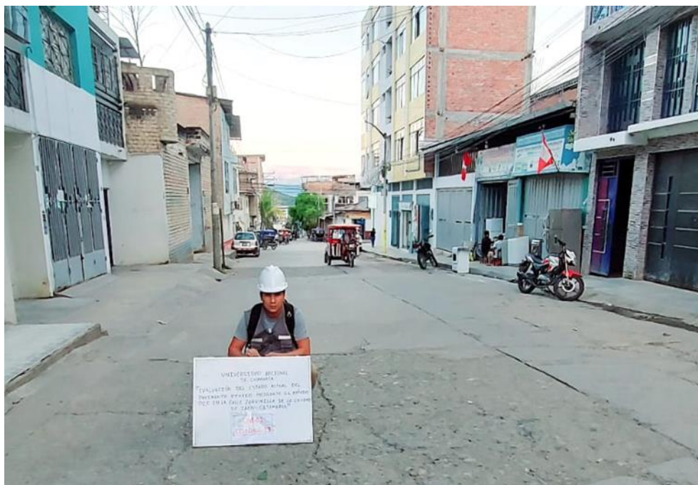
Figura 102 Inspección de las fallas en la unidad de muestreo 01 de la cuadra N° 13 entre la progresiva 0+023.10 – 0+028.80.
