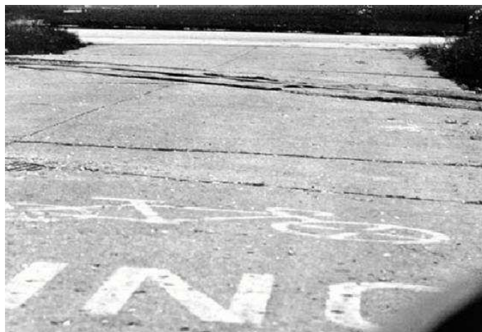
Figura 40 Cruce de Vía Férrea – Mediana Severidad
