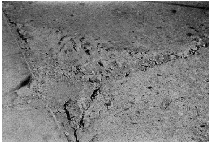
Figura 48 Descascaramiento de Esquina – Alta Severidad
