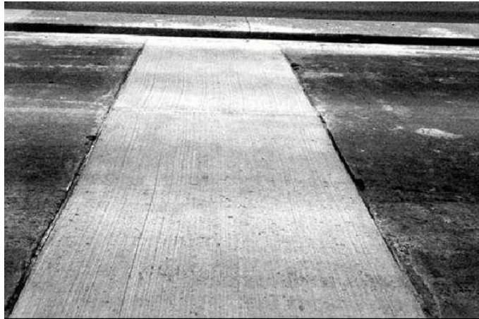
Figura 26 Parches Grandes y Acometidas de Servicios Públicos – Baja Severidad
