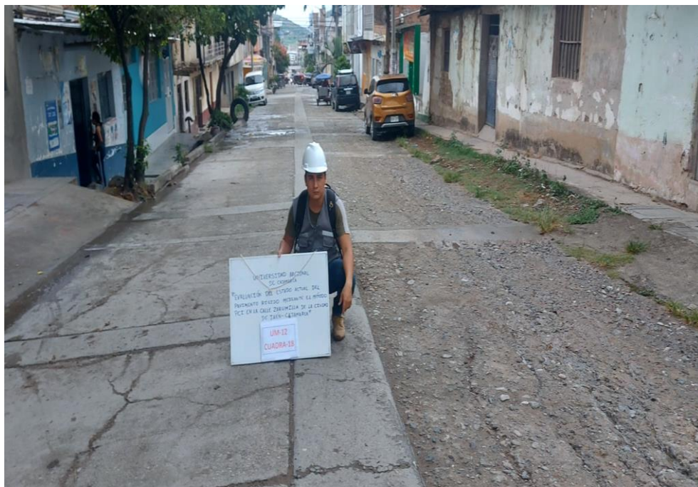
Figura 114 Inspección de las fallas losa dividida de severidad alta en la unidad de muestreo 12 de la cuadra N° 18 entre la progresiva 0+053.55 – 0+058.75
