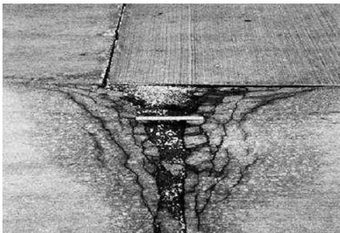
Figura 11 Fisura de Durabilidad – Baja Severidad
