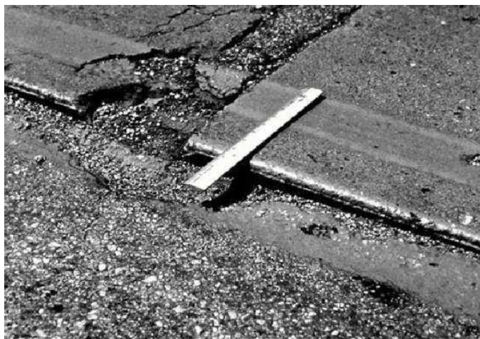
Figura 21 Desnivel Carril-Berma – Mediana Severidad
