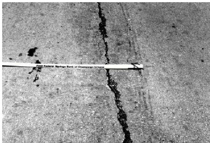
Figura 24 Fisura Lineal – Mediana Severidad
