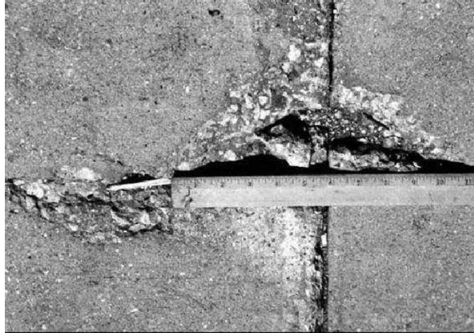
Figura 47 Descascaramiento de Esquina – Mediana Severidad
