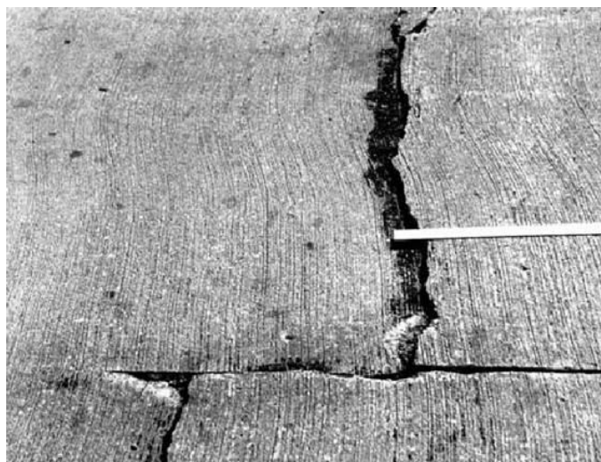
Figura 25 Fisura Lineal – Alta Severidad
