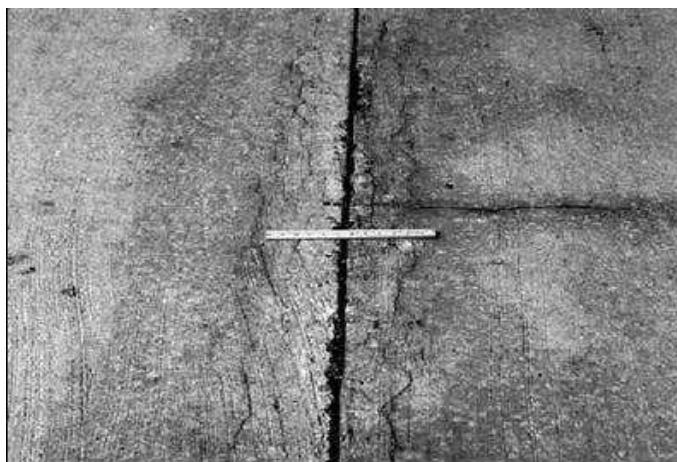
Figura 12 Fisura de Durabilidad – Mediana Severidad
