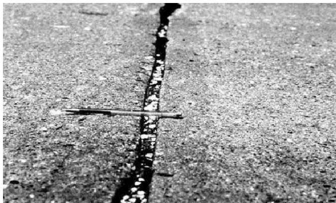
Figura 19 Daño en el Sello de la Junta – Alta Severidad
