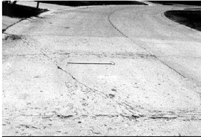
Figura 13 Fisura de Durabilidad – Alta Severidad
