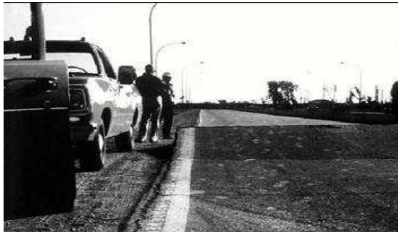
Figura 4 Levantamiento/Pandeo – Alta Severidad
