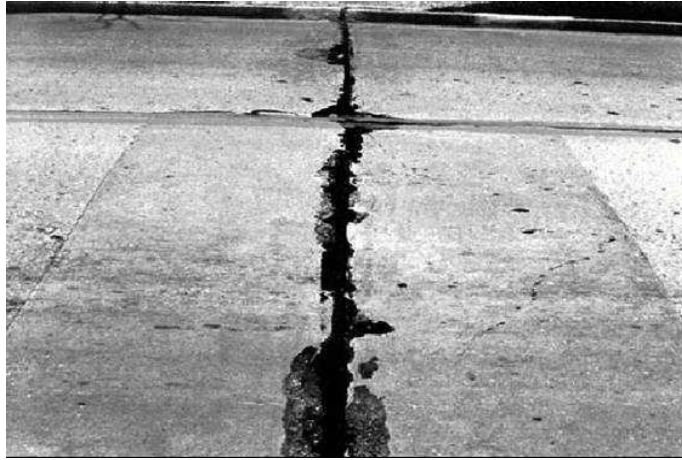
Figura 17 Daño en el Sello de la Junta – Baja Severidad
