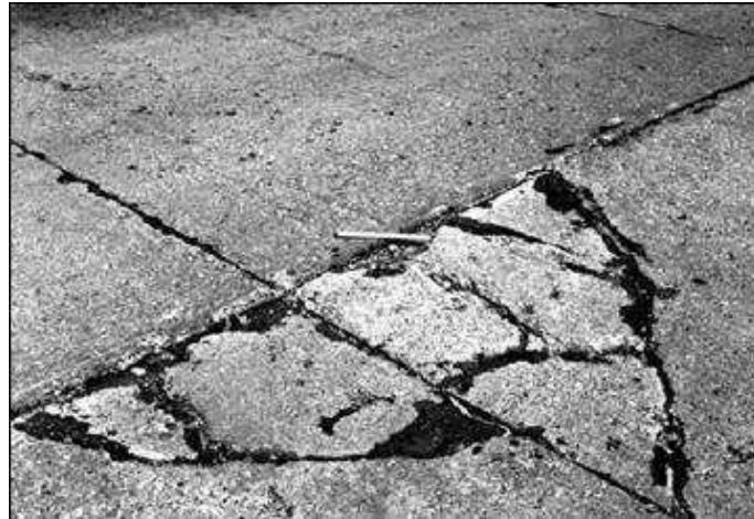
Figura 7 Fractura de Esquina – Alta Severidad
