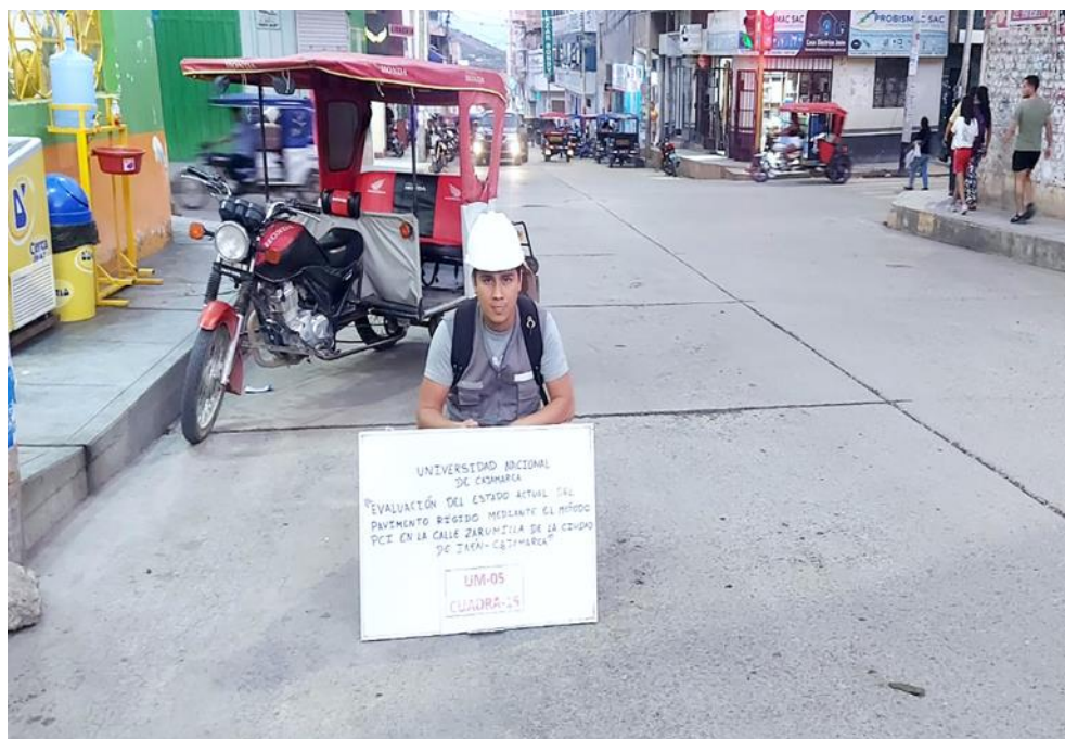
Figura 106 Inspección de las fallas en la unidad de muestreo 05 de la cuadra N° 15 entre la progresiva 0+000 – 0+003.60.
