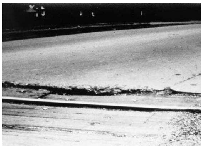
Figura 41 Cruce de Vía Férrea – Alta Severidad
