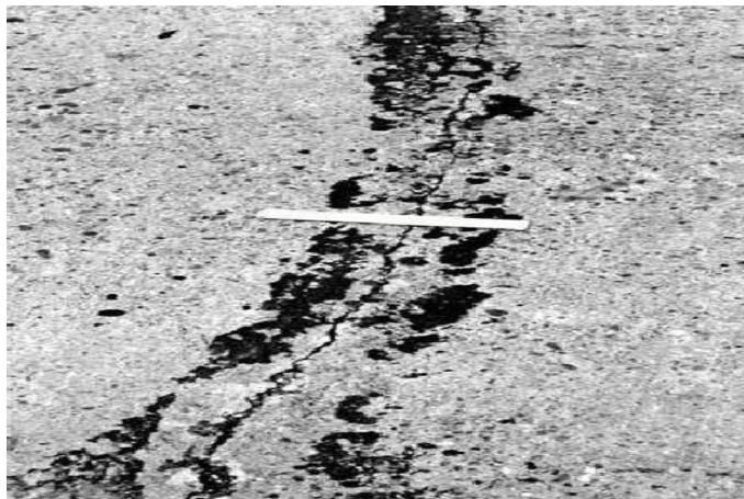
Figura 23 Fisura Lineal – Baja Severidad
