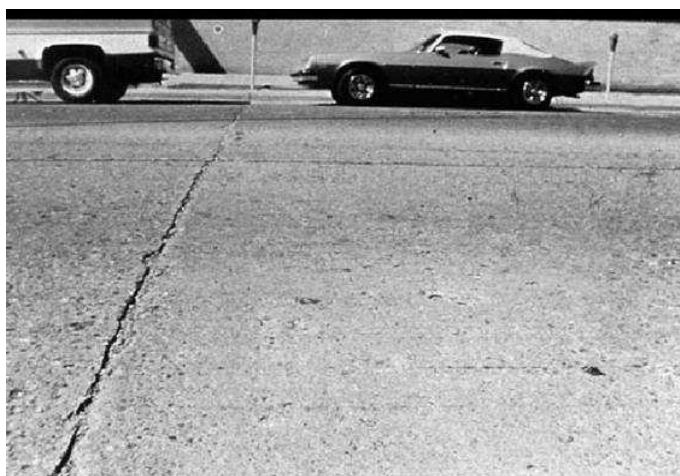
Figura 50 Descascaramiento de Junta – Mediana Severidad
