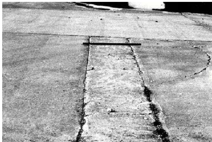
Figura 27 Parches Grandes y Acometidas de Servicios Públicos –Mediana Severidad
