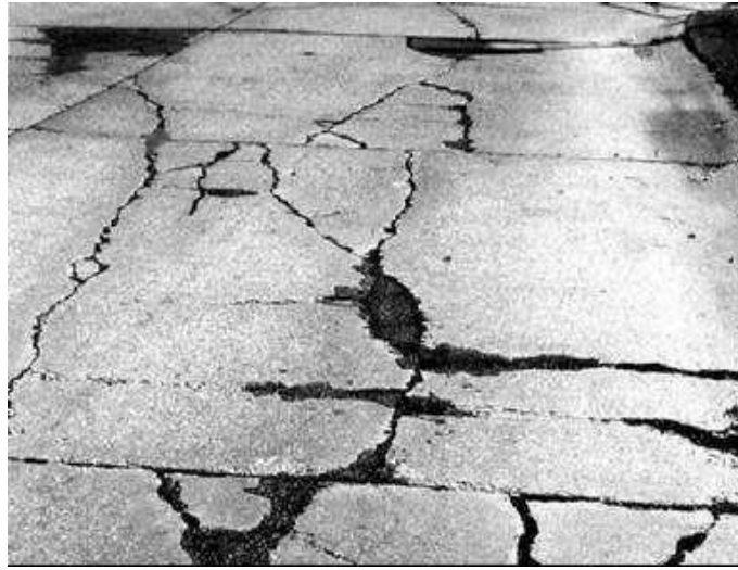
Figura 10 Losa Dividida – Alta Severidad
