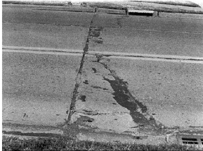
Figura 37 Punzonamiento – Mediana Severidad
