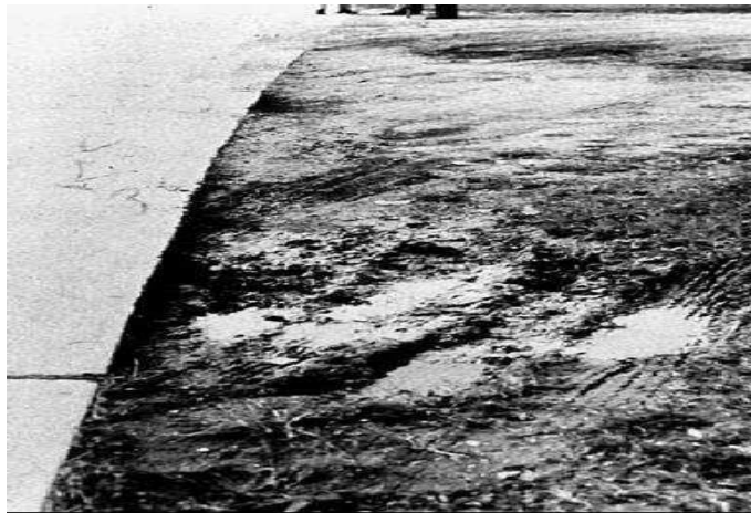
Figura 20 Desnivel Carril-Berma – Baja Severidad
