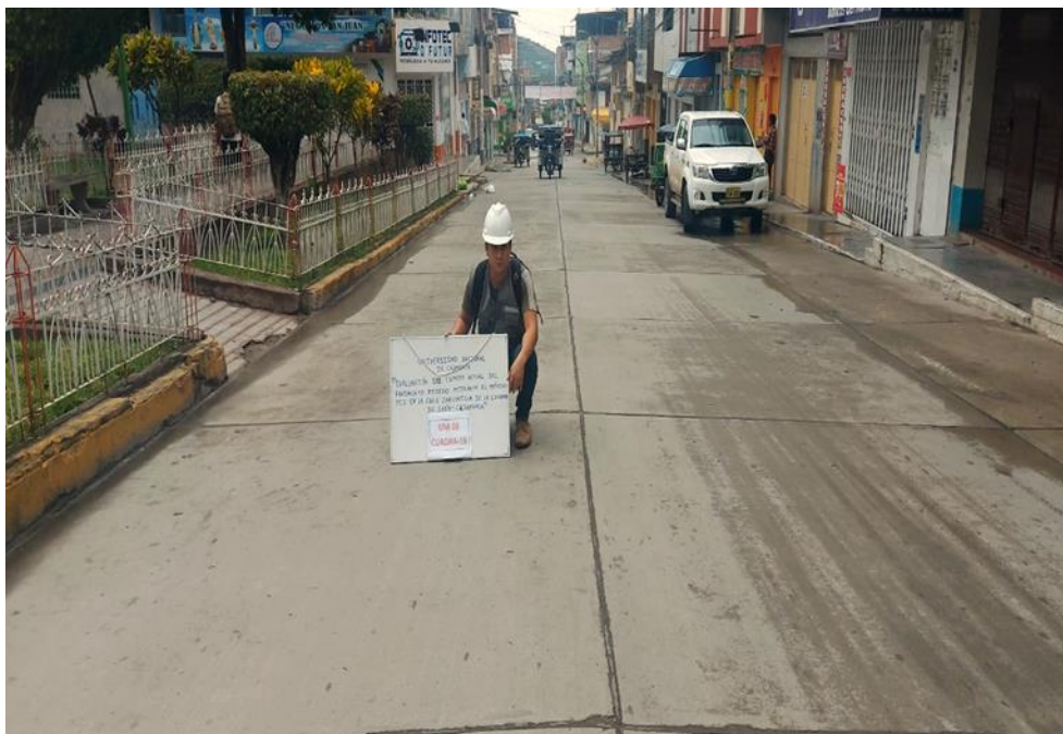
Figura 108 Inspección de las fallas en la unidad de muestreo 07 de la cuadra N° 16 entre la progresiva 0+035.20 – 0+038.40
