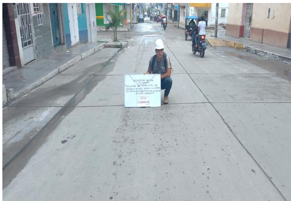
Figura 107 Inspección de la falla en la unidad de muestreo 06 de la cuadra N° 16 entre la progresiva 0+016.00 – 0+019.20.
