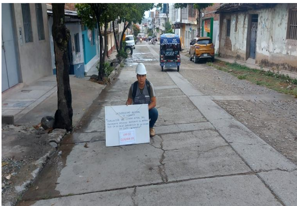
Figura 115 Inspección de la falla losa dividida de severidad alta en la unidad de muestreo 12 de la cuadra N° 18 entre la progresiva 0+053.55 – 0+058.75
