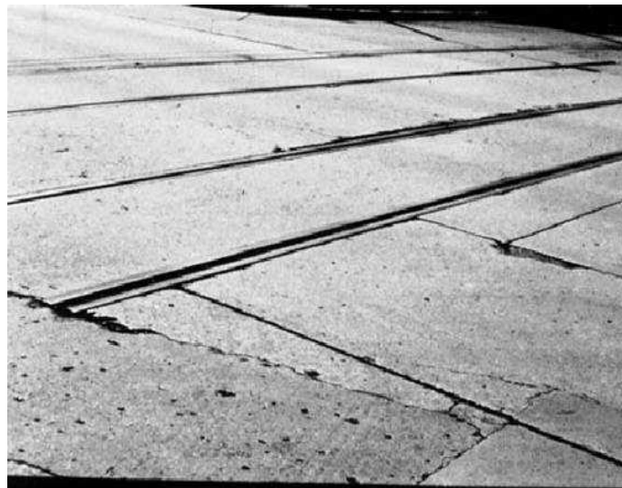
Figura 39 Cruce de Vía Férrea – Baja Severidad
