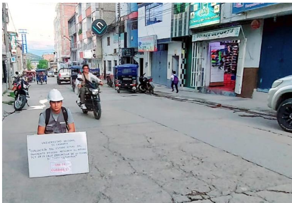
Figura 103 Inspección de las fallas en la unidad de muestreo 02 de la cuadra N° 13 entre la progresiva 0+077.85 – 0+083.05
