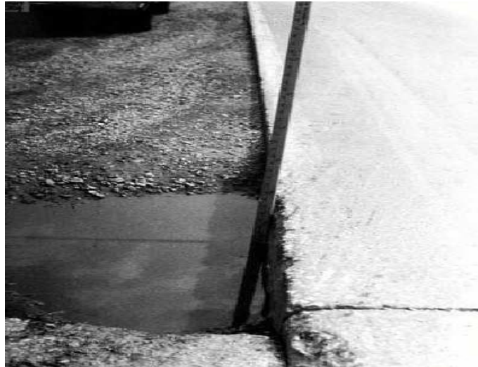
Figura 22 Desnivel Carril-Berma – Alta Severidad
