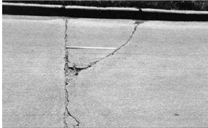
Figura 5 Fractura de Esquina – Baja Severidad
