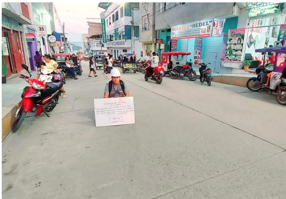
Figura 105 Inspección de la falla en la unidad de muestreo 04 de la cuadra N° 14 entre la progresiva 0+037.65 – 0+041.10.
