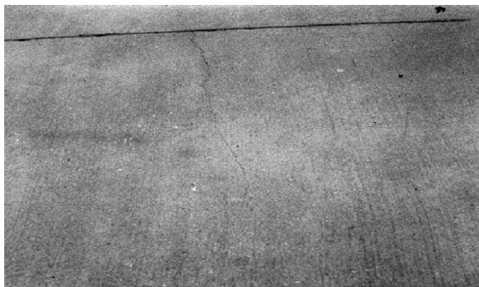
Figura 45 Fisuras de Contracción
