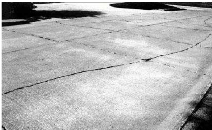
Figura 8 Losa Dividida – Baja Severidad
