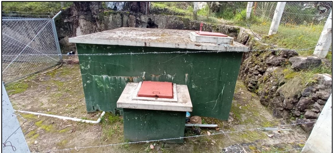
Figura 12: Vista del reservorio de concreto armado- con presencia de filtraciones.
