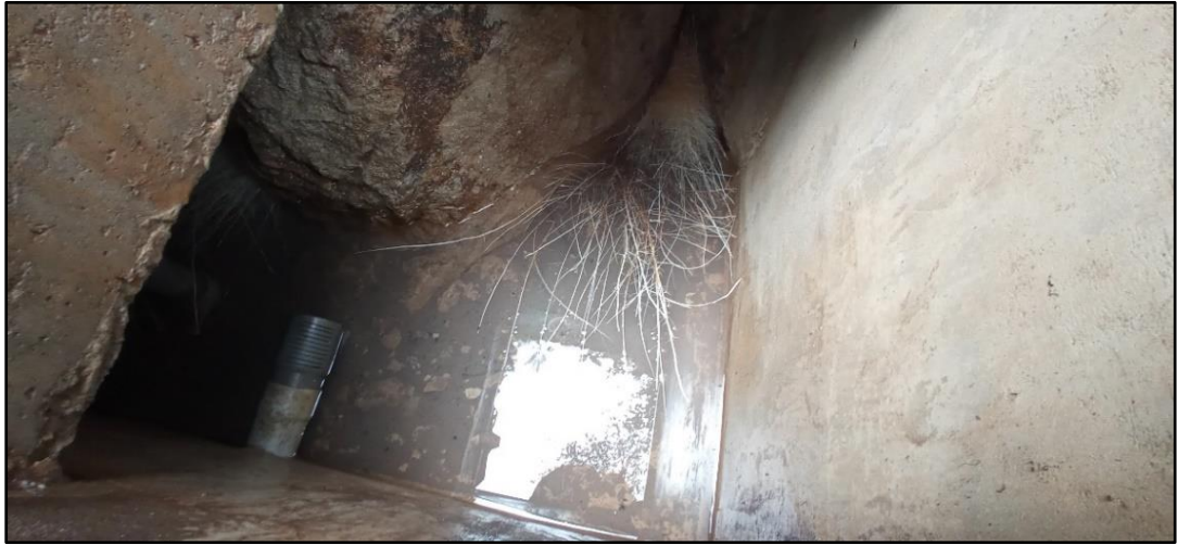
Figura 11: Vista cámara humedad con presencia de raíces-Captación Yerba santa.
