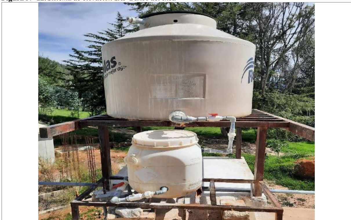
Figura N° 12: Sistema de cloración SAP Baños del Inca
