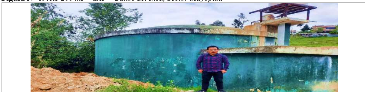
Figura N° 09: R1 200 m 3 – SAP – Baños del Inca, Sector Mayopata
