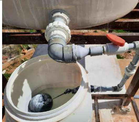
Fotografía N° 14: Recipiente con el flotador, del sistema de cloración.
