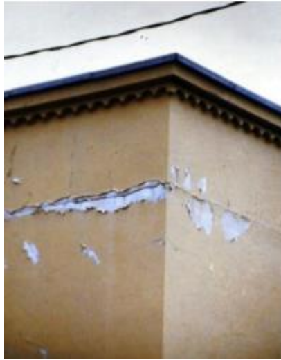
Figura 2 Fisuras por dilatación y contracción por temperatura
