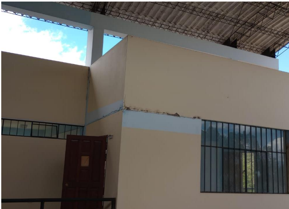
Fotografía N° 6 Vista de una de las patologías de mayor gravedad
