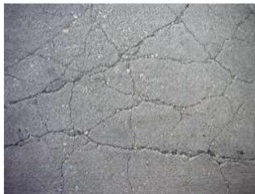
Figura 1 Grietas capilares o cuarteaduras
