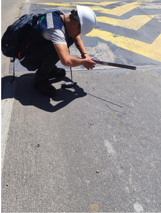
Fotografía 53: Deterioro superficial de tipo Descascaramiento (D)
