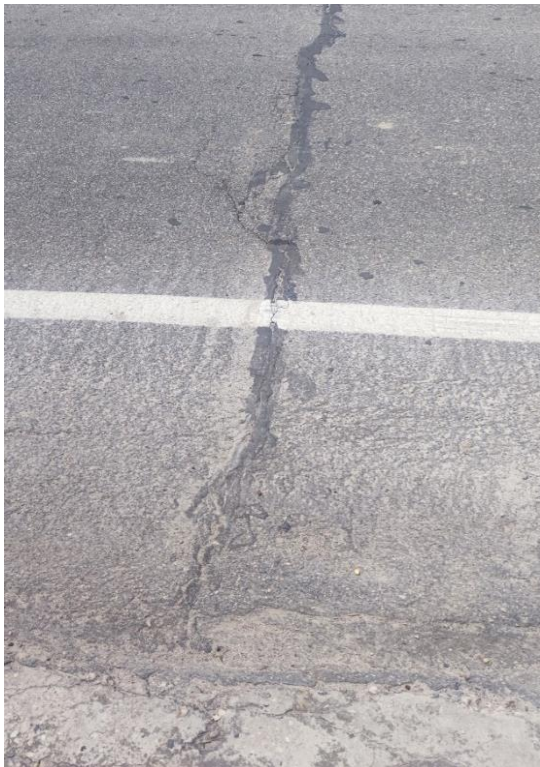
Fotografía 35: Deterioro superficial en la progresiva Km: 12+900.00 - 13+000.00 del carril derecho deterioro Fisura transversal de junta de construcción (FTJ) M-65
