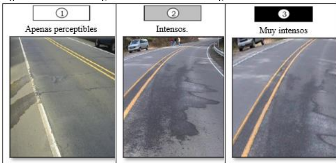
Figura 2. 20. Niveles de gravedad afloramiento de agua
