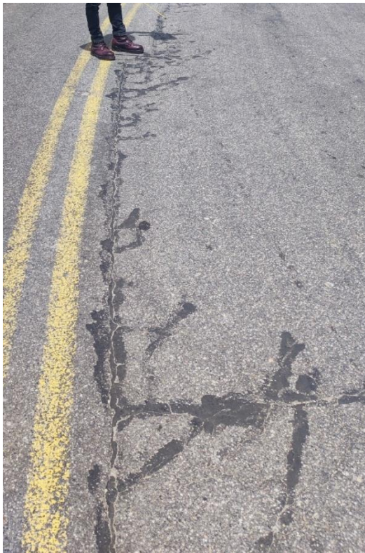
Fotografía 55: Deterioro superficial de tipo Fisuración longitudinal por fatiga (FLF)
