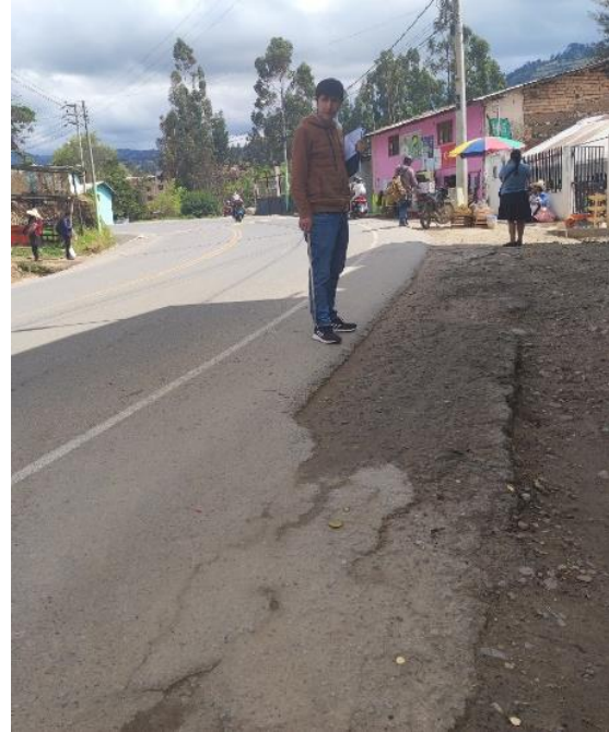
Fotografía 10: Deterioro superficial en el carril derecho de la progresiva 6+200.00 - 6+300.00 desintegración de los bordes del pavimento. M-3
