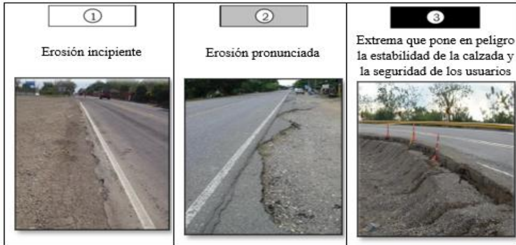
Figura 2. 23. Niveles de gravedad erosión de las bermas
