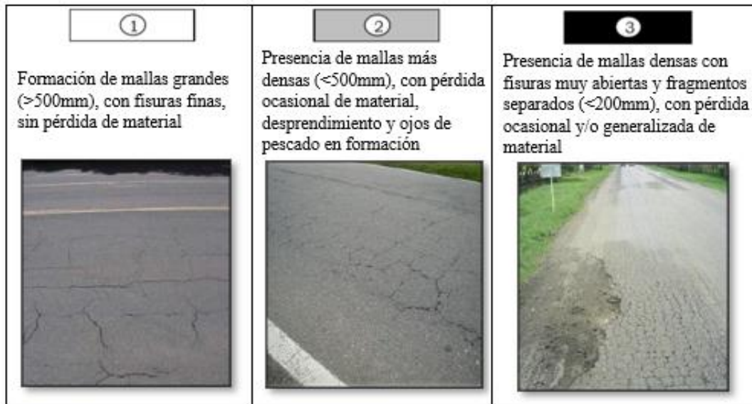
Figura 2. 6. Niveles de gravedad de fisuras piel de cocodrilo
