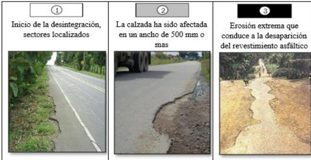
Figura 2. 21. Niveles de gravedad desintegración de borde del pavimento
