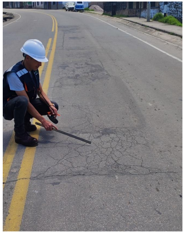
Fotografía 52: Deterioro superficial de tipo Fisuración piel de cocodrilo (FPC)
