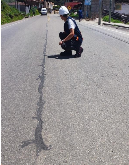
Fotografía 37: Medición de deterioro superficial en la progresiva Km: 13+600.00 - 13+700.00 carril derecho fisura longitudinal por fatiga (FLF) M-77.
