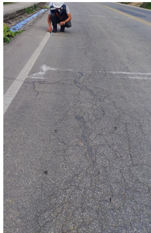
Fotografía 48: Deterioro superficial de tipo Fisuración piel de cocodrilo (FPC) Km: 13+000.00 - 14+000.00
