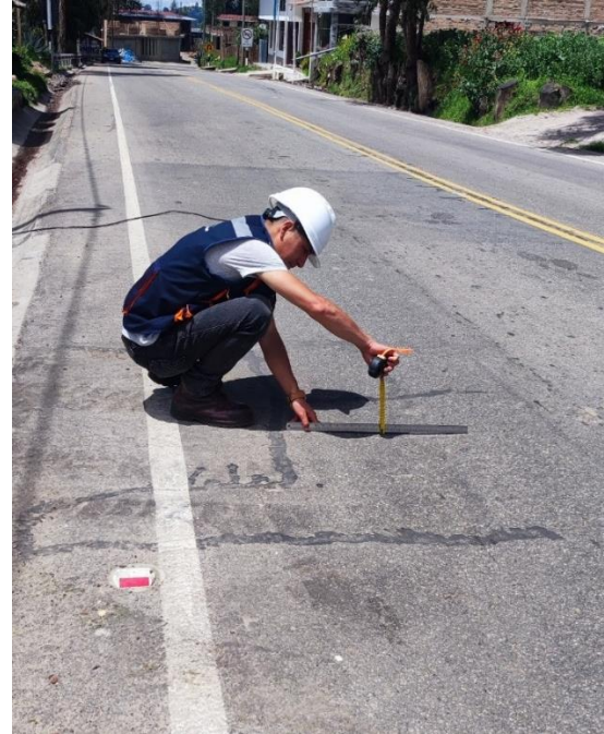
Fotografía 46: Deterioro superficial tipo Ahuellamiento (AH) en el Km: 13+000.00 - 14+000.00
