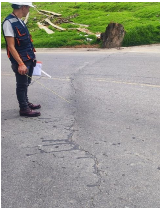
Fotografía 23: Deterioro superficial progresiva Km: 9+900.00 - 10+000.00 carril derecho fisura transversal de junta de construcción FTJ M-40
