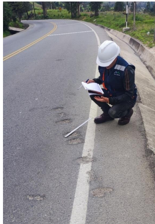
Fotografía 20: Medición de deterioro superficial en el carril derecho de la progresiva Km: 8+300.00 - 8+400.00 Ojo de pescado (O) M-24
