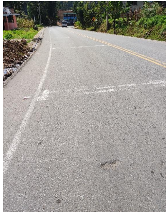
Fotografía 12: Deterioro superficial del carril izquierdo en la progresiva Km: 6+700.00 - 6+800.00 deterioro Pérdida de la película ligante (PL) M-8
