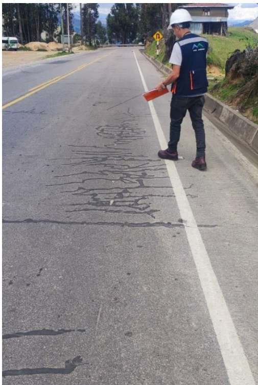
Fotografía 43: Deterioro superficial tipo fisuración piel de cocodrilo (FPC) en el Km: 12+000.00 - 13+000.00
