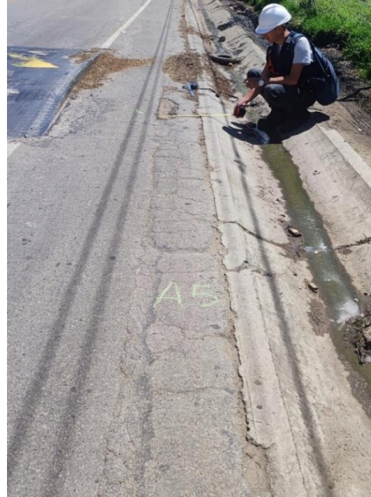
Fotografía 30: Deterioro superficial en la progresiva Km: 11+100.00 - 11+200.00 Desintegración de los bordes del pavimento DB M-52 carril derecho.
