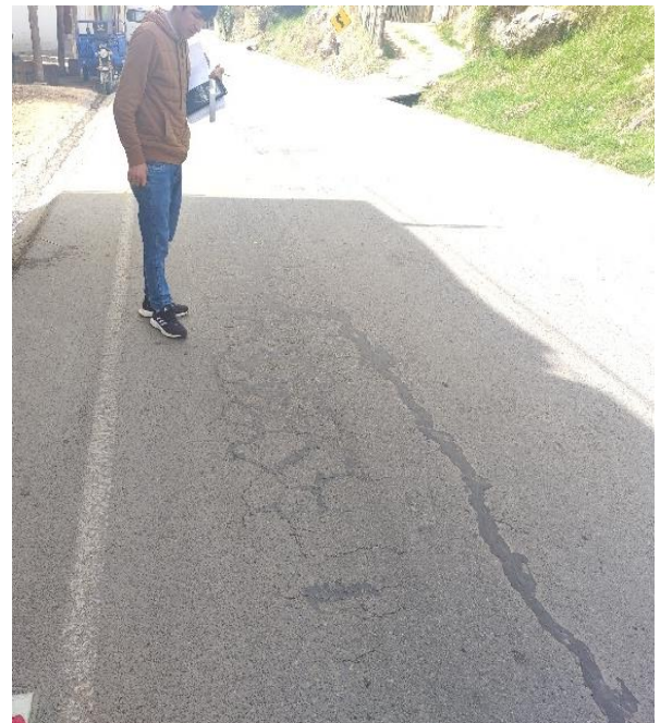
Fotografía 16: Deterioro superficial en el carril izquierdo de la progresiva Km: 7+800.00 - 7+900.00 deterioro Fisuras Piel de Cocodrilo (FPC) M-19
