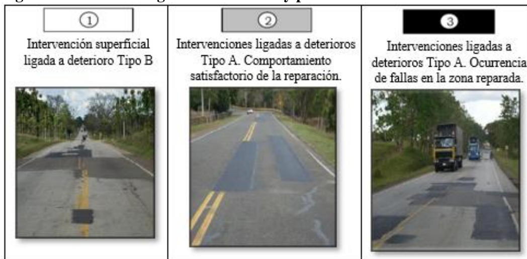
Figura 2. 7. Niveles de gravedad bacheos y parcheo
