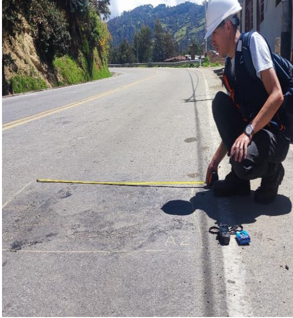
Fotografía 33: Medición de deterioro superficial del carril derecho en la progresiva Km: 12+200.00 - 12+300.00 deterioro Descascaramiento (D) M-63
