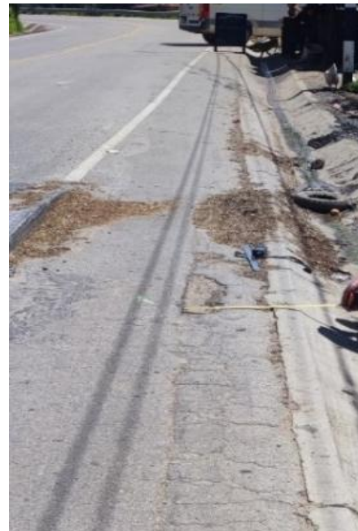
Fotografía 40: Deterioro superficial en la progresiva Km: 13+300.00 - 13+400.00 del carril izquierdo Desintegración de bordes del pavimento (DB) M-74.
