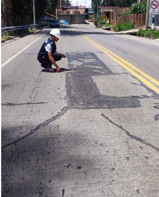
Fotografía 45: Deterioro superficial tipo bacheo y parcheo (B) en el Km: 13+000.00 - 14+000.00
