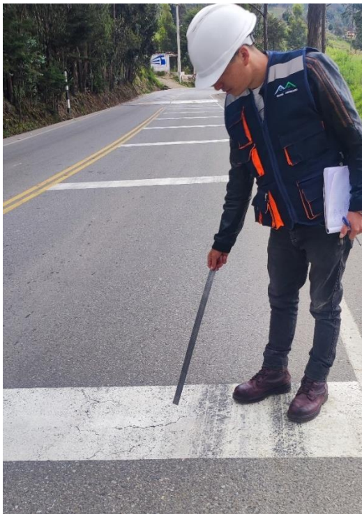
Fotografía 19: Deterioro superficial en el carril derecho de la progresiva Km: 8+500.00 - 8+600.00 deterioro Perdida de la película ligante (PL) M-26
