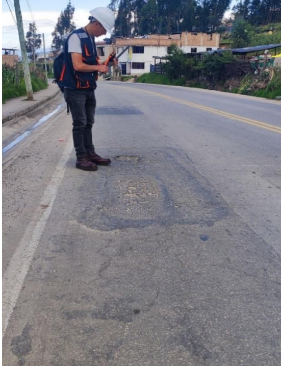
Fotografía 49: Deterioro superficial Fisuración piel de cocodrilo (FPC) y ojo de pez (O)
