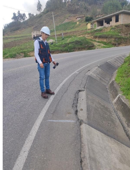
Fotografía 22: Deterioro superficial en la progresiva Km: 9+700.00 - 9+800.00 carril derecho desintegración de Bordes del Pavimento DB M-34
