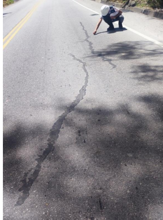
Fotografía 36: Deterioro superficial en el carril izquierdo de la progresiva Km: 12+800.00 - 12+900.00 deterioro perdida de la película ligante (PL)
