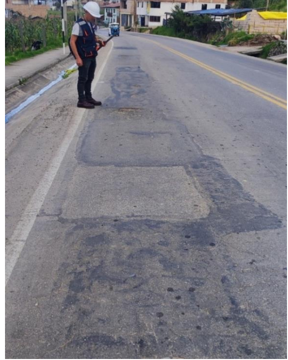
Fotografía 50: Deterioro superficial de tipo Bacheos y parcheos (B)
