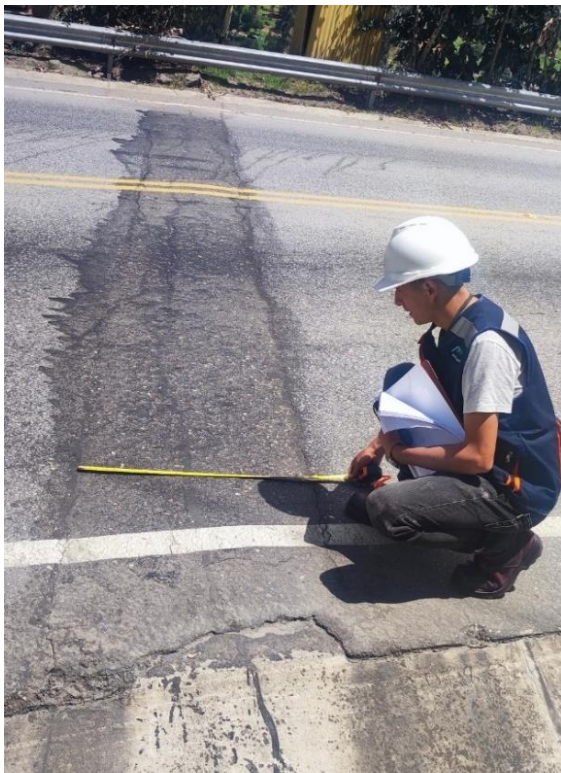
Fotografía 31: Medición de deterioro superficial en la progresiva Km: 11+800.00 - 11+900.00 deterioro Bacheos y parcheo (B) m-59
