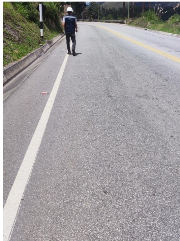
Fotografía 32: Deterioro superficial en la progresiva Km: 11+200.00 - 11+300.00 deterioro Perdida de la película ligante PL M-53
