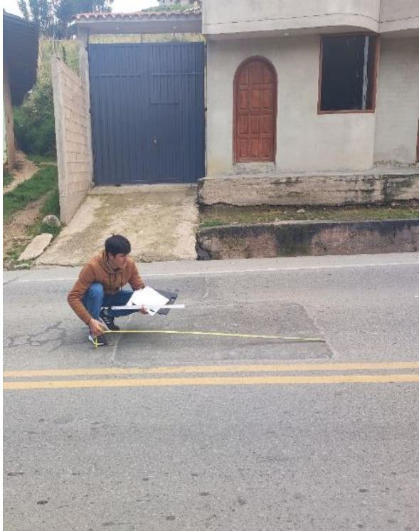
Fotografía 17: Deterioro superficial del carril izquierdo en la progresiva Km: 8+200.00 - 8+300.00 deterioro Bacheos y parcheo (B) M-23.
