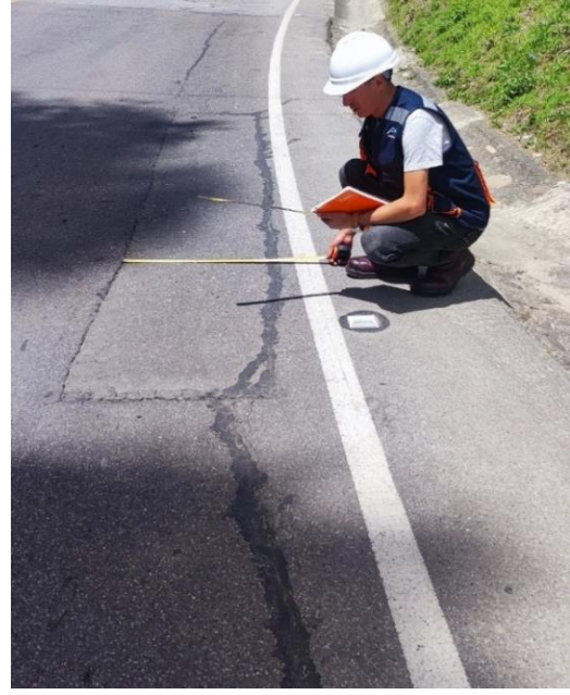
Fotografía 34: Medición de deterioro superficial en el carril izquierdo en la progresiva Km: 12+000.00 - 12+100.00 deterioro Bacheos y parcheo (B) M-61
