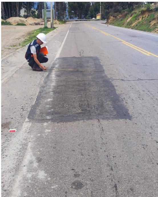
Fotografía 27: Deterioro superficial en el carril izquierdo en la progresiva Km: 10+400.00 - 10+500.00 deterioro Bacheos y parcheo (B) M-45
