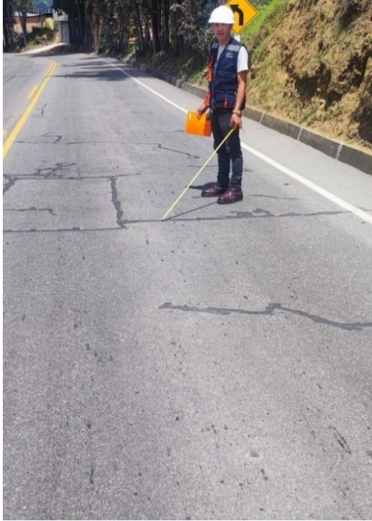
Fotografía 41: Deterioro superficial fisura transversal por fatiga (FTF) y fisura longitudinal por fatiga (FLF) en el Km: 12+000.00 - 13+000.00
