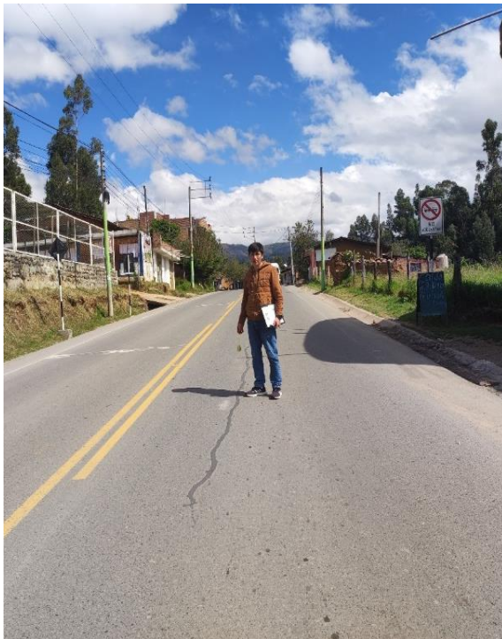
Fotografía 11: Medición de deterioro superficial en la progresiva Km: 6+900.00 - 7+000.00 del carril izquierdo fisuración longitudinal por fatiga M-10
