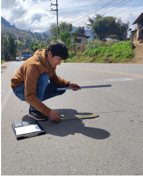
Fotografía 9: Medición de deterioro superficial en el carril derecho de la progresiva Km: 6+000.00 - 6+100.00 deterioro Ahuellamiento (AH), M-1
