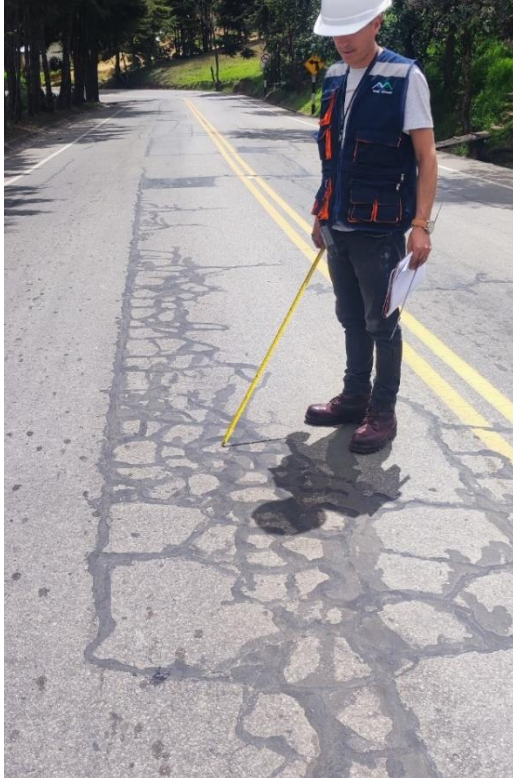
Fotografía 25: Deterioro superficial en la progresiva Km: 10+100.00 - 10+200.00 deterioro Fisuras piel de cocodrilo FPC M-42
