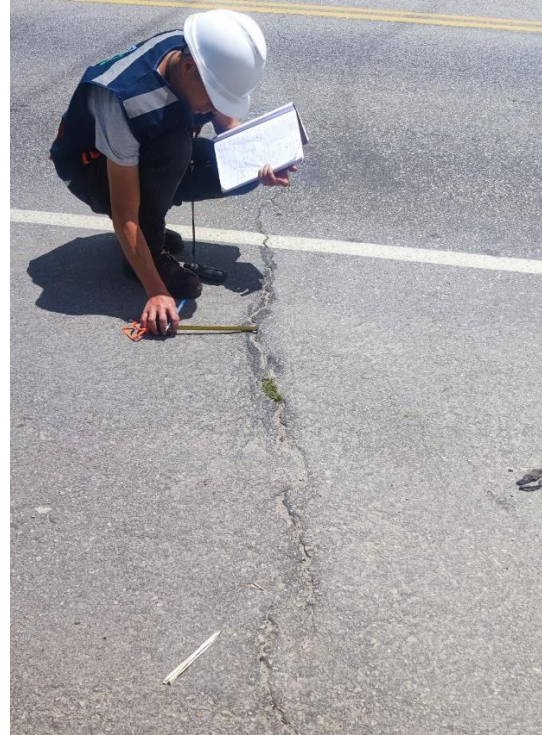
Fotografía 54: Deterioro superficial de tipo Fisura transversal por fatiga (FTF)
