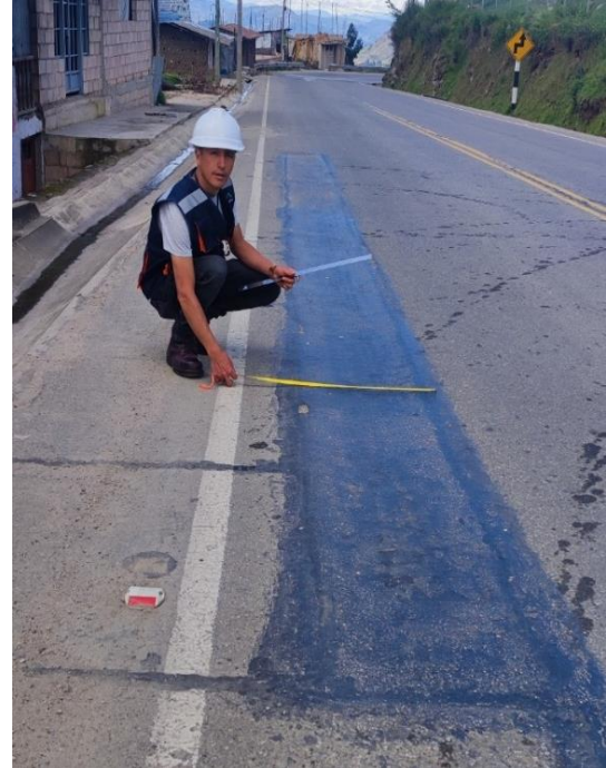
Fotografía 38: Deterioro superficial en la progresiva Km: 13+600.00 - 3+700.00 carril derecho fisura longitudinal de junta de construcción (FLJ) M-77.
