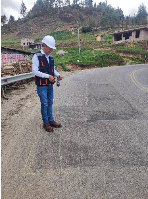
Fotografía 21: Deterioro superficial en la progresiva Km: 9+300.00 - 9+400.00 carril izquierdo bacheos y parcheos B M-34
