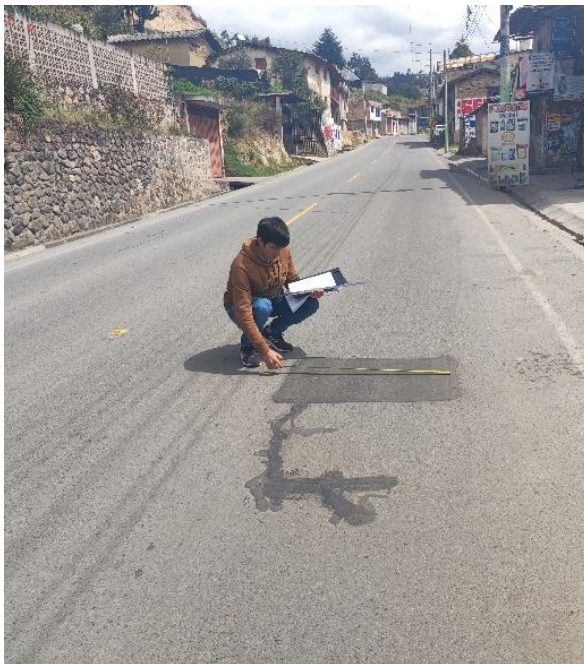
Fotografía 15: Medición de deterioro superficial en el carril izquierdo de la progresiva Km: 7+600.00 - 7+700.00 deterioro bacheos y parcheos (B) M-17
