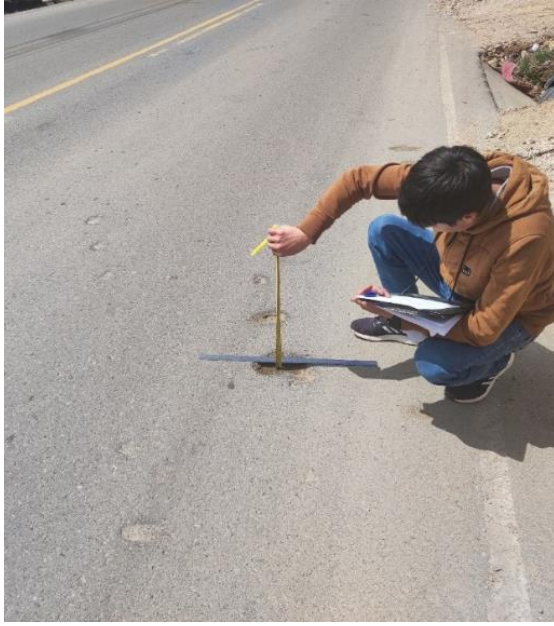
Fotografía 13: Medición de deterioro superficial en el carril derecho de la progresiva Km: 7+200.00 - 7+300.00 deterioro Ojo de pescado (O) M-13
