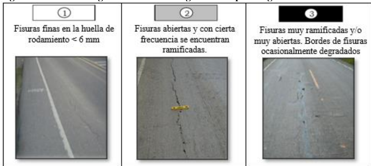
Figura 2. 5. Niveles de gravedad fisuras longitudinales por fatiga
