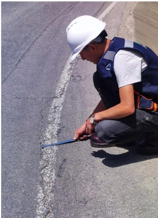
Fotografía 39: Deterioro superficial en la progresiva Km: 13+300.00 - 13+400.00 del carril izquierdo fisura longitudinal por fatiga M-74
