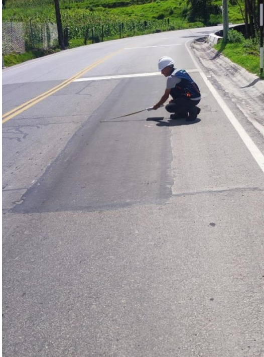
Fotografía 29: Medición deterioro superficial del carril derecho en la progresiva Km: 11+600.00 - 11+700.00 deterioro Bacheos y parcheo (B) M-57
