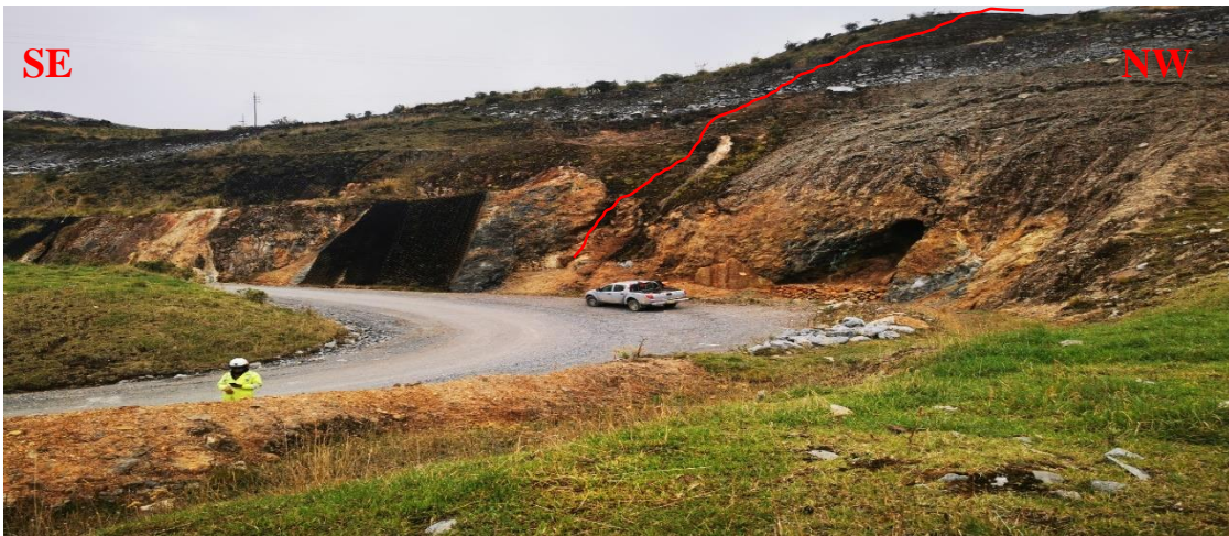
Figura 10. Fuerzas gravitatorias lo cual ayuda a derrumbes en la zona, con coordenadas E: 761062, N: 9253453.
