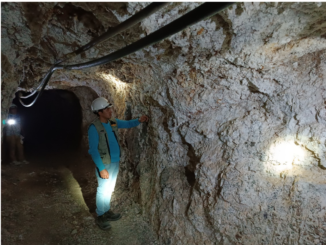
Foto 2. By-pass afectado por la humedad, formando recristalización de minerales hidratados en la sección subterránea desde PIp. + 55 m. a PIp. + 159 m.; ubicados en techo y hastiales.
