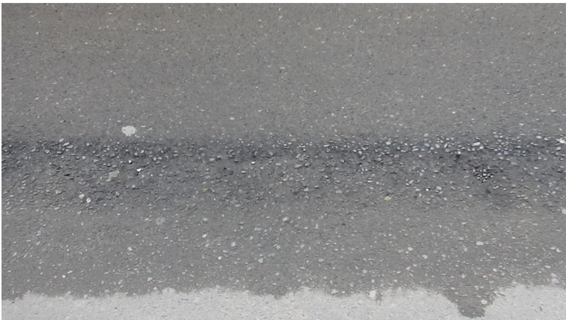
Figura 34: Desprendimiento del sello de la superficie
