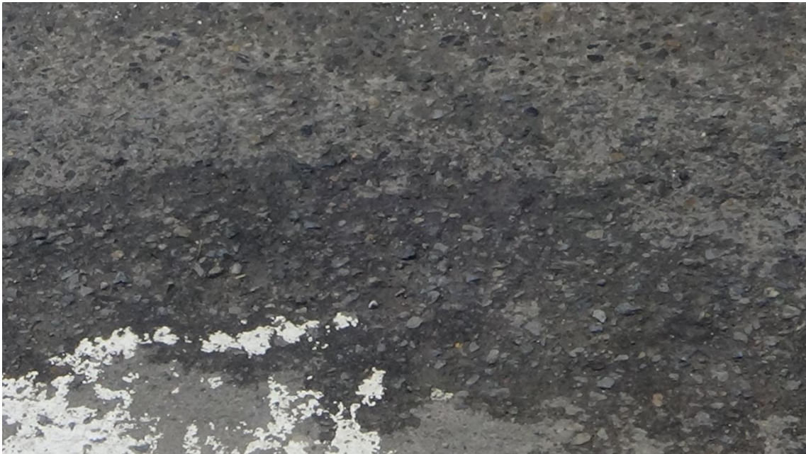
Figura 35: Pérdida de textura superficial
