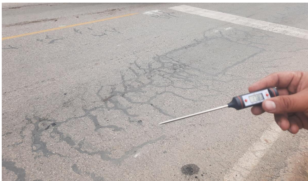
Figura 32: Fisuración por Fatiga
