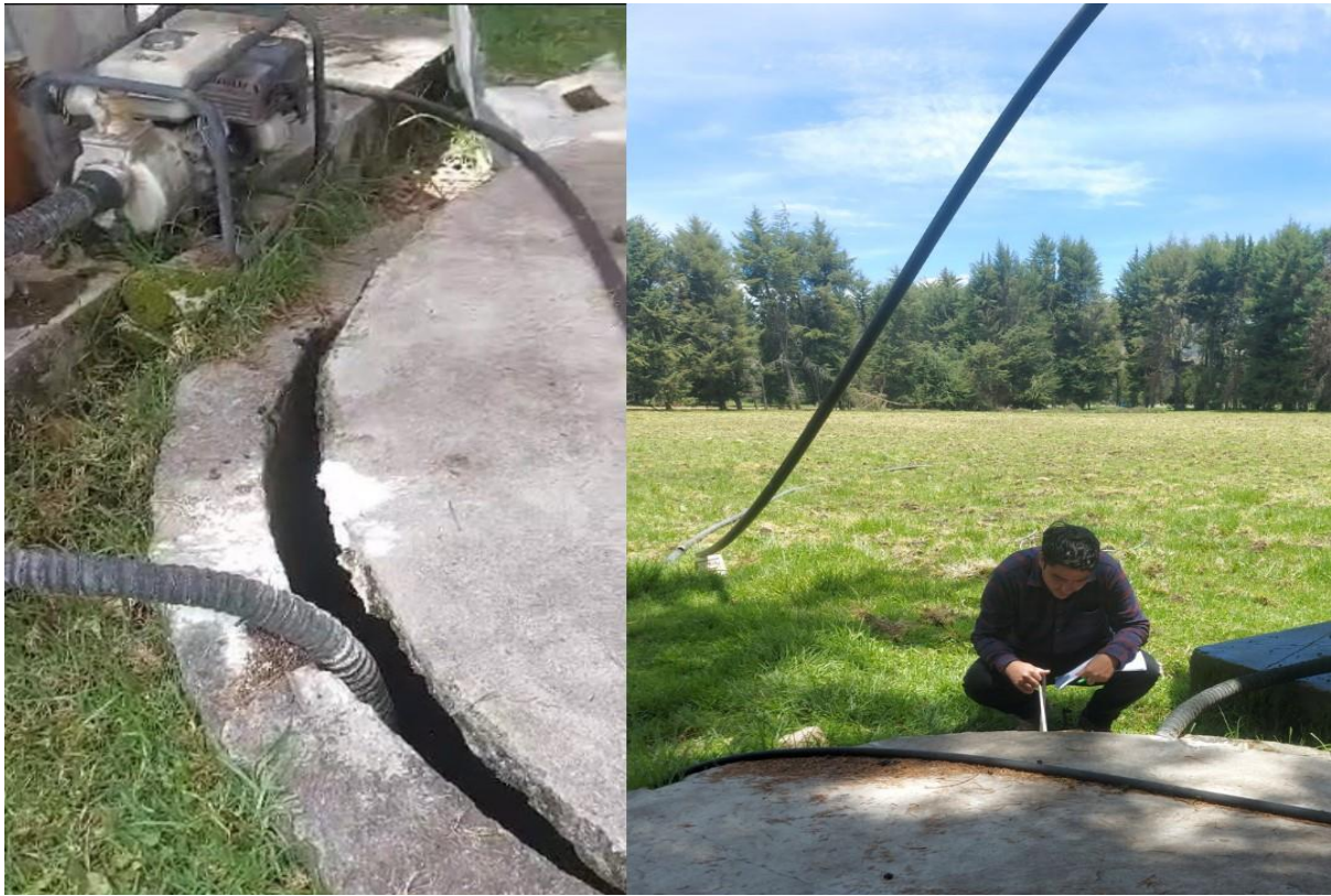
Figura 51: Prueba de bombeo, izquierda motobomba de 2.2 lt/s, derecha tomando las medidas del nivel freático. (01/08/2023)
