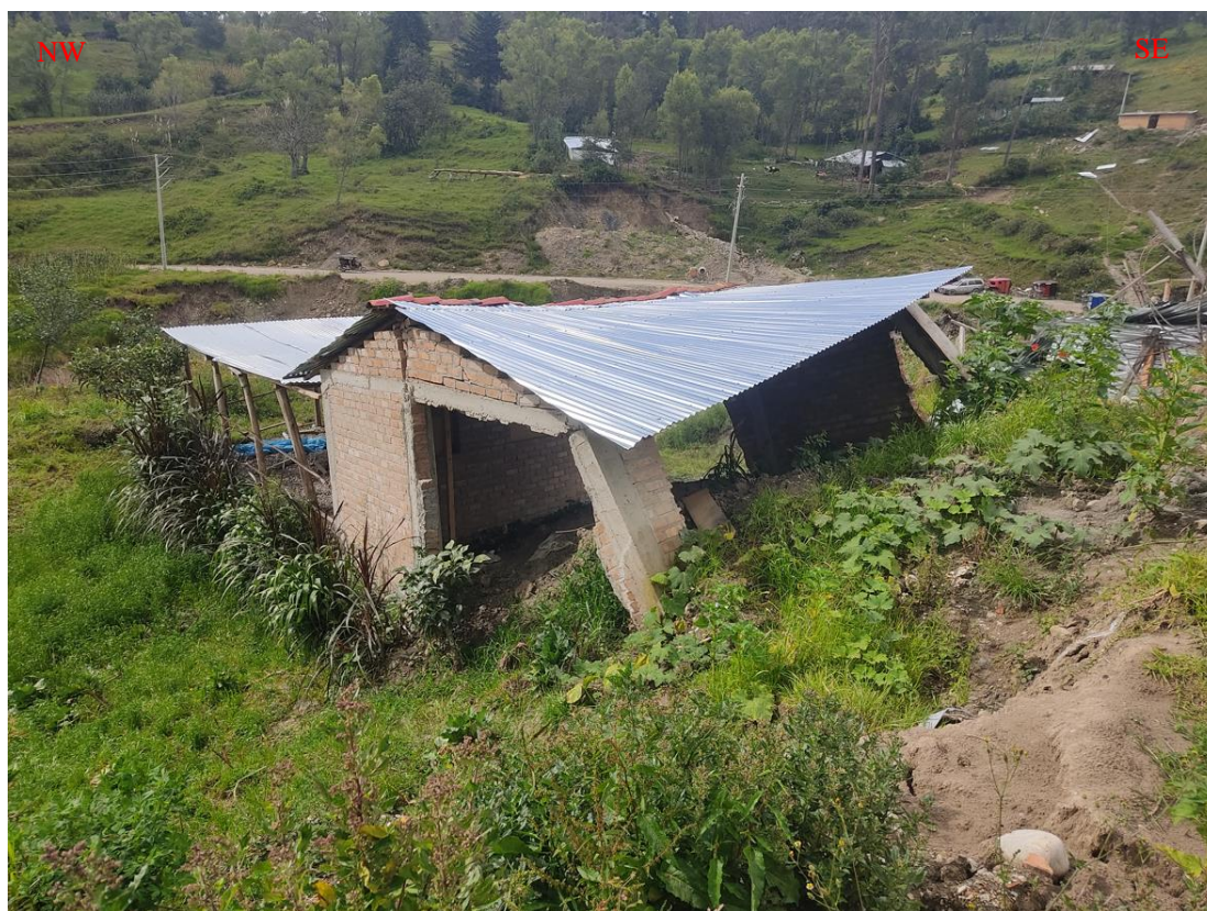
Foto N°: 29: Vivienda completamente destruida a causa del deslizamiento Coordenadas: E: 761403.98 N: 9273801.52 C: 2466 m.s.n.m.
