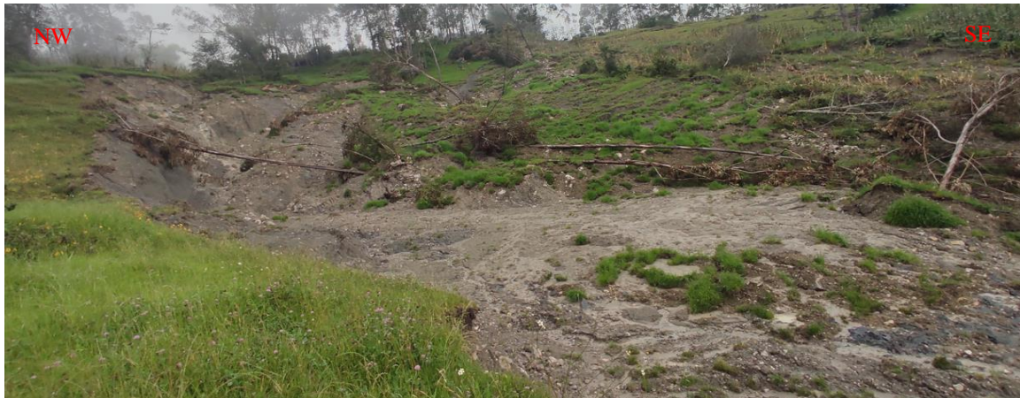
Foto N°: 28: Vista del material deslizado Coordenadas: E: 761748.67 N: 9273657.01 C: 2505 m.s.n.m.
