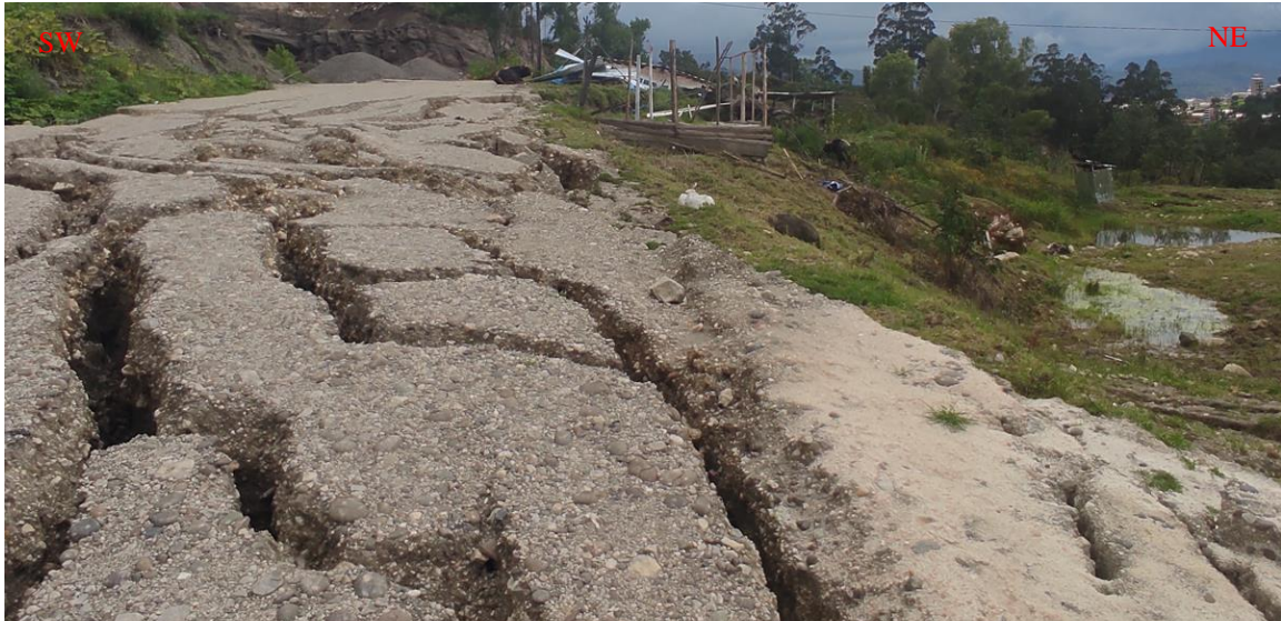
Foto N°: 27: Grietas observadas en el momento que ocurrió el deslizamiento Coordenadas: E: 761437.28 N: 9273784.92 C: 2490 m.s.n.m.
