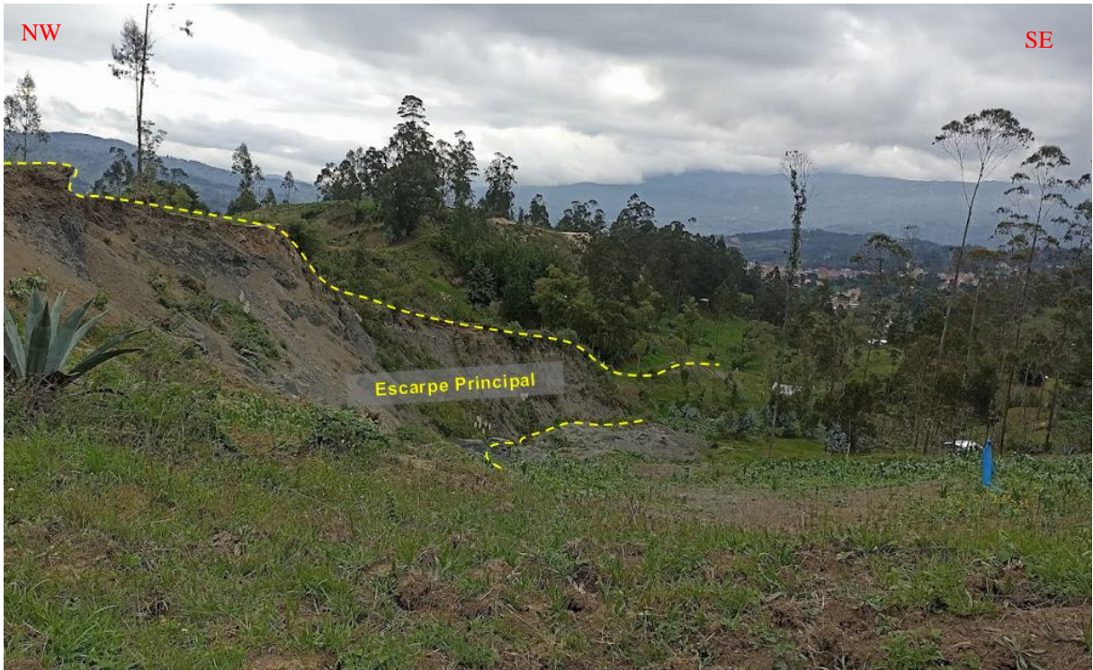
Foto N°: 21: vista al SO del deslizamiento Coordenadas: E: 761837.34 N: 9273360.48 C: 2445 m.s.n.m.
