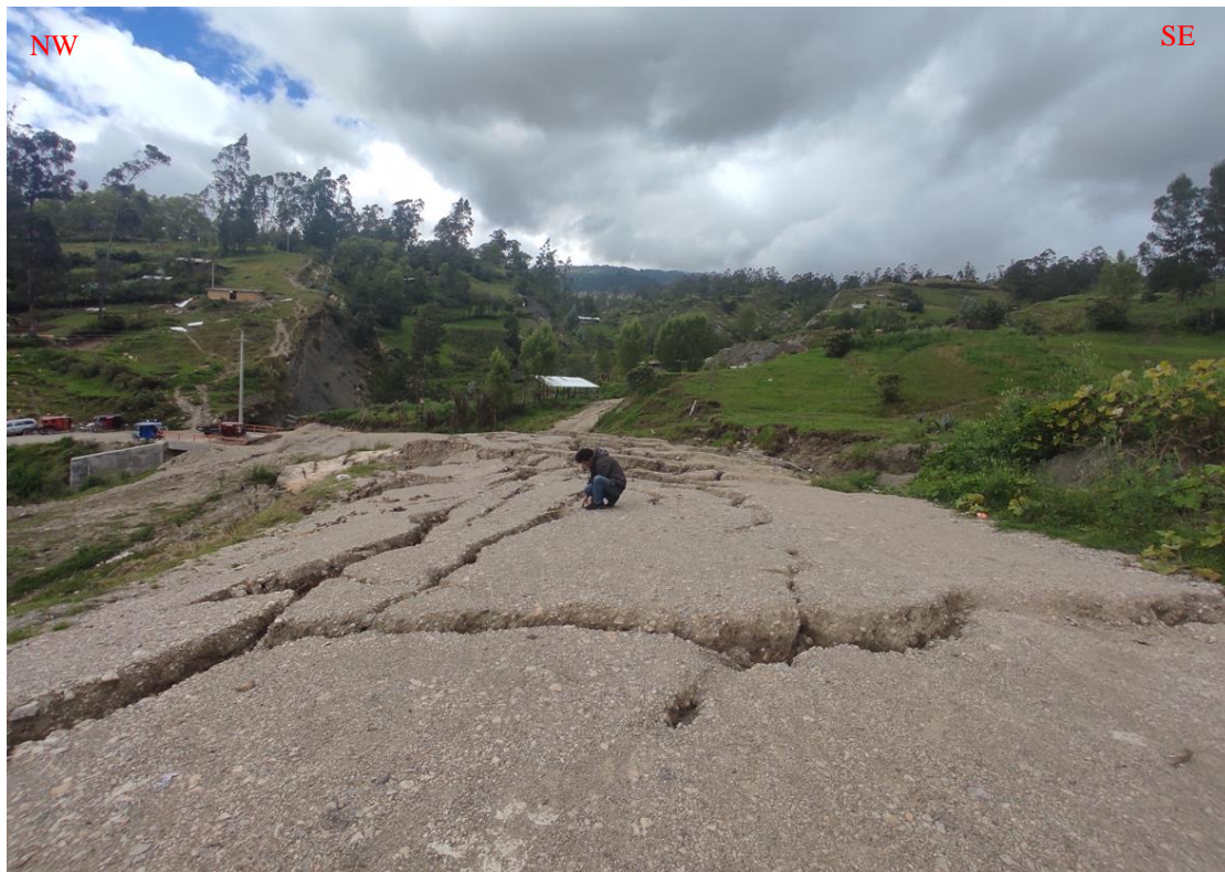
Foto N°: 31: Tramo de la carretera afectado Coordenadas: E: 761427.02 N: 9273780.77 C: 2470 m.s.n.m.
