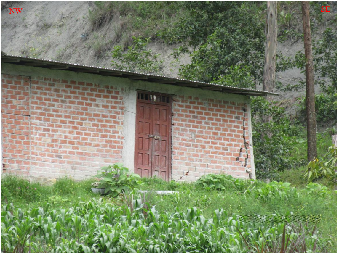
Foto N°: 32: Fracturas en las casas en el deslizamiento Coordenadas: E: 761788.14 N: 9273631.17 C: 2515 m.s.n.m.
