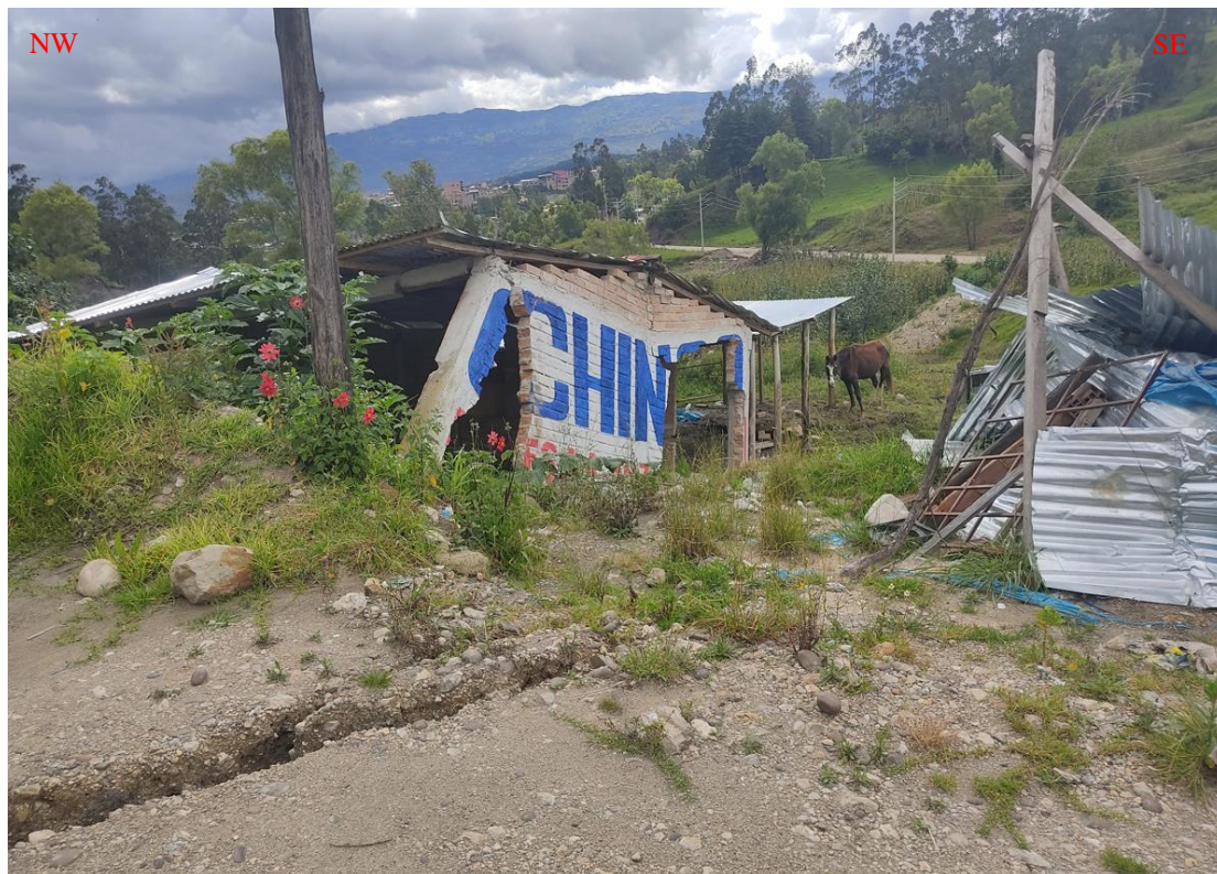
Foto N°: 30: Vivienda inhabitable a causa del deslizamiento Coordenadas: E: 761455.45 N: 9273813.06 C: 2470 m.s.n.m.
