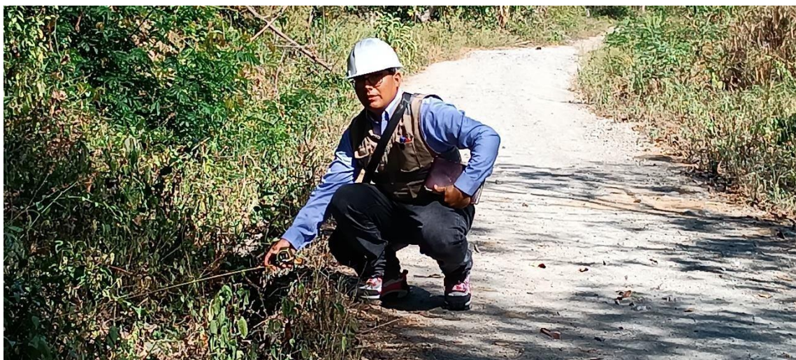
Foto 3: Tomando medidas en la progresiva 00+240.00 Km, de la sección típica de la carretera Cruce El Muyo, Caserío Yucarica, El Puquio, distrito de Chirinos, Provincia de San Ignacio – Cajamarca.
